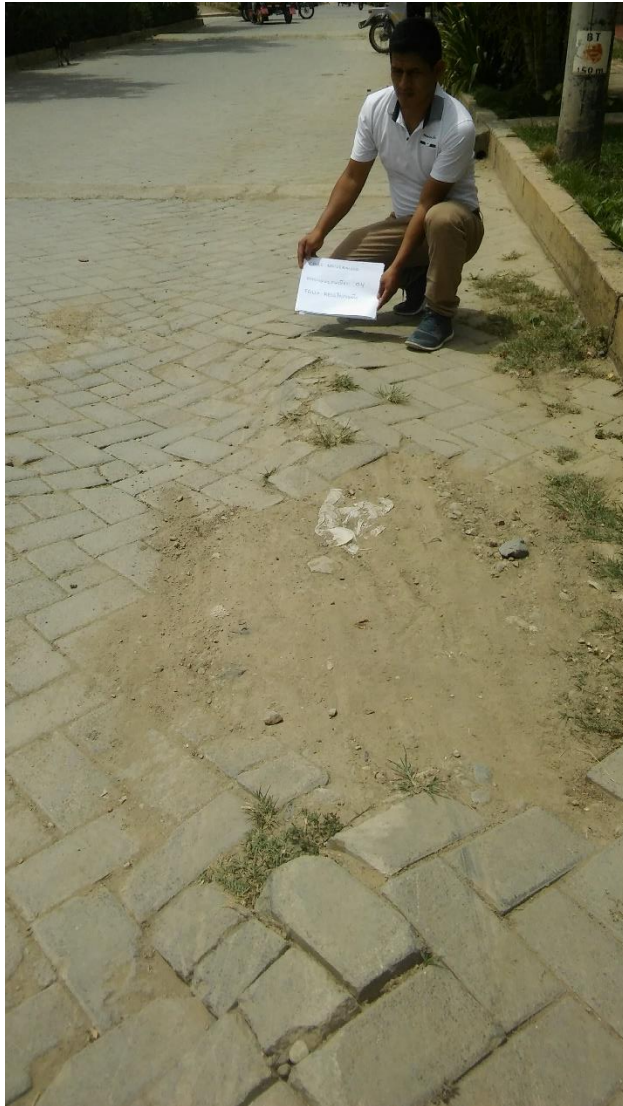
FOTO 03: Abultamiento en la Calle Santa Teresita
