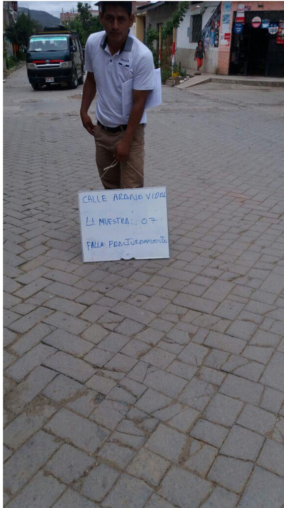
FOTO 07: Fracturamiento en la Calle Arana Vidal
