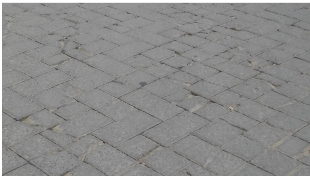
FOTO 05: Fracturamiento en la Calle Raymondi
