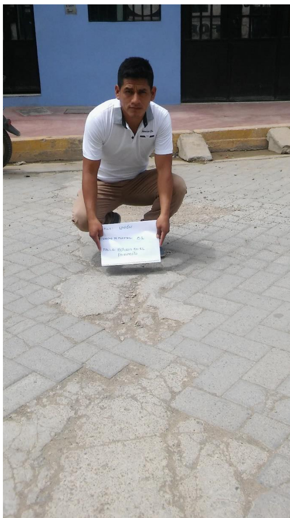
FOTO 06: Roturas en el Pavimento mal Reparadas en la Calle Unión
