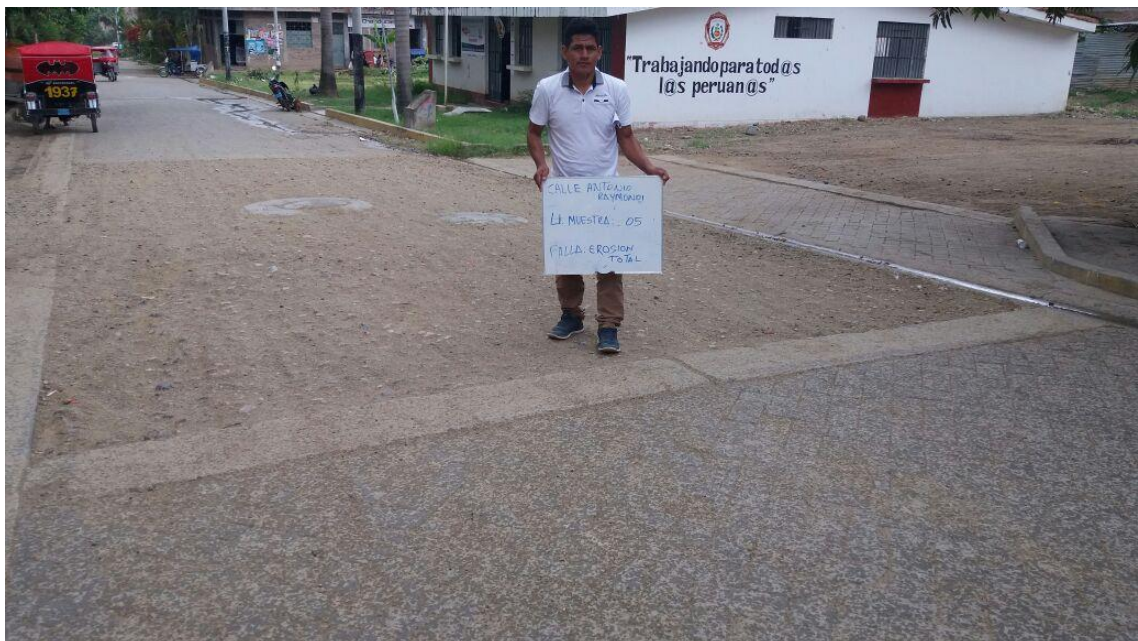
FOTO 08: Erosión Total del Pavimento en la Calle Raymondi
