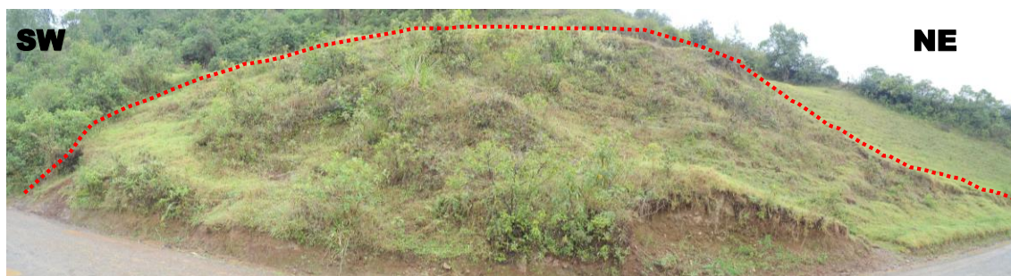
Foto N° 3: Reptación de suelo areno-limoso en la progresiva 1+570 - 1+670
