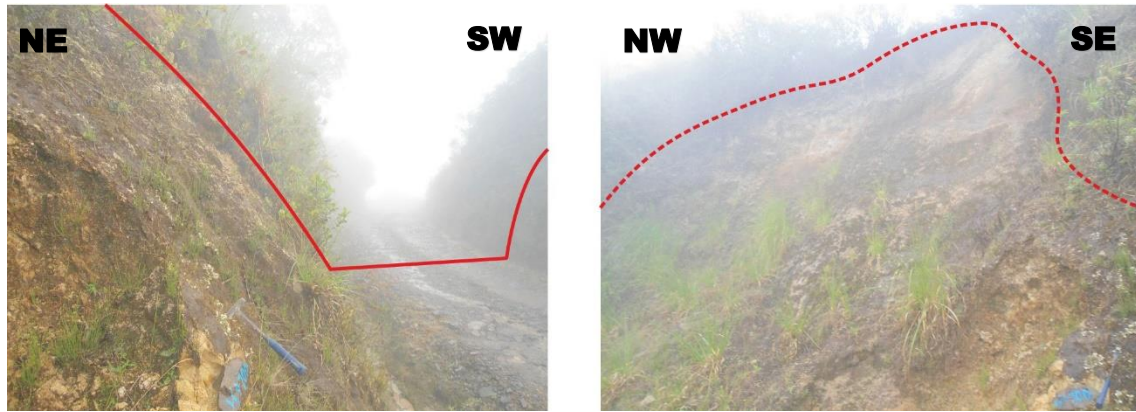
Foto N° 7: Deslizamiento antiguo de unos 13m de ancho por 12m altura en la progresiva Km 4+100 - 4+120
