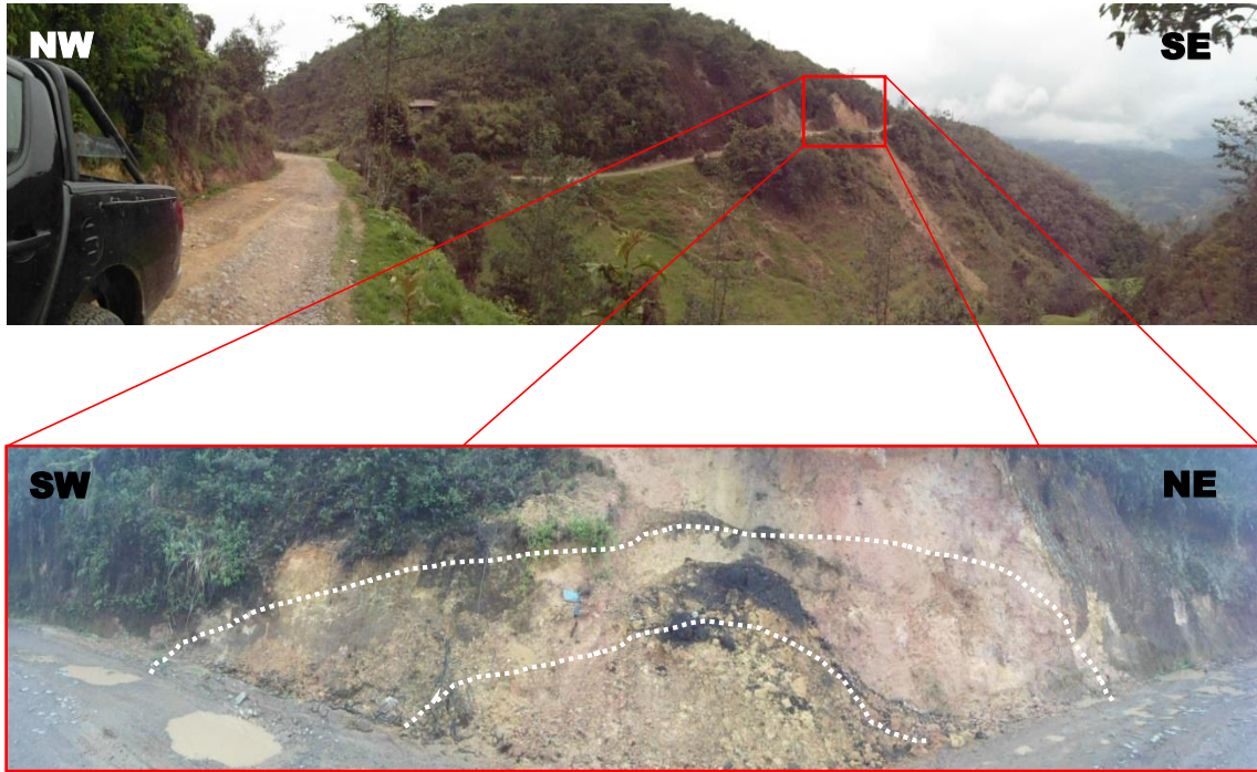
Foto N° 10: Vista panorámica de la zona más crítica de todo el tramo de la carretera donde se aprecia un deslizamiento rotacional en el Km 6+475 - 6+518.
