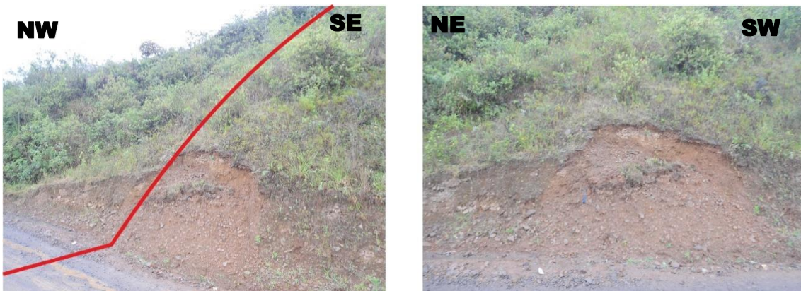
Foto N° 4: Talud inestable sobre deposito Coluvio-Aluvial en la progresiva Km 0+675 - 0+685.
