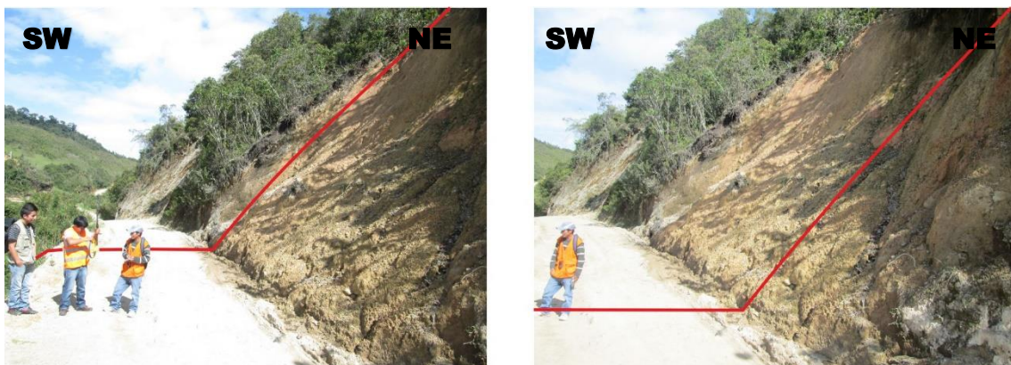
Foto N° 11: Roca volcánica andesítica alterada con talud inestable en la progresiva Km 6+475 - 6+518
