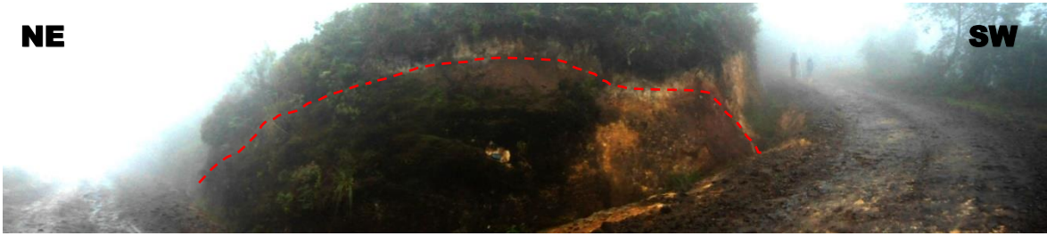
Foto N° 8: Deslizamiento de roca volcánica muy deleznable producto de la alteración en la progresiva Km 4+350 - 4+400
