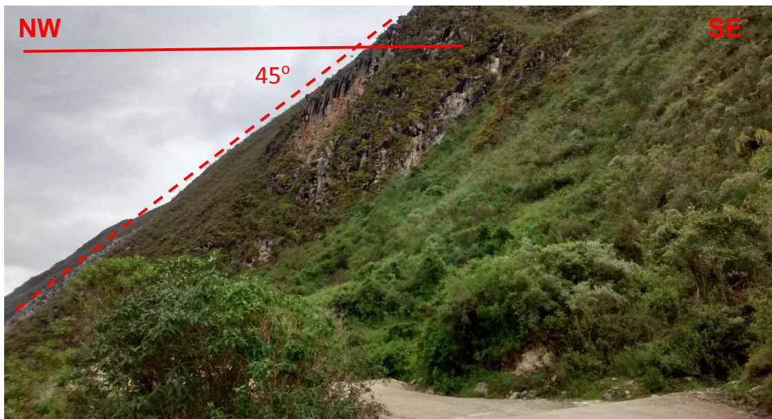
Figura 25: Laderas de 45° aproximadamente, este tipo de geomorfología se observa cerca al lecho de río Chonta, de Forma “V” características de los valles juveniles.
