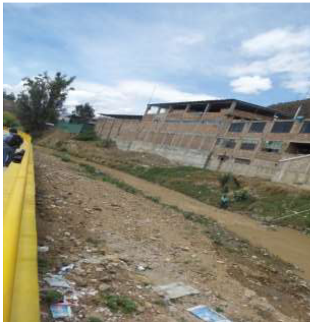
Figura N° 81. Estado del cauce del río Mashcón
