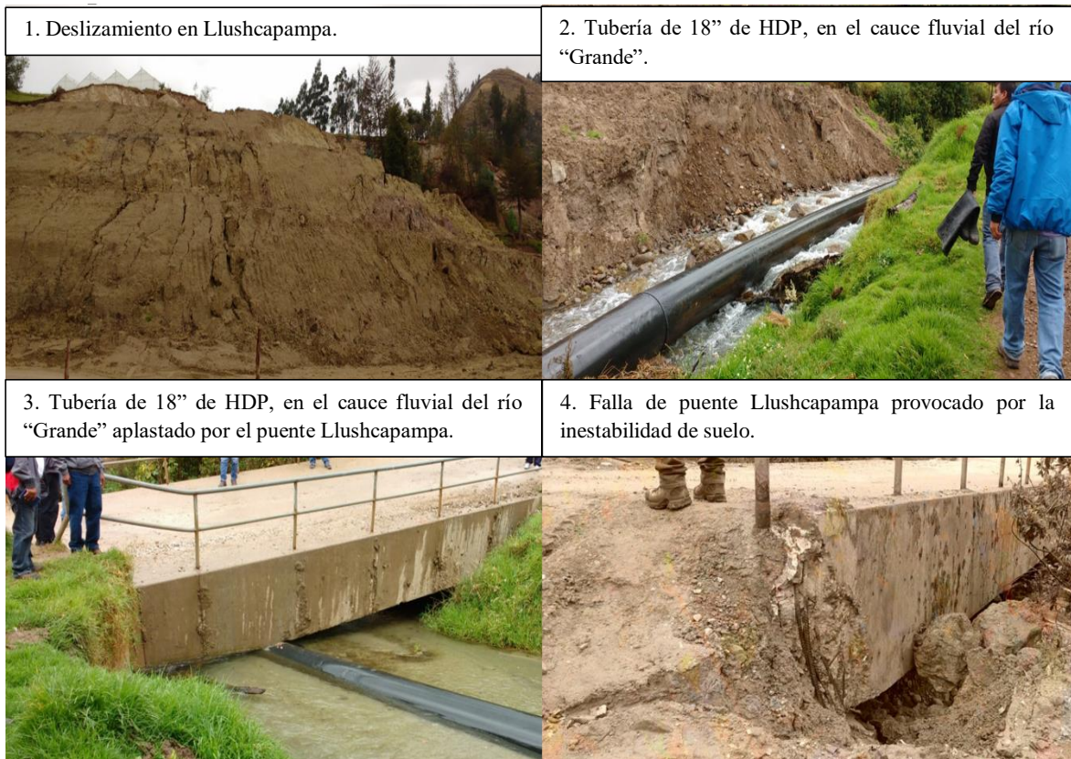
Figura 27. Deslizamiento en Llushcapampa, río "Grande". Visitada el 7/11/2017.
