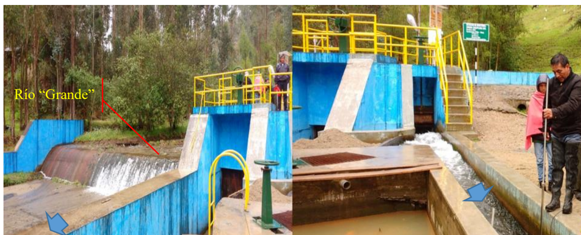
Figura 30. Captación “Río Grande” de la Eps Sedacaj S.A. Visitada el 7/11/2017
