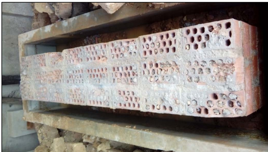
Figura N° 98: Hilera N° 05 del sobrecimiento, con las unidades de ladrillo y juntas de mortero totalmente secas.
