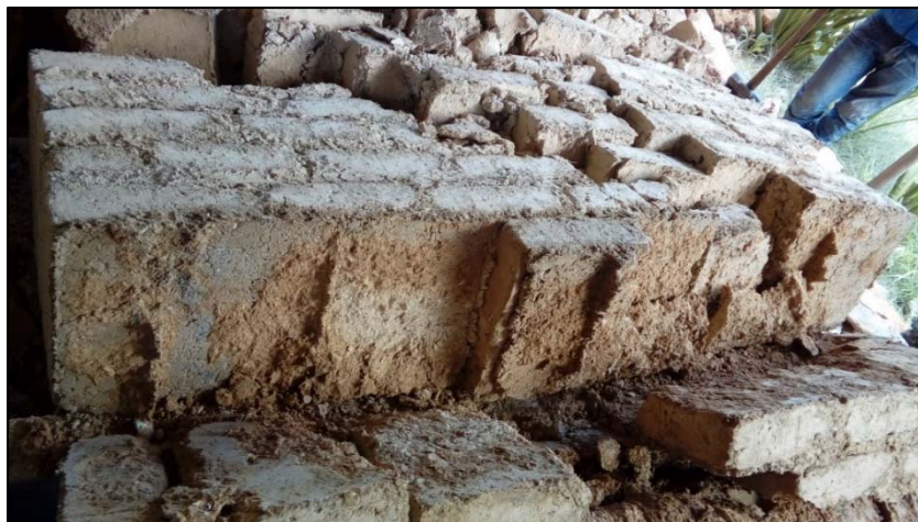
Figura N° 86: Muro ME después de haber caído manualmente.
