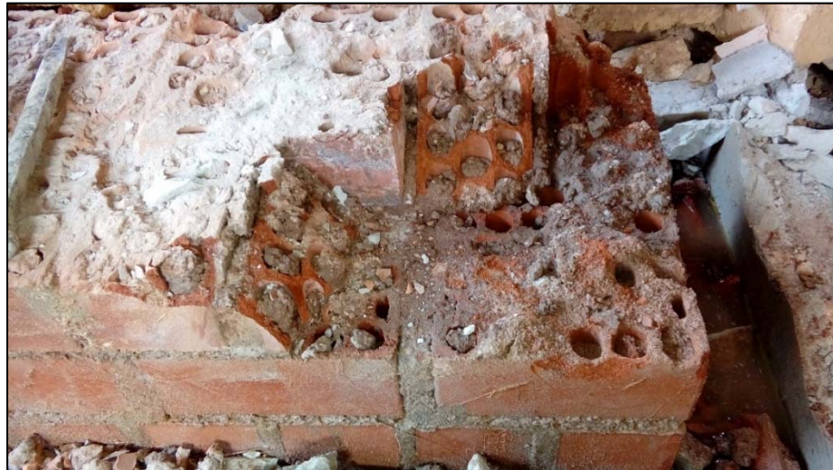
Figura N° 99: Ladrillos y juntas de la hilera N° 04 del sobrecimiento, parcialmente húmedas.
