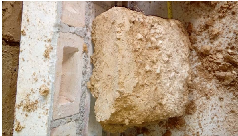
Figura N° 87: Unidad de adobe estabilizado de la Hilera N° 06 parcialmente saturada.
