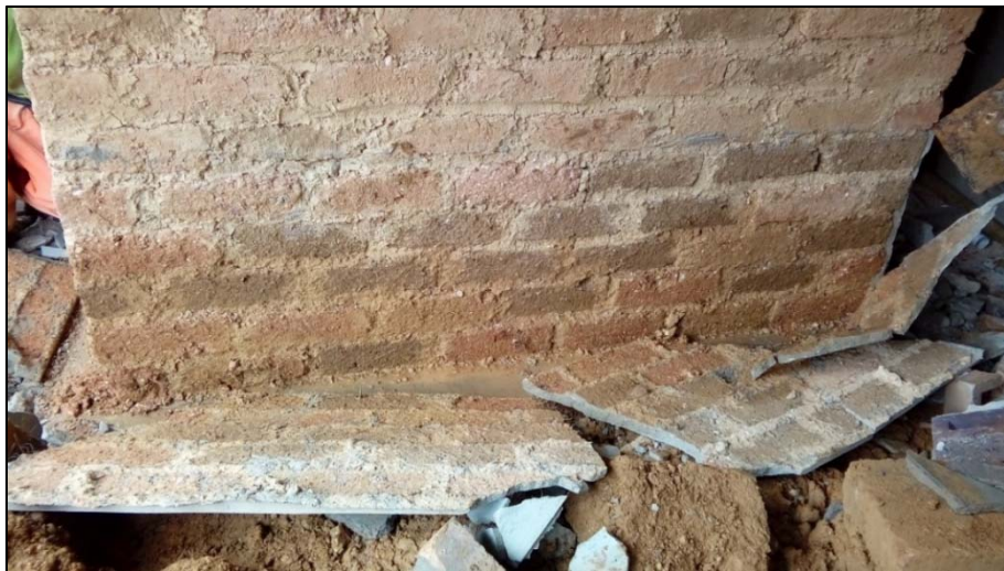
Figura N° 75: Muro MT, después de retirar el tarrajeo C:A y la malla de gallinero, notándose humedad en las primeras 04 hileras del muro.
