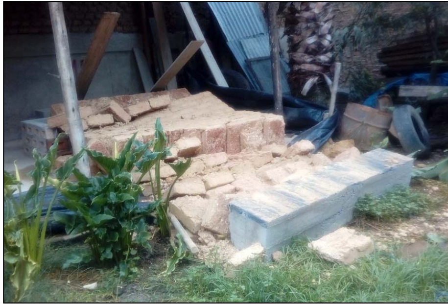
Figura N° 47: Muro Patrón MP colapsado por efecto de la inundación simulada.
