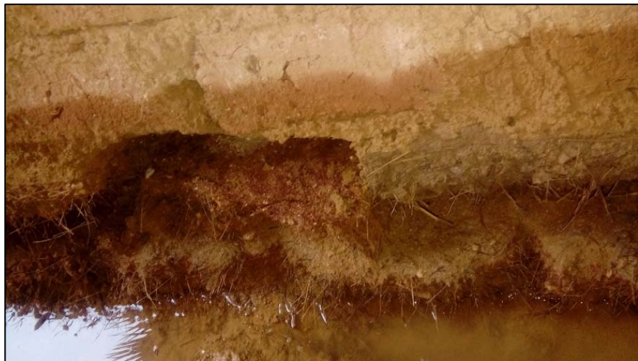
Figura N° 46: Junta de torta de barro saturado como plano de falla del Muro MP.
