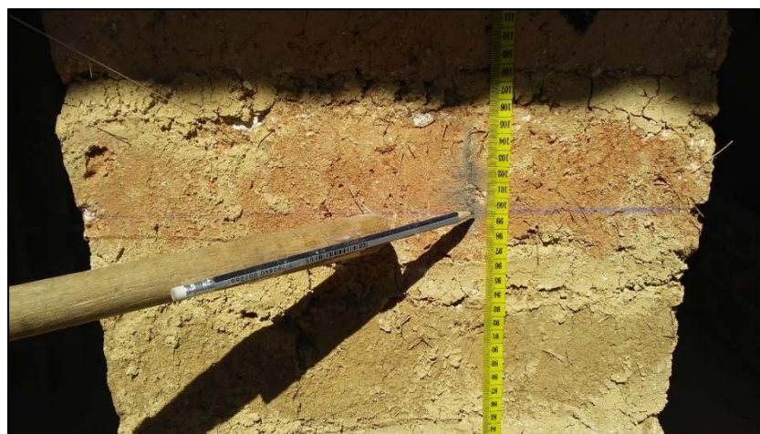
Figura 74: Nivel marcado en el Muro MT al finalizar el ensayo de inundación simulada para verificar asentamientos.
