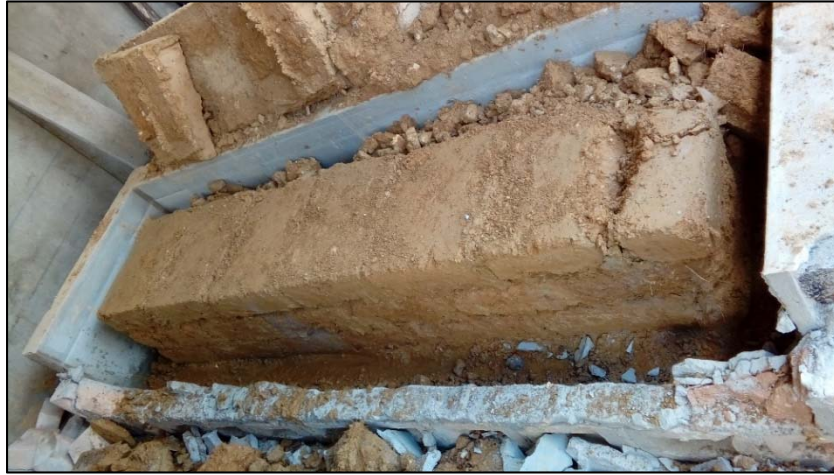
Figura N° 89: Hilera N° 01, 02 y 03 del muro estabilizado ME erosionadas por el agua.
