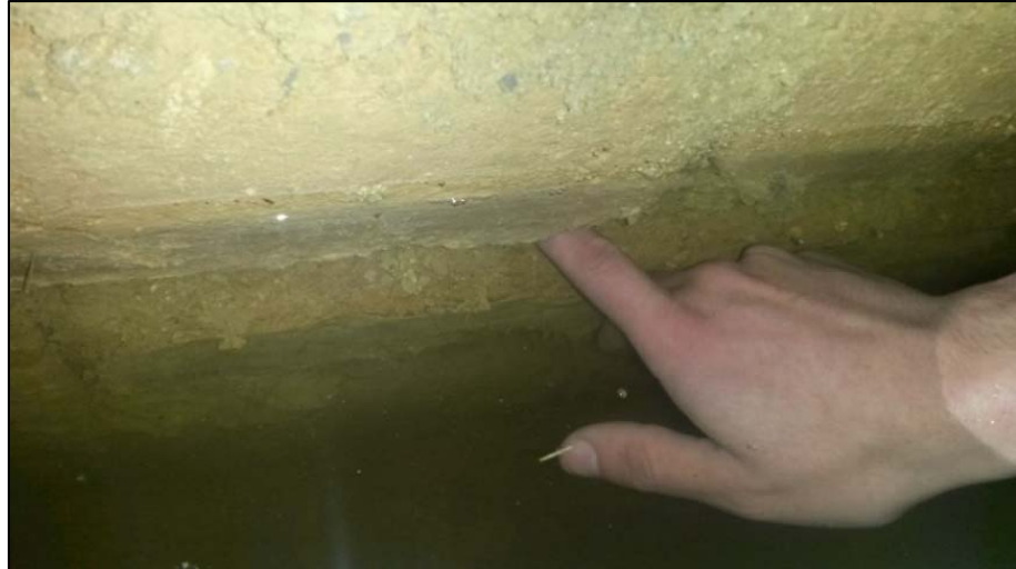
Figura N° 61: Juntas socavadas por el contacto con el agua.
