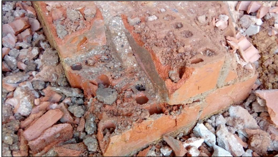
Figura N° 100: Hileras N° 02 y 03 del sobrecimiento de ladrillo, totalmente saturado con los huecos llenos de agua.
