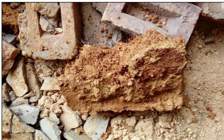
Figura N° 79: Adobe de la Hilera N° 02, saturado totalmente luego de ser retirado del muro MT.
