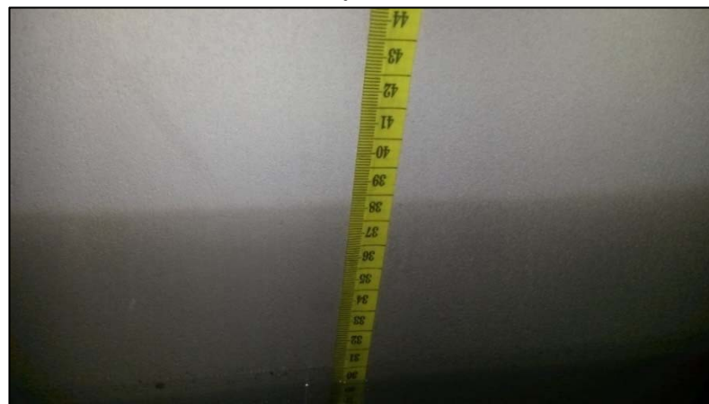
Figura N° 53: Lectura Día 02 (37.80) a las 18:45 de ascenso (Capilaridad) sobre el tarrajeo del Muro MT.
