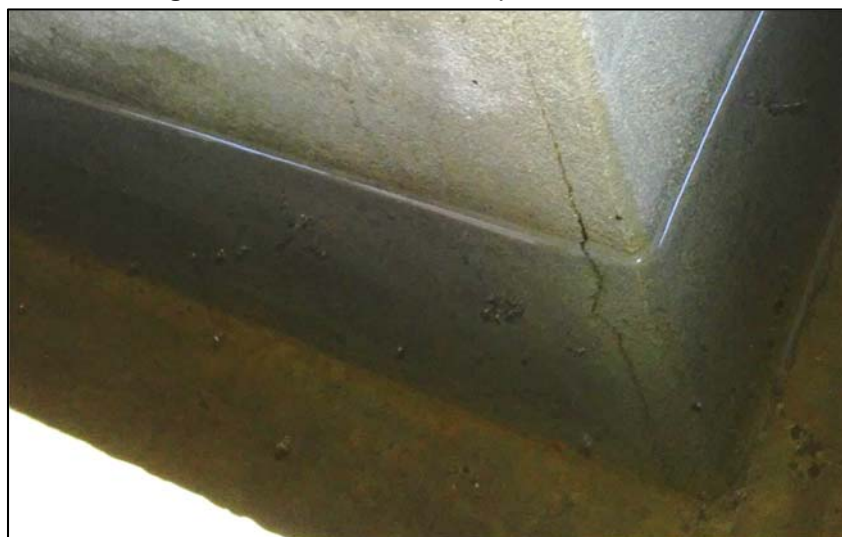
Figura N° 58: Fisura en la esquina del muro MT.
