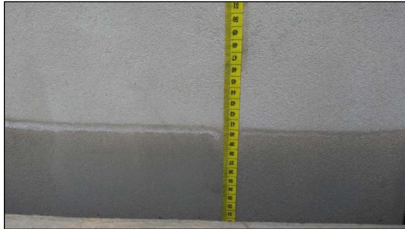
Figura N° 57: Presencia de eflorescencia durante el ascenso capilar.
