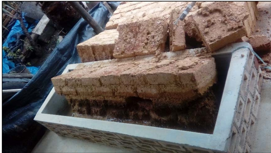
Figura N° 45: Muro MP colapsado debido a la saturación de adobes.
