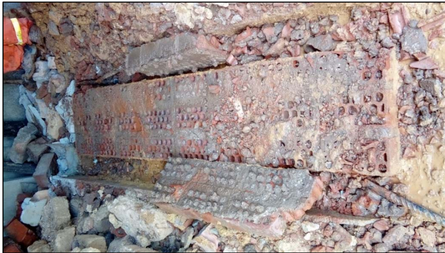
Figura N° 101: Hilera N° 01 del sobrecimiento de ladrillo, totalmente saturado con los huecos llenos de agua.
