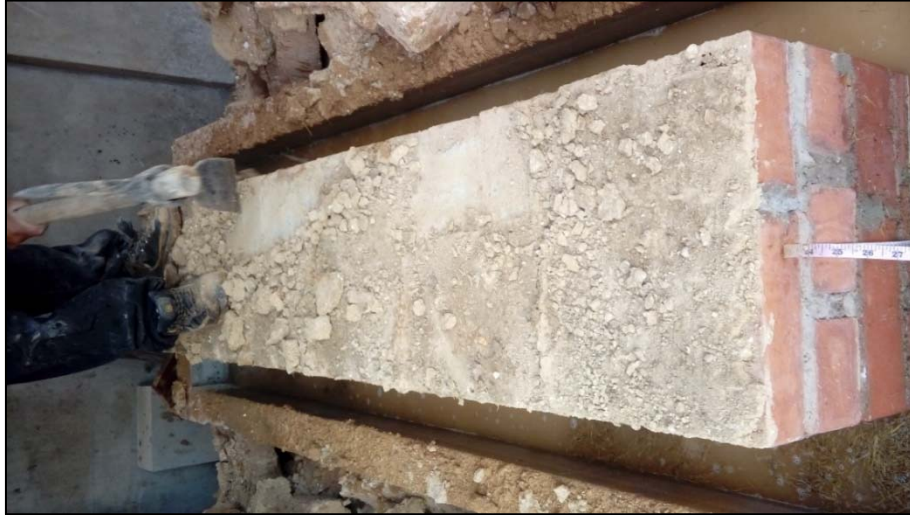
Figura N° 97: Junta ubicada encima del sobrecimiento de ladrillo totalmente seca.
