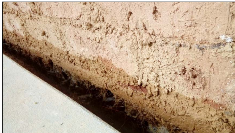
Figura N° 44: Disminución de la sección del muro MP - 3ra hilera (Hora 3:15 pm).
