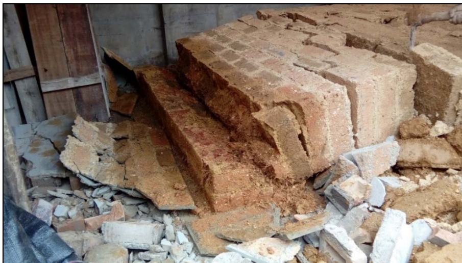
Figura N° 76: Muro MT colapsado después de haber retirado la capa de tarrajeo con malla de gallinero en la hilera N° 02.
