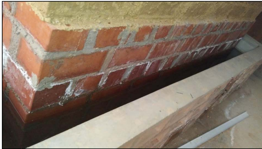
Figura N° 95: Muro ML al terminar el ensayo de Inundación Simulada. Nótese la eflorescencia sobre las juntas de mortero cemento arena.
