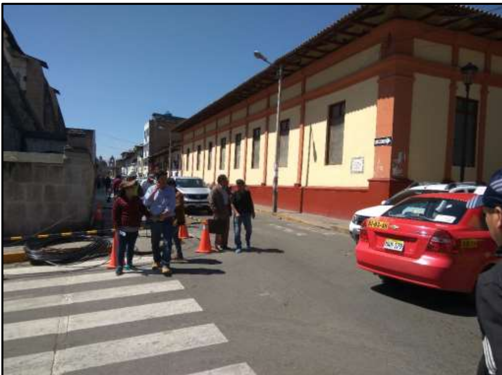
Fotografía N° 04: Se observa el congestionamiento vehicular y peatonal generado por trabajos eléctricos en Intersección semaforizada N° 01
