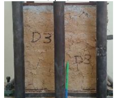
Foto 90 : Fallas que se presentan en el ensayo de las pilas de adobe (Tipo D)
