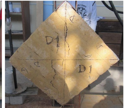
Foto 98 : Fallas diagonales que se presentan en el ensayo de los muretes de adobe (Tipo D)
