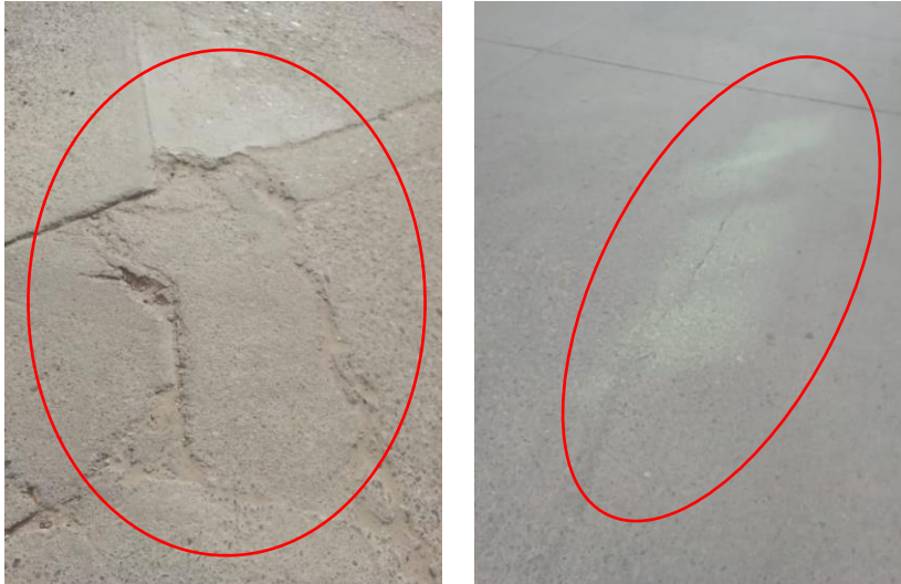
Figura 1.2: Fallas que presentan los pavimentos rígidos en nuestra ciudad.
