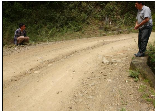
Foto 10: Alcantarilla TMC Ø 36", en regular estado y funcional (prog. 1+150 km).
