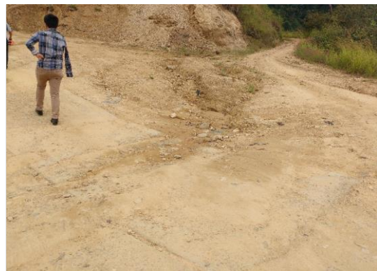
Foto 48: Desv. Vista Alegre y badén de concreto (4.00x6.00 m) en regular estado y funcional (prog. 06+310 km).
