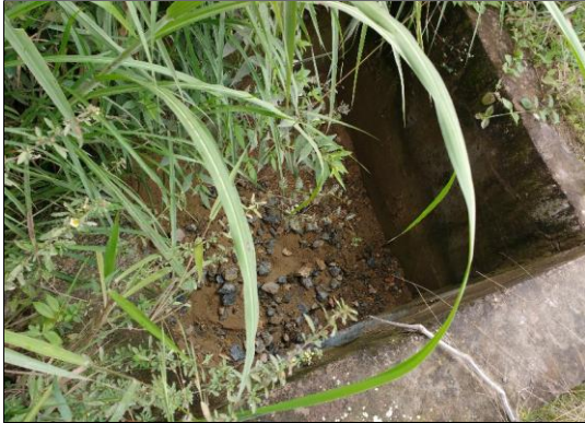
Foto 37: Cabezal de entrada de aliviadero TMC Ø 36", en regular estado y semi colmatado (prog. 04+935 km).
