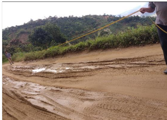
Foto 58: Falla tipo lodazal (prog. 7+440 km)
