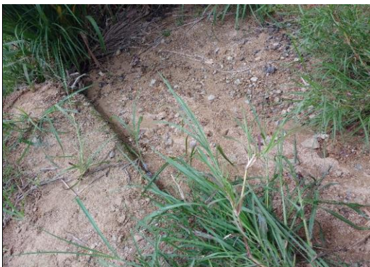
Foto 41: Cabezal de entrada de aliviadero TMC Ø 36", en mal estado y colmatado (prog. 05+640 km).
