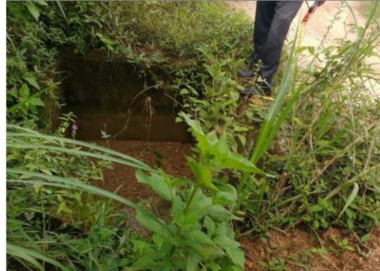
Foto 32: Cabezal de entrada de alcantarilla TMC Ø 36", en regular estado y semicolmatado (prog. 04+325 km).
