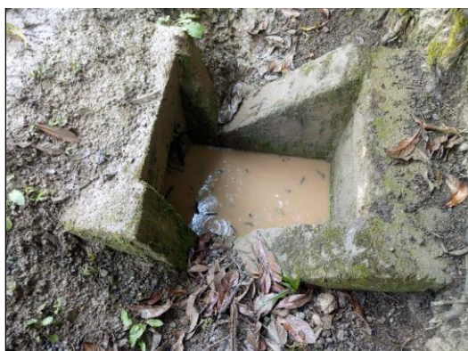
Foto 05: Alcantarilla TMC Ø12" cabezal de entrada, en buen estado y funcional (0+510 km)
