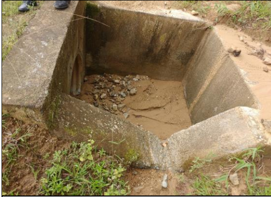
Foto 43: Cabezal de entrada de aliviadero TMC Ø 36", en regular estado y semi colmatado (prog. 05+840 km).
