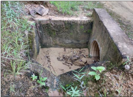
Foto 45: Cabezal de entrada de aliviadero TMC Ø 36", en regular estado y semi colmatado (prog. 05+970 km).
