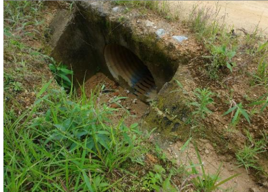
Foto 50: Cabezal de entrada de aliviadero TMC Ø 36", en regular estado y funcional (prog. 06+490 km).
