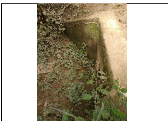
Foto 05: Cabezal de salida de alcantarilla TMC Ø 36", en regular estado y semicolmatada (prog. 0+730 km).
