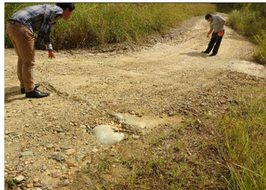
Foto 28: Baden de concreto (6.00x6.00 m) en regular estado y semicolmatado (prog. 3+660 km)
