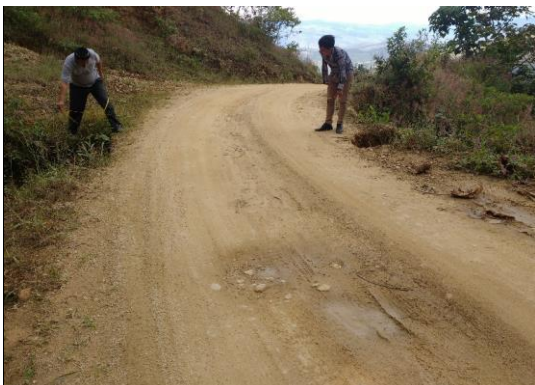
Foto 53: alcantarilla TMC Ø 36", en mal estado y funcional (prog. 06+600 km).
