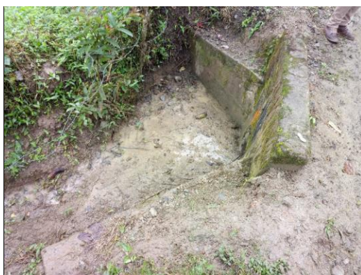
Foto 06: Alcantarilla TMC Ø36" cabezal de salida, en buen estado y funcional (0+510 km)
