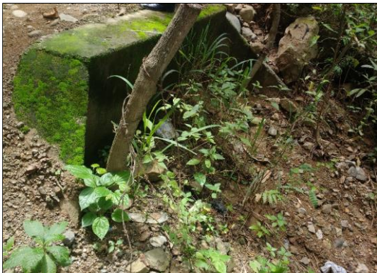
Foto 09: Cabezal de salida de alcantarilla TMC Ø 36", en regular estado y colmatada (prog. 1+060 km)
