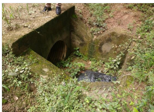
Foto 04: Cabezal de entrada de alcantarilla TMC Ø 36", en regular estado y funcional (prog. 0+730 km).
