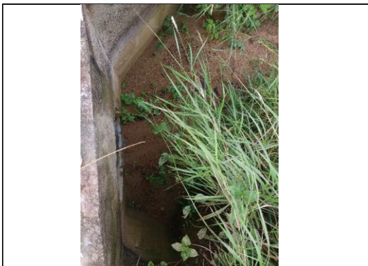
Foto 33: Cabezal de salida de alcantarilla TMC Ø 36", en regular estado y semi colmatado (prog. 04+325 km).
