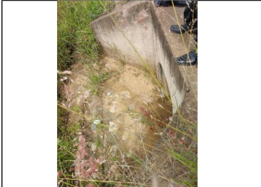
Foto 19: Cabezal de salida de aliviadero TMC Ø 36", en regular estado y funcional (prog. 2+045 km).
