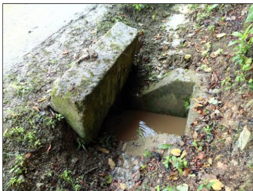
Foto 02: Alcantarilla TMC Ø12" cabezal de entrada, en buen estado y funcional (prog. 0+370 km)
