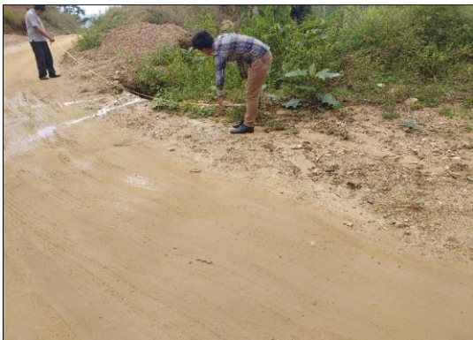
Foto 57: Baden de concreto (4.00x6.00 m) en regular estado y colmatado (prog. 7+030 km)
