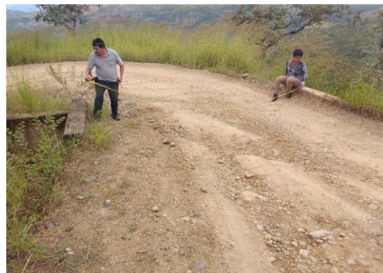
Foto 24: Aliviadero TMC Ø36", en regular estado y funcional (prog. 3+125 km)
