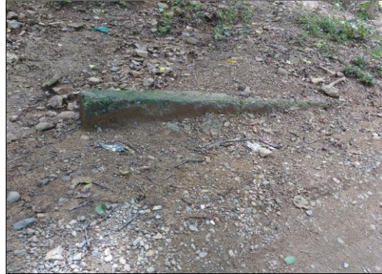
Foto 08: Cabezal de entrada de alcantarilla TMC Ø 36", en regular estado y colmatada (prog. 1+060 km).
