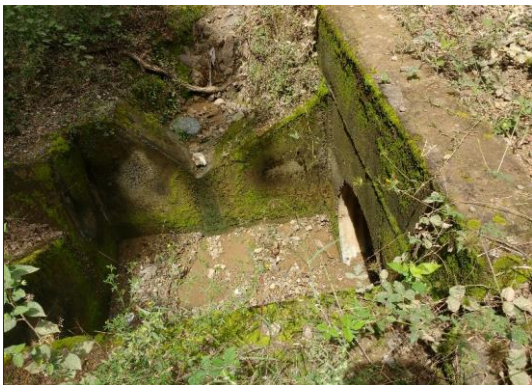
Foto 11: Cabezal de entrada de alcantarilla TMC Ø 36", en regular estado y funcional (prog. 1+150 km).
