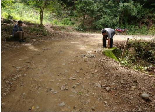
Foto 07: Alcantarilla TMC Ø 36", en mal estado y colmatada (prog. 1+060 km).
