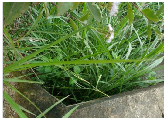
Foto 42: Cabezal de salida de aliviadero TMC Ø 36", en mal estado y colmatado (prog. 05+640 km).
