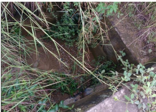
Foto 35: Cabezal de entrada de aliviadero TMC Ø 36", en regular estado y semicolmatado (prog. 04+545 km).
