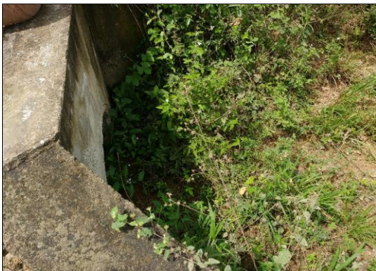
Foto 15: Cabezal de salida de alcantarilla TMC Ø 36", en regular estado y semi colmatada (prog. 1+585 km)
