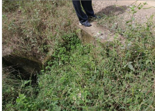
Foto 14: Cabezal de entrada de alcantarilla TMC Ø 36", en regular estado y semi colmatada (prog. 1+585 km).
