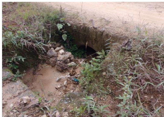
Foto 54: Cabezal de entrada de alcantarilla TMC Ø 36", en regular estado y semi colmatada (prog. 06+600 km).
