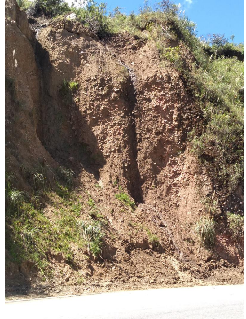
Vista km 154+200 – Agua en talud
