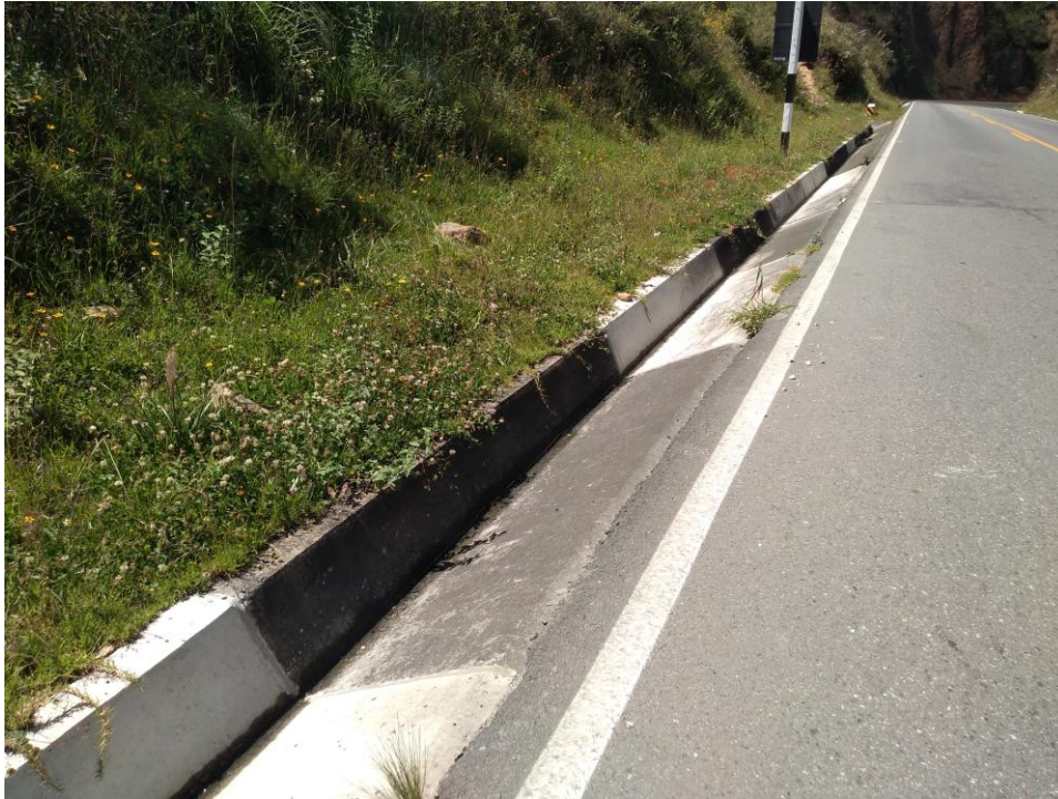
Vista km 154+400 – Presencia de agua en cuneta y berma
