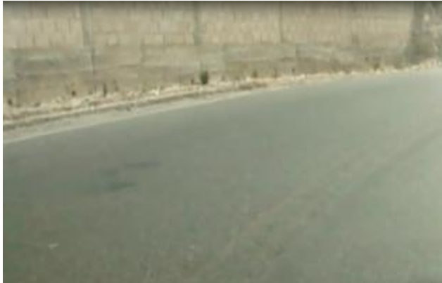
Figura 14: D2 daño de exudación en severidad media (Muestra 801 - km 163+578, sector 2)
