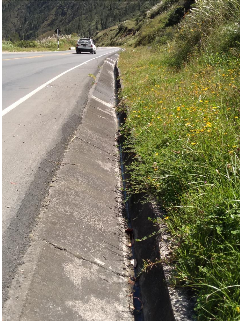
Vista km 154+200 -- Presencia de agua en cuneta y berma
