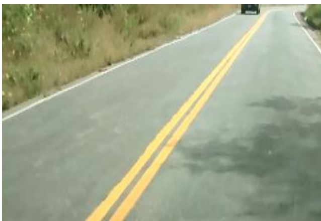
Figura 15: D5 daño de corrugación en severidad media (Muestra 133 - km 138+603, sólo en sector 1)
