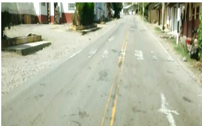
Figura 24: D15 daño de ahuellamiento en severidad media (Muestra 217 - km 141+753, sector 1)
