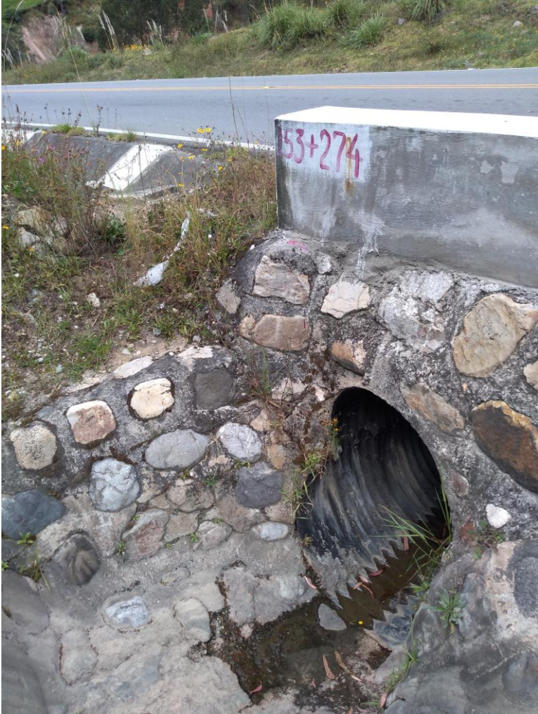
Vista km 153+274 – Evidencia de agua de infiltración
