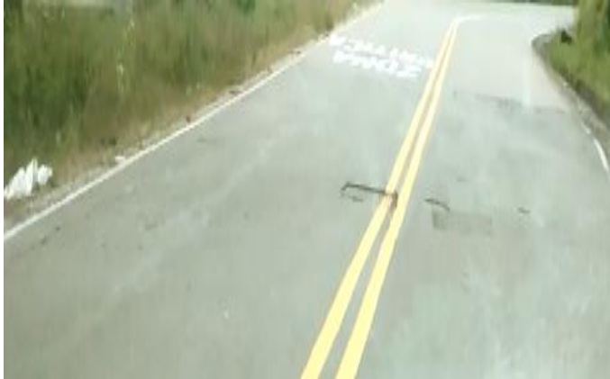
Figura 22: D13 daño de huecos en severidad media (Muestra 149 - km 139+203, sector 1)
