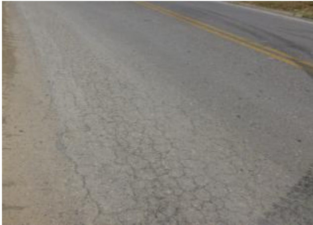
Figura 11: D1 daño piel de cocodrilo en severidad media (Muestra 5 - km 133+653, sector 1)
