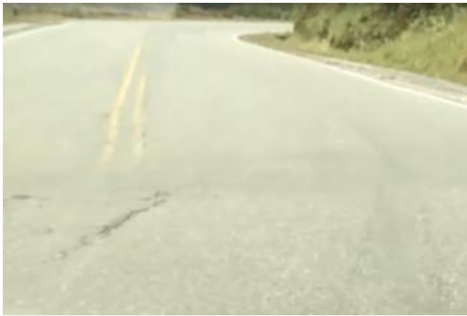
Figura 17: D6 daño de depresión en severidad media (Muestra 641 - km 157+578, sector 2)
