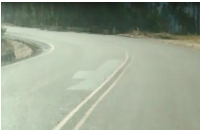
Figura 21: D11 daño de parcheo en severidad baja (Muestra 861 - km 165+828, sector 2)
