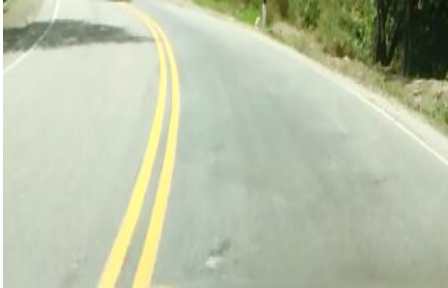
Figura 13: D2 daño de exudación en severidad baja (Muestra 225 - km 142+053, sector 1)
