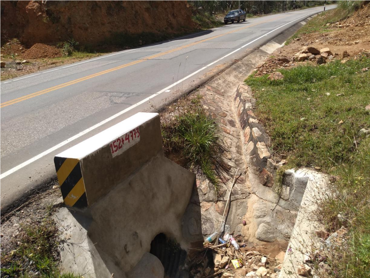
Vista km 152+473 – No existe subdren presencia de humedad y daños en el pavimento
