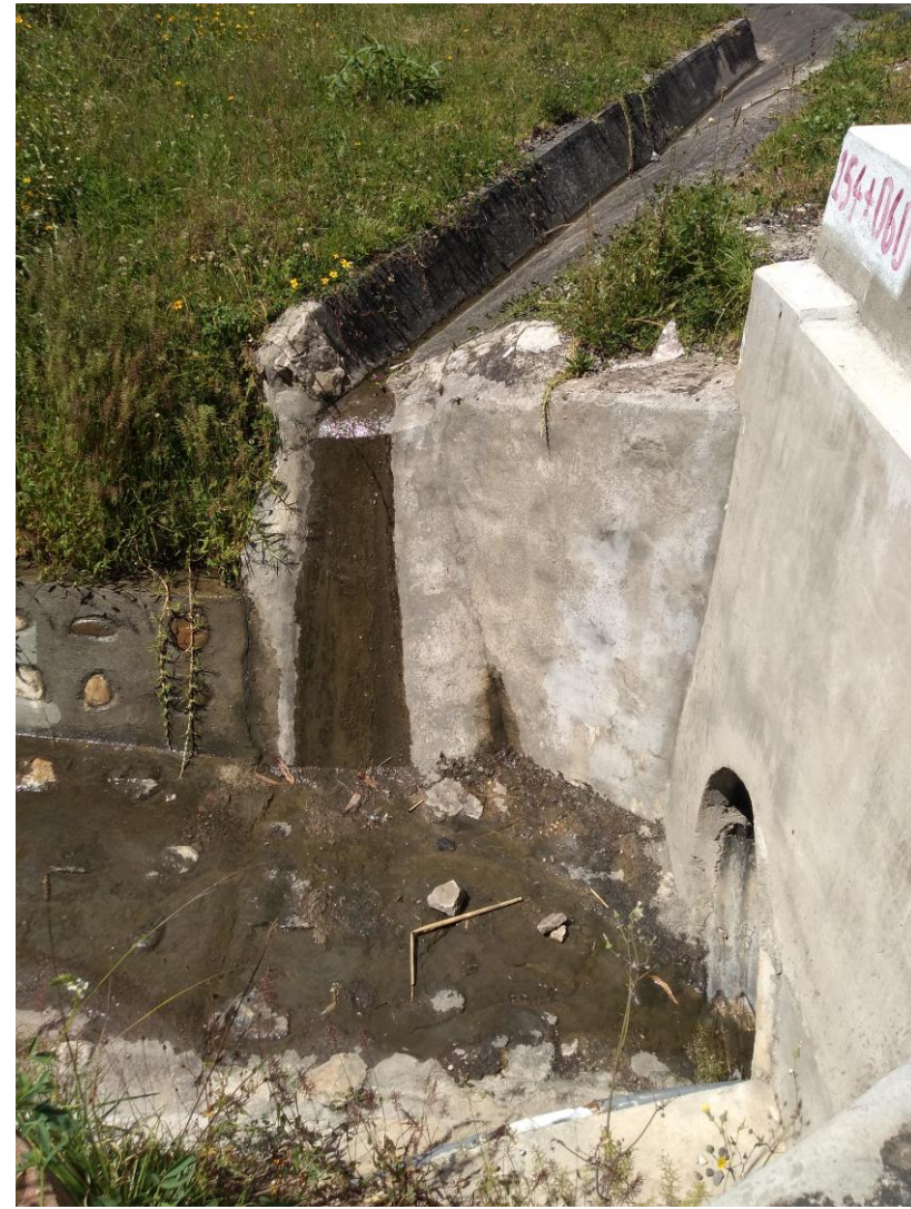
Vista km 154+060 – No existe subdren
