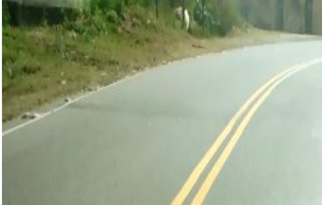
Figura 16: D6 daño de depresión en severidad media (Muestra 445 - km 150+303, sector 1)
