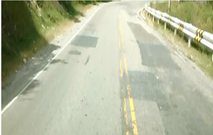
Figura 20: D11 daño de parcheo en severidad baja (Muestra 181 - km 140+403, sector 1)
