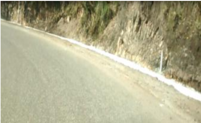
Figura 27: D19 daño de meteorización en Severidad media (Muestra 753 - km 161+778, S-2)
