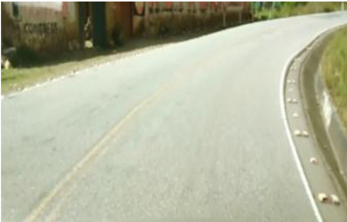
Figura 26: D19 daño de meteorización en severidad media (Muestra 497 - km 152+253, sector 1)
