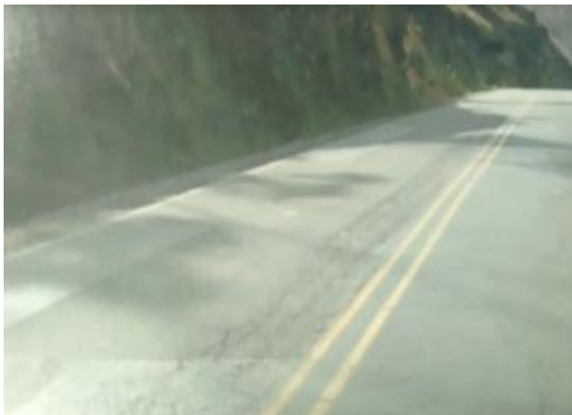
Figura 12: D1 daño piel de cocodrilo en severidad media (Muestra 761- km 162+078, sector 2)
