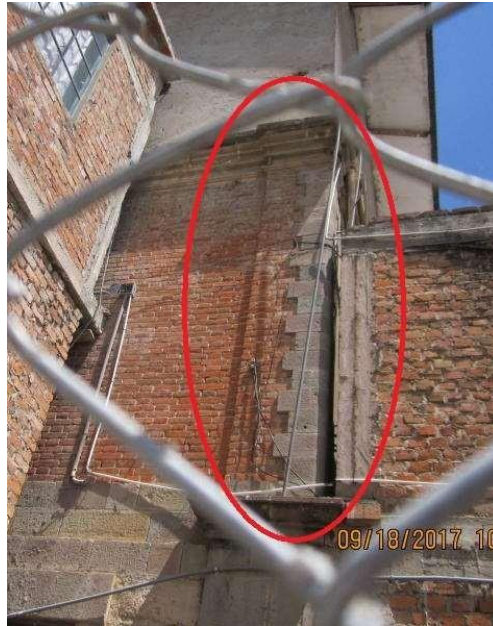
Figura 38. Esquina de la edificación sin columna.
