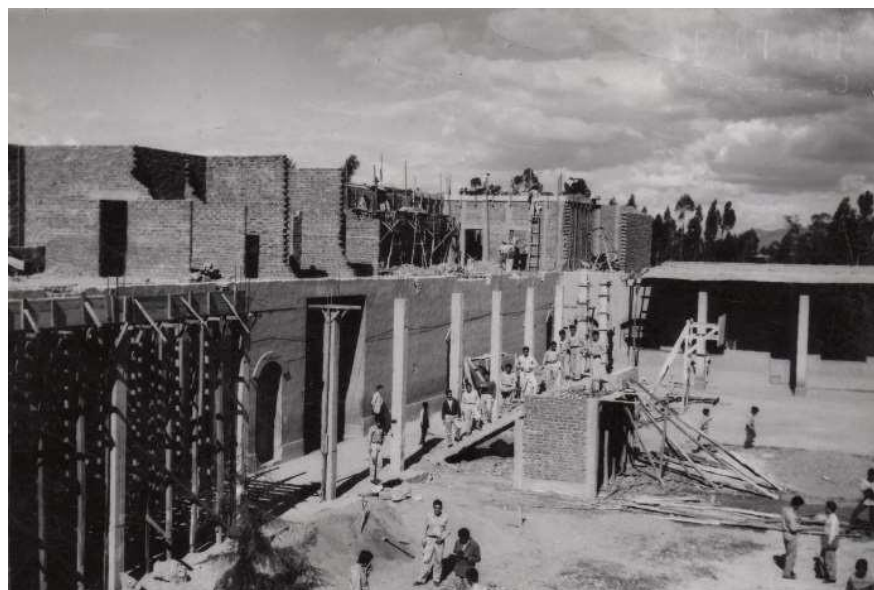
Figura 42. Construcción del segundo piso del Pabellón D en 1961. Fuente: Archivo fotográfico ISEP “Hno. Victorino Elorz Goicoechea”.
