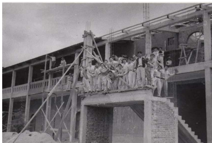
Figura 43. Colocación del techo del segundo piso del Pabellón D en 1961. Fuente: Archivo fotográfico ISEP “Hno. Victorino Elorz Goicoechea”.
