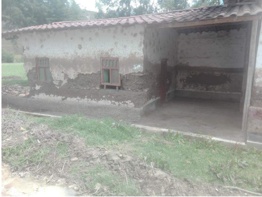
Figura N° 75: Casa deteriorada por inundación en el centro poblado La Quispa. Fuente: Fotografía Propia.
