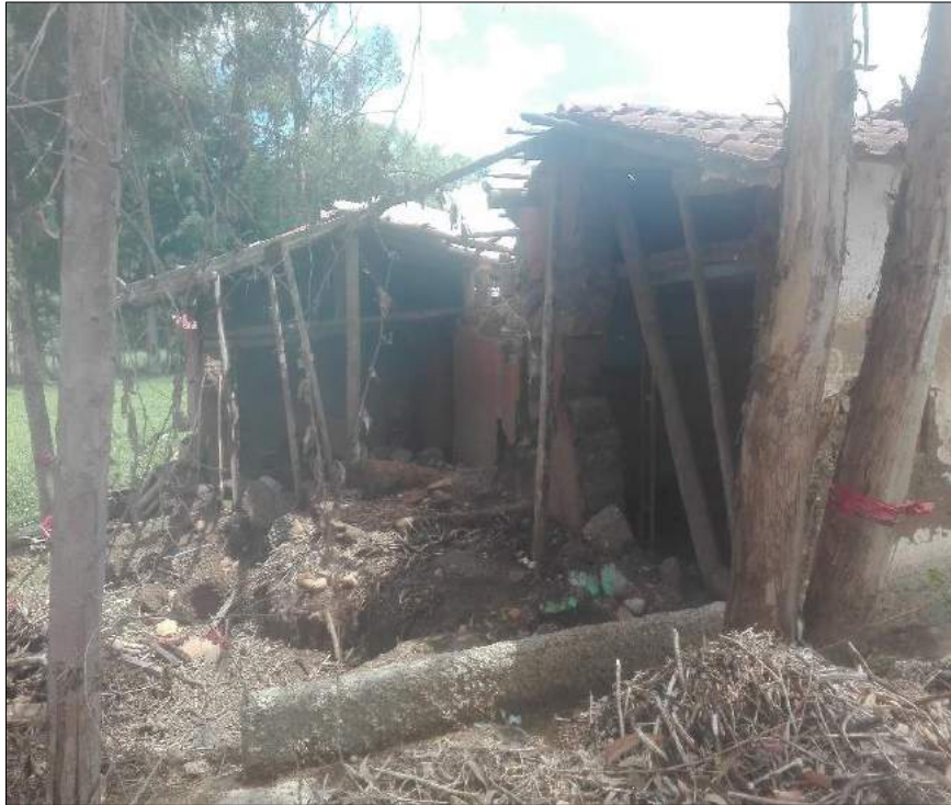
Figura N° 2: Casa destruida por desborde del río Quinuas en el centro poblado La Quispa Fuente: Propia
