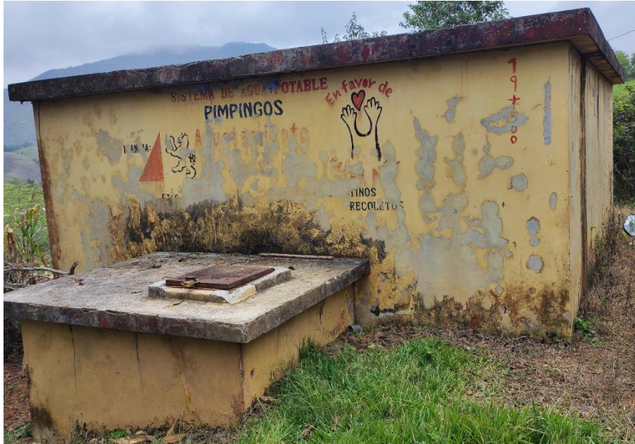
Foto 14: Reservorio rectangular del sistema de agua potable.
