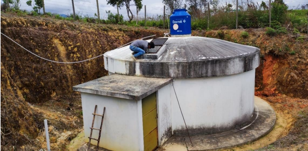
Foto 16: Medición de niveles de agua consumida en los reservorios.
