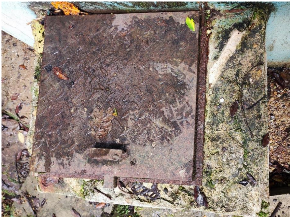
Foto 5: Tapa metálica de la cámara de válvulas en mal estado.
