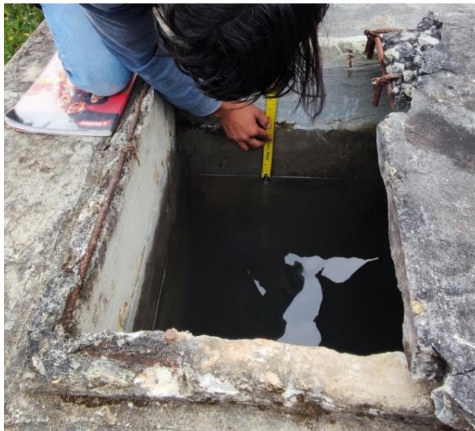
Foto 15: Rotura y fisuras del concreto en el Reservorio rectangular.
