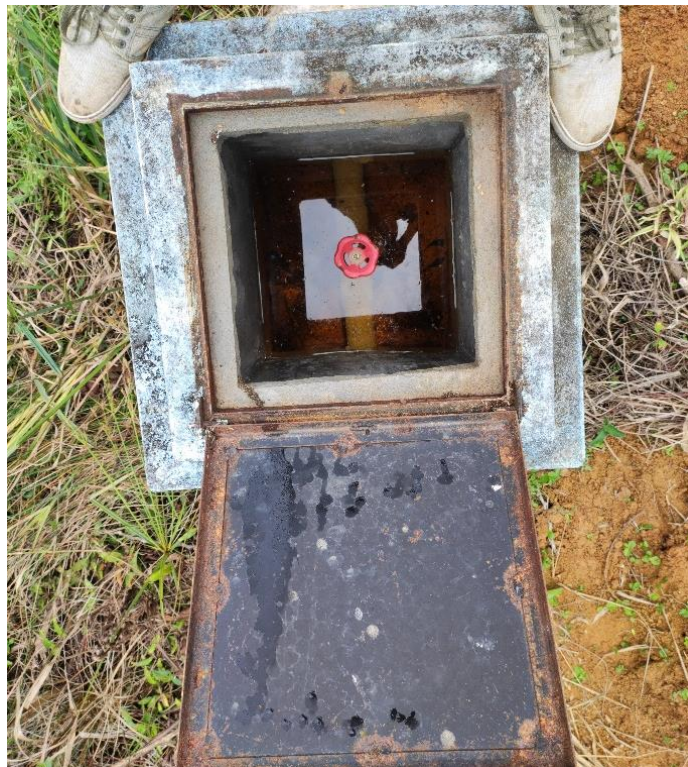
Foto 8: Válvulas de purga.
