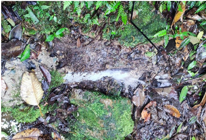
Foto 21: Rotura de la tubería de conducción por la ausencia de válvulas de aire.
