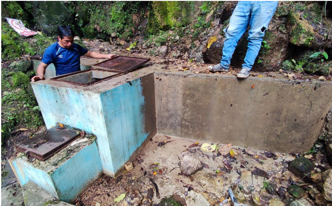
Foto 22: Visita técnica a las captaciones de manantial.
