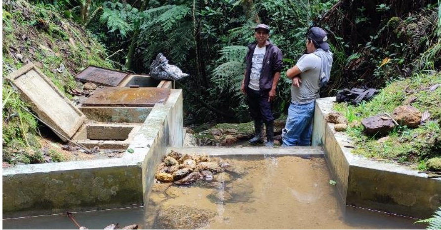
Foto 1: Captación Santa Rosa del sistema de agua potable.
