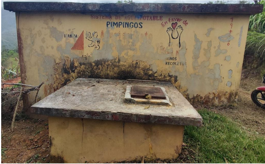
Foto 30: Reservorio rectangular del sistema.
