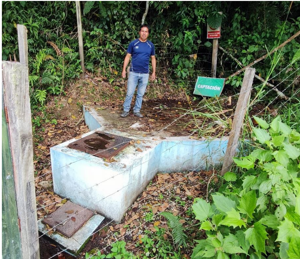
Foto 4: Captación N° 3 del cerro Llahuago.
