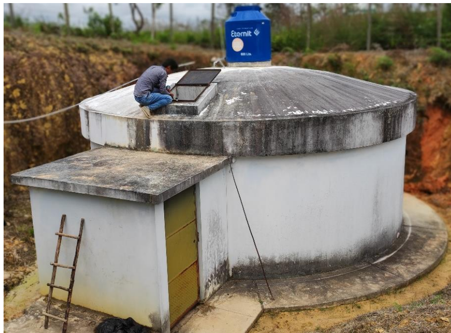
Foto 13: Reservorio circular del sistema de agua potable.
