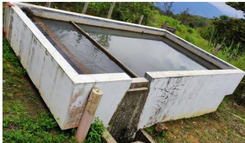
Foto 7: Desarenador del sistema de agua potable.
