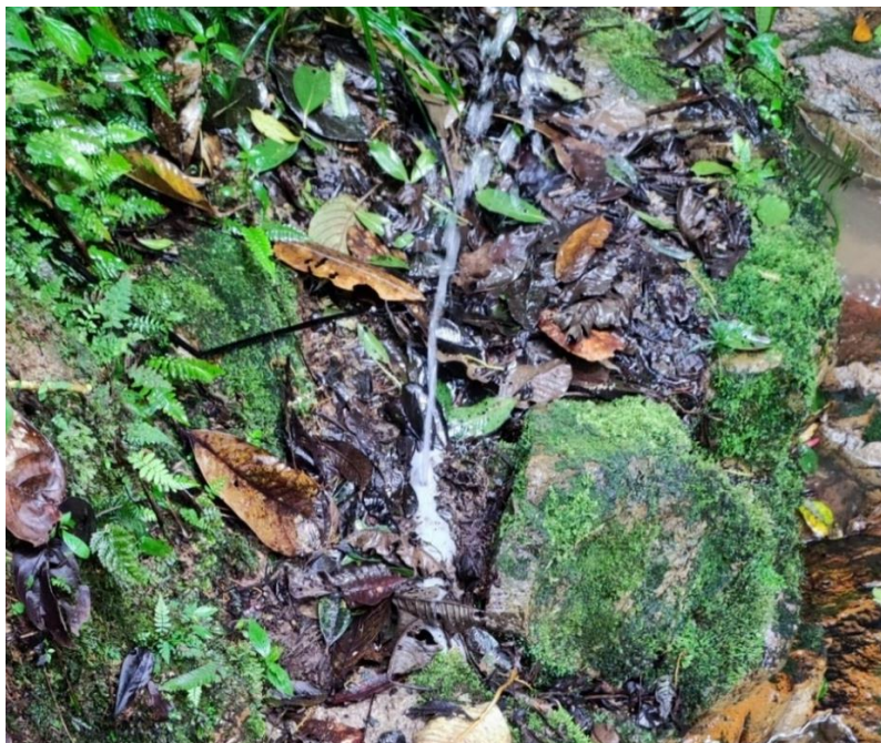
Foto 6: Rotura con taladro de 1/8" en la parte superior de la tubería.
