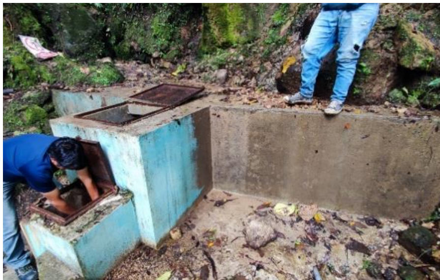
Foto 2: Captación N° 1 del cerro Llahuago.
