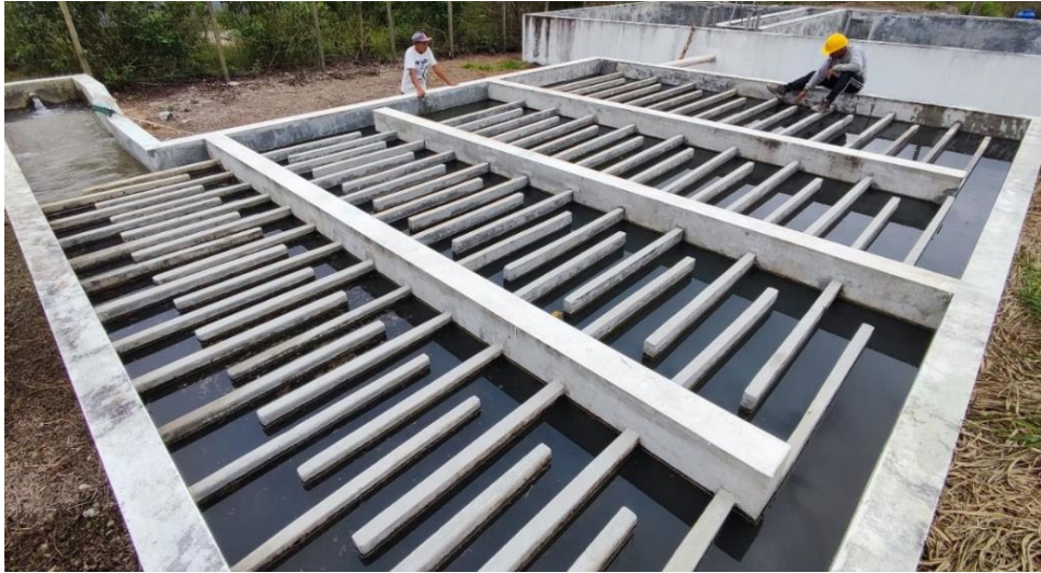
Foto 10: Floculador de la planta de tratamiento.
