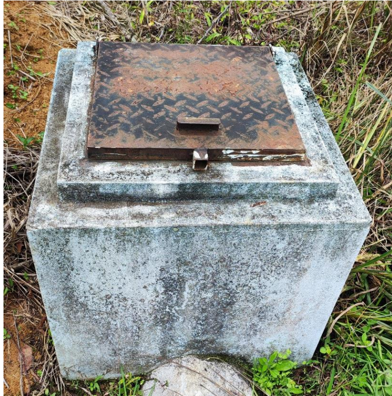
Foto 9: Cámara de las válvulas de purga.
