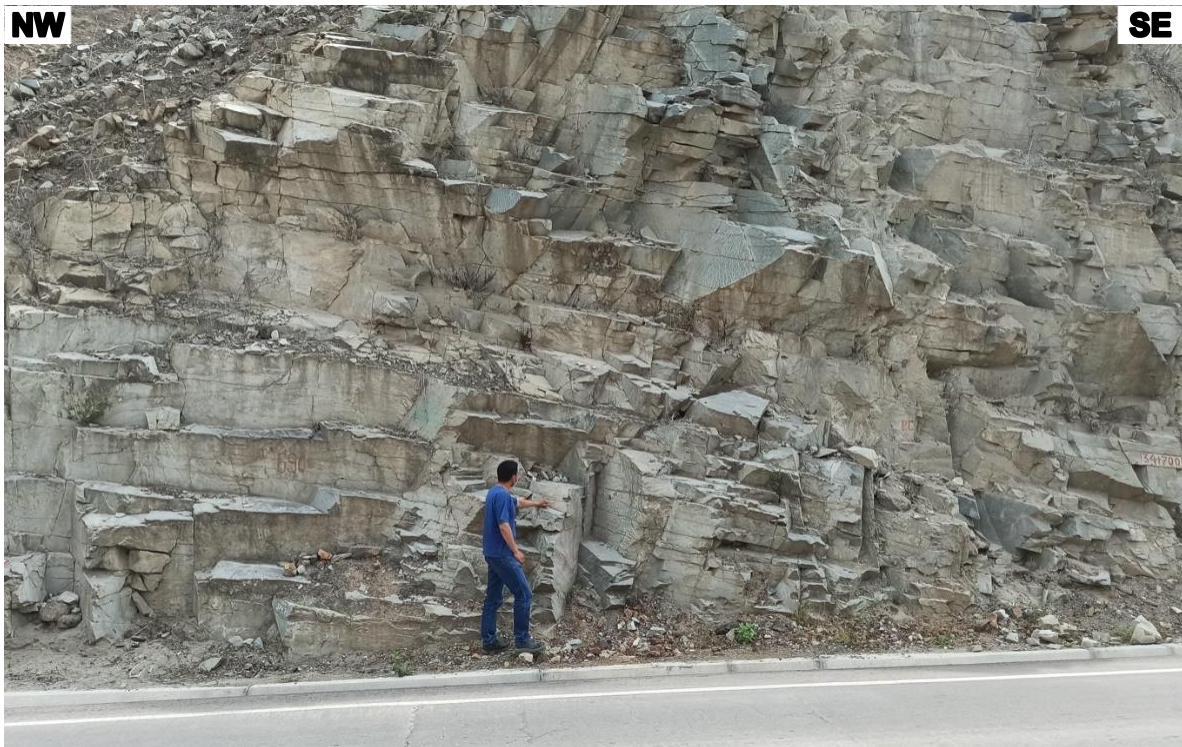
Foto 3.25: Afloramiento de roca granodiorita, entre el Km.34+700 y Km. 35+033 de la carretera Ciudad de Dios - Cajamarca. Coordenadas: E 696796; N 919982; Cota= 377 m.s.n.m.
