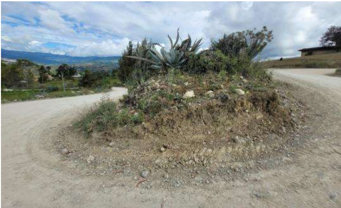
Figura N°18. Curva que no tiene el sobreebanco mínimo.
