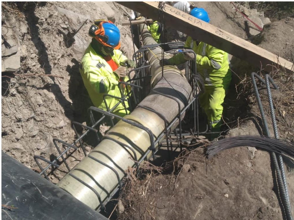
Fotografía N° 26. Partida de “Habilitación y colocación de acero”, actividad de colocación de acero.
