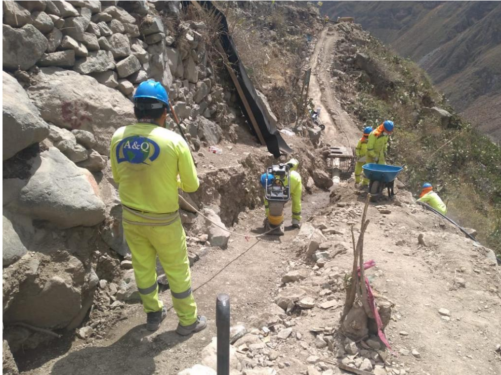
Fotografía N° 02. Partida de “Relleno con material propio zarandeado”, actividad de compactación con equipo. Zona con mayor pendiente.
