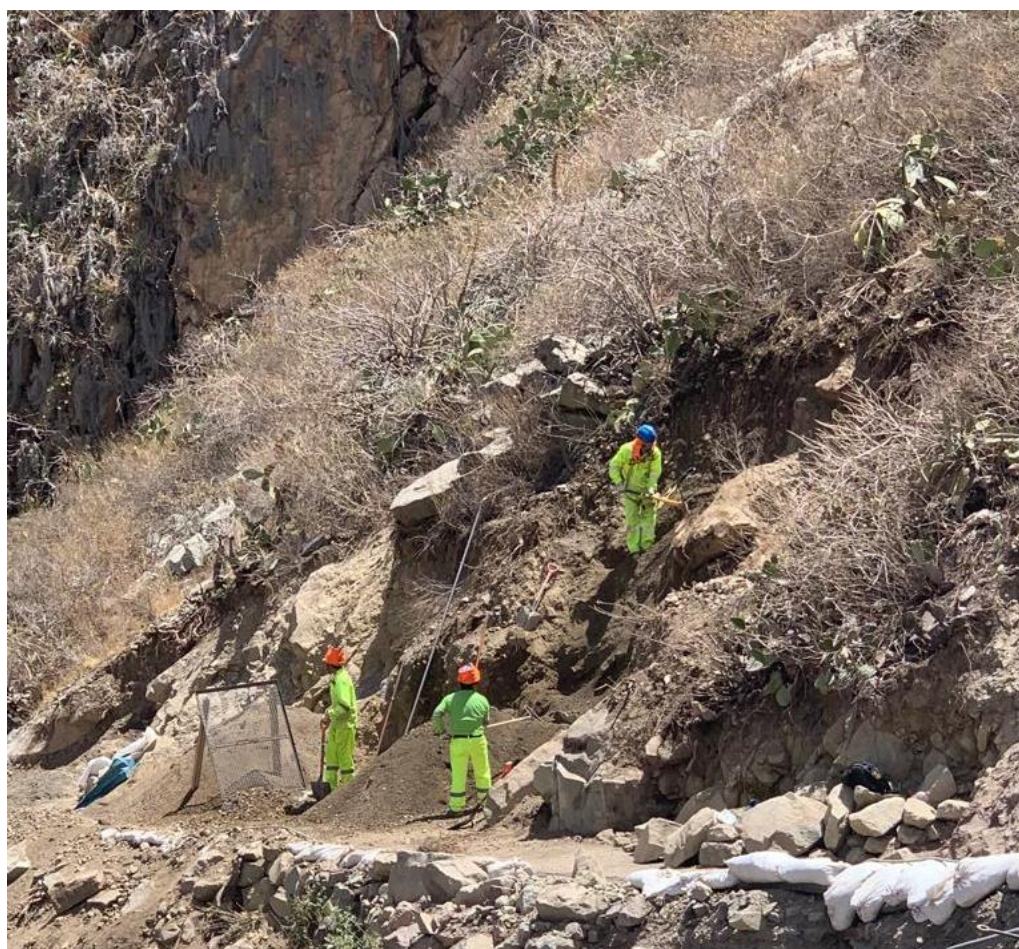
Fotografía N° 12. Partida de “Relleno con material propio zarandeado”, actividad de “acopio y zarandeo”.
