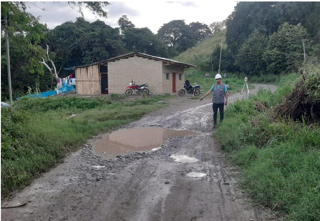
Fotografía 8. Deficiencia en la calzada por falta de peralte en la carretera.
