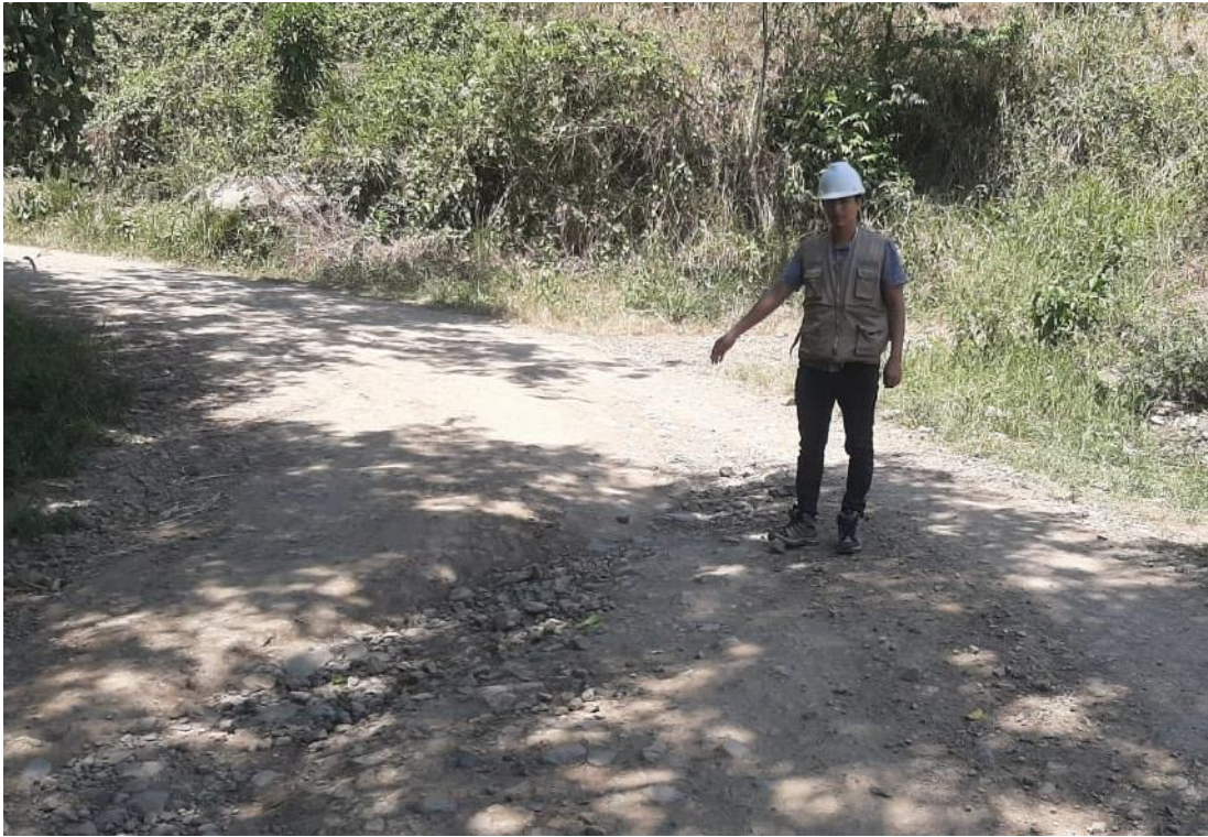
Fotografía 9. Deficiencia de calzada en la carretera.
