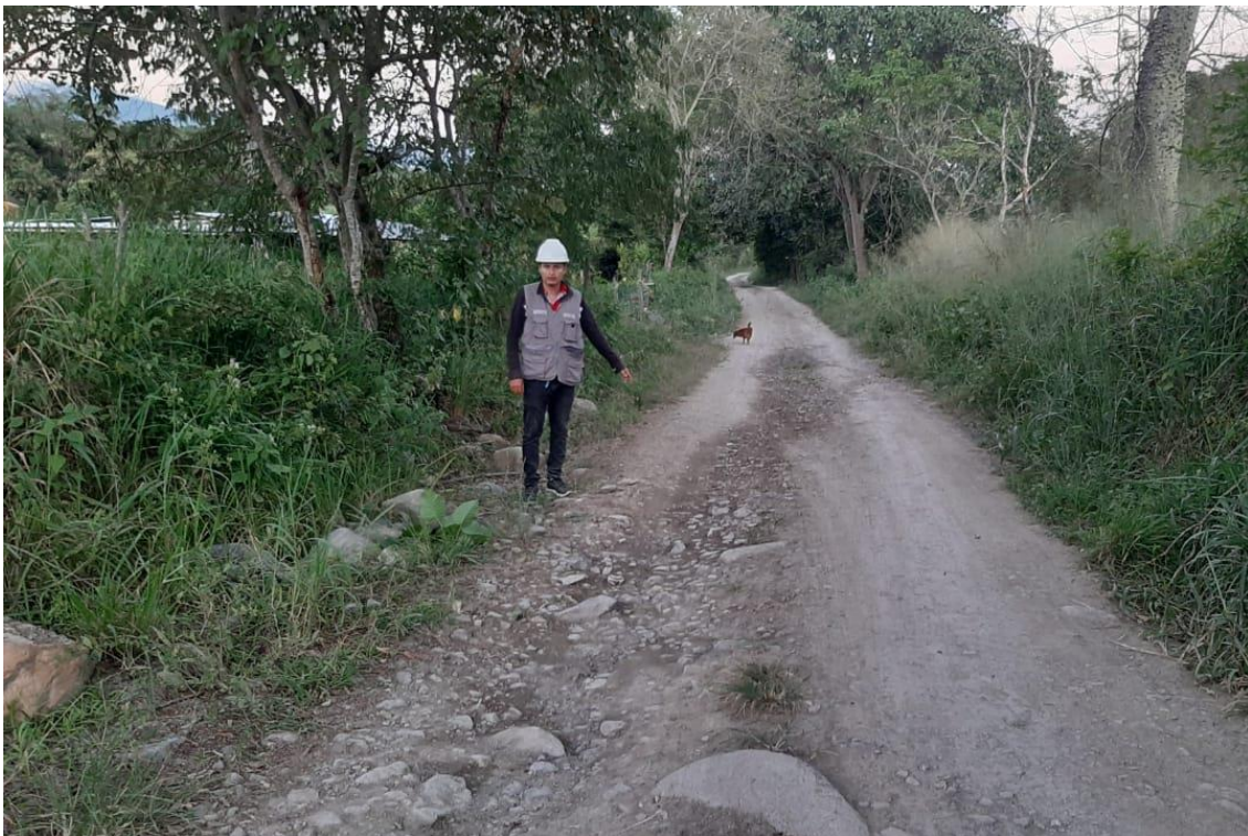
Fotografía 10. Deficiencia y falta de bombeo en la de calzada de la carretera.
