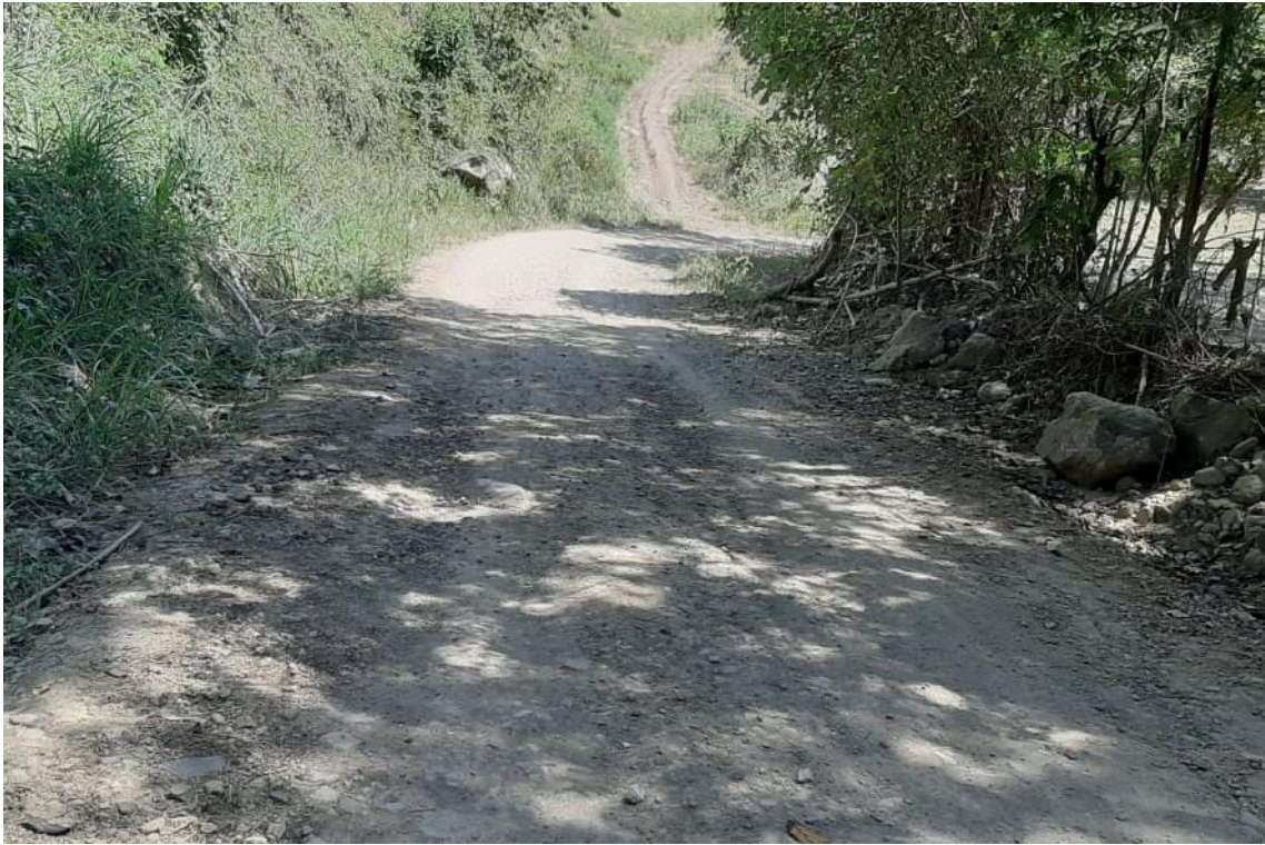
Fotografía 15. Falta de bombeo en la calzada de la carretera.
