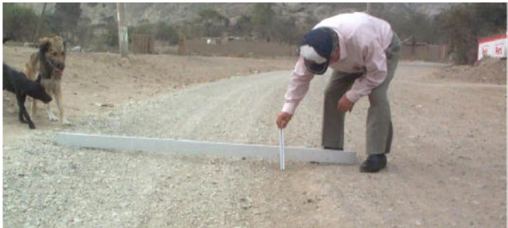
Figura 2.- Gravedad 2: Huellas/hundimientos entre 5 cm y 10 cm
