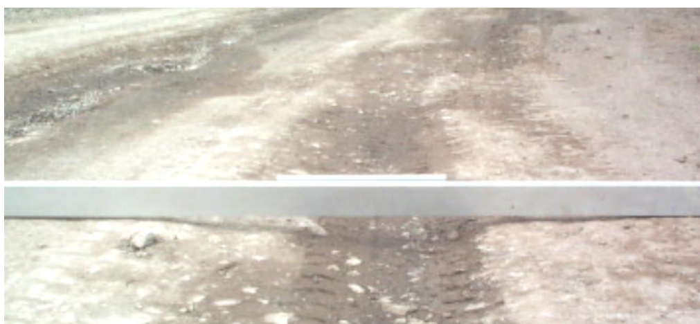
Figura 5.- Gravedad 2: Profundidad entre 5 cm y 10 cm.
