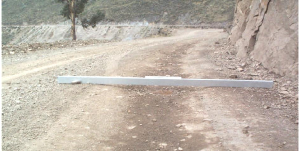
Figura 3.- Gravedad 3: Huellas/hundimientos \geq 10 cm.
