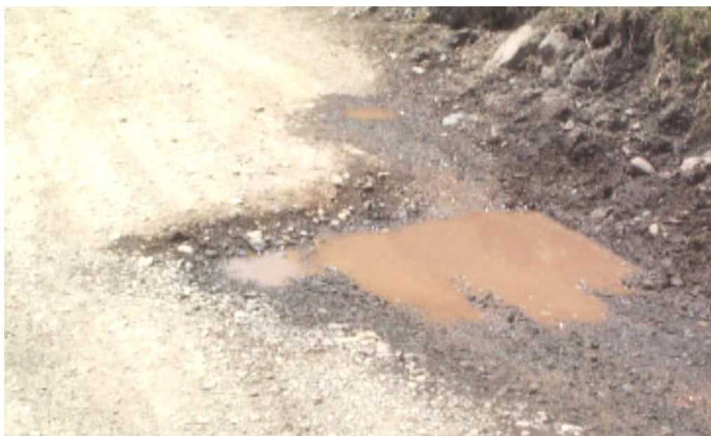
Figura 7.- Gravedad 1: Pueden repararse por mantenimiento rutinario
