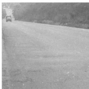
Nivel de Severidad - Bajo
