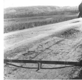
Nivel de Severidad - Alta
