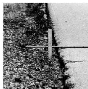
Nivel de Severidad - Alta
