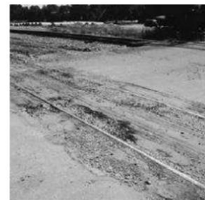
Nivel de Severidad - Alta
