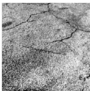
Nivel de Severidad - Bajo
