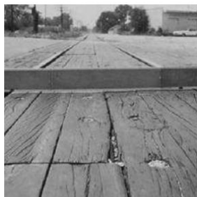
Nivel de Severidad - Bajo
