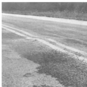
Nivel de Severidad - Alta
