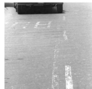
Nivel de Severidad - Alta
