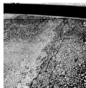
Nivel de Severidad - Alta
