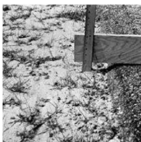
Nivel de Severidad - Bajo
