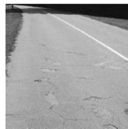
Nivel de Severidad - Alta
