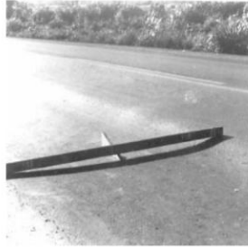
Nivel de Severidad - Bajo
