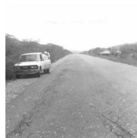
Nivel de Severidad - Alta
