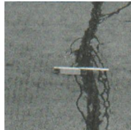
Nivel de Severidad - Alta
