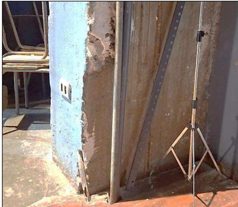
Figura N°1: Conjunto de lesiones físicas, mecánicas y químicas ubicadas en la columna (Ficha N°24)
