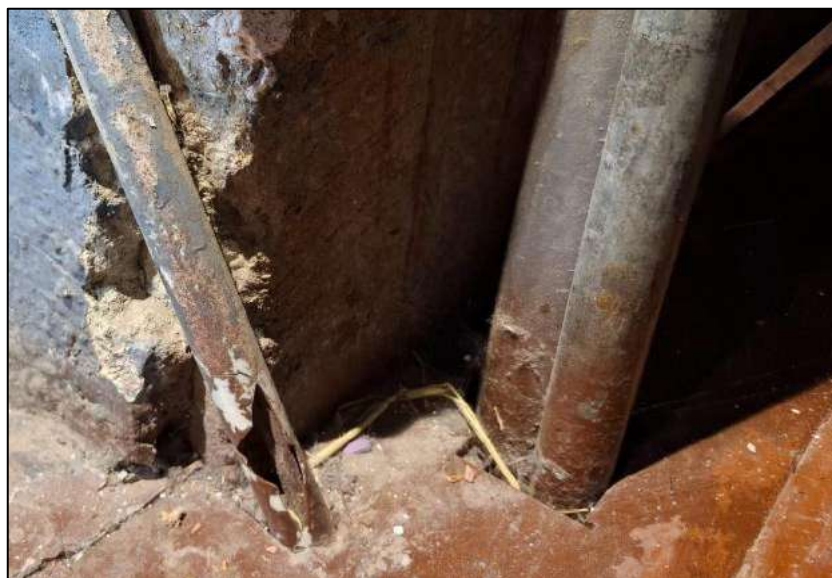
Figura N°10. Óxido adherido a elementos metálicos (Ficha N°25)
