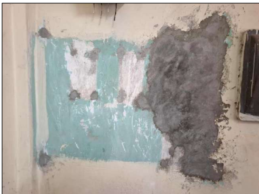
Figura N° 4: Exceso de suciedad en los muros (Ficha N°33)
