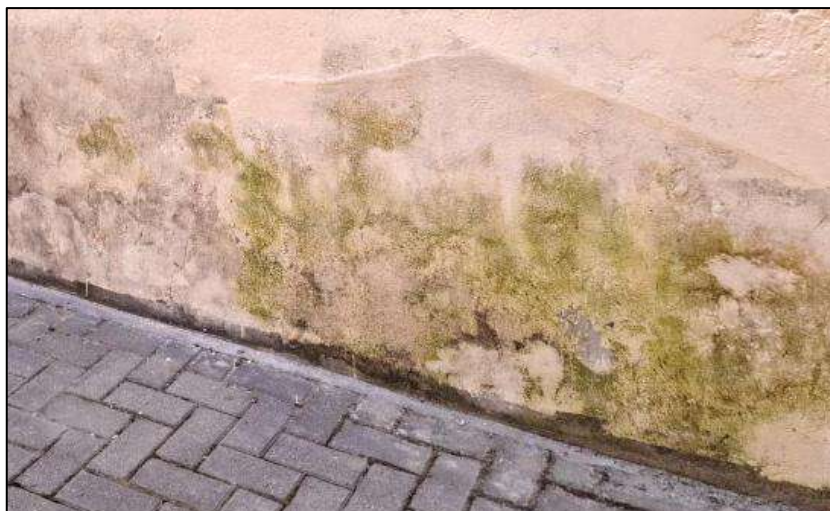
Figura N°12. Presencia de moho y hongos debido a la presencia de humedad en el muro (Ficha N°50)
