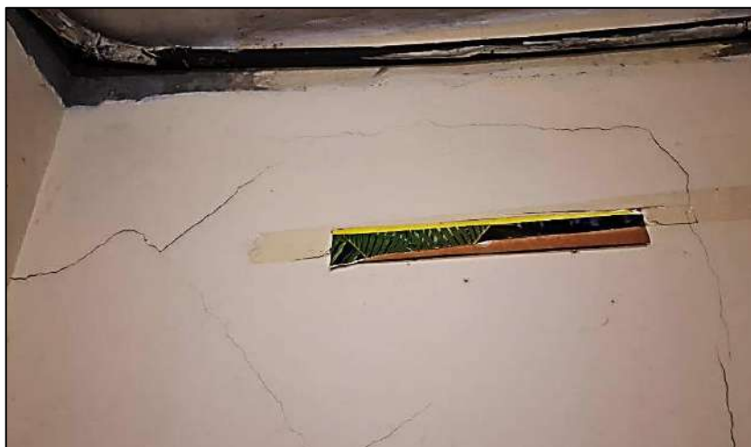
Figura N°6. Fisuras transversales y horizontales (Ficha N°30)
