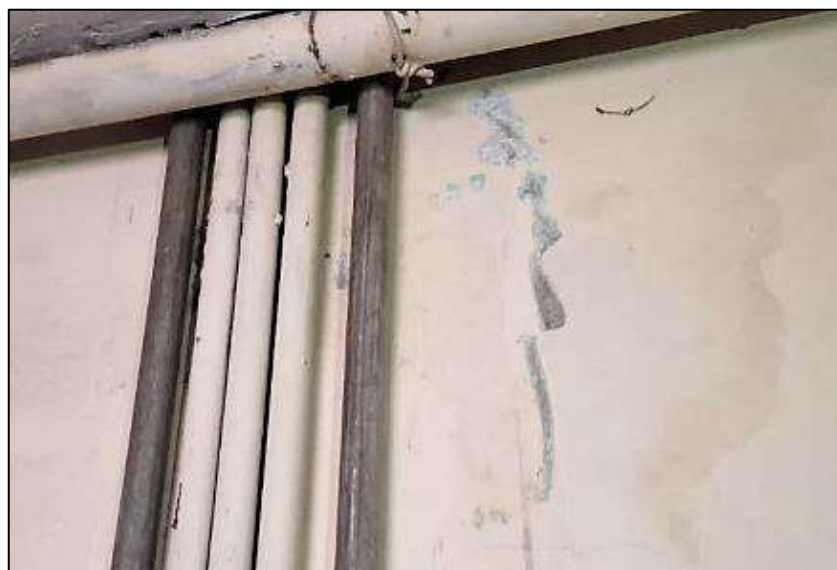
Figura N°9. Eflorescencia por la presencia de humedad (Ficha N°31)
