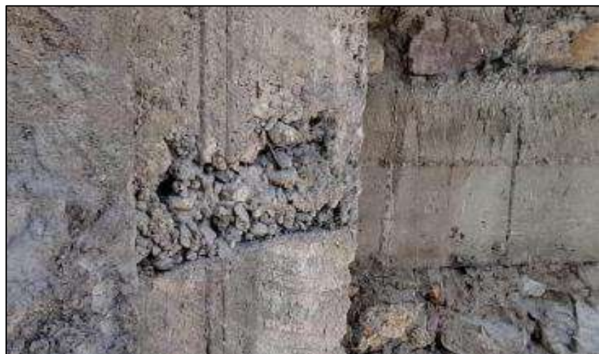
Figura N°5. Agrietamiento en el exterior de columnas (Ficha N°43)
