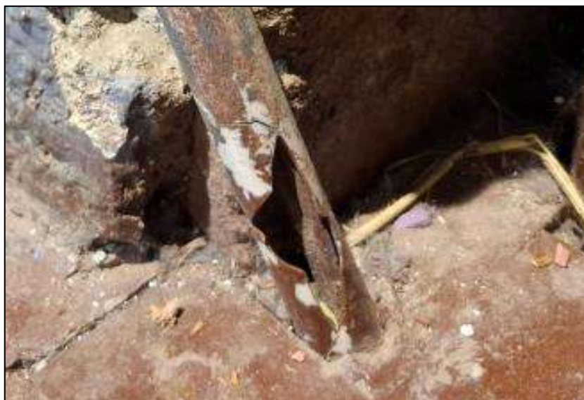
Figura N°11. Corrosión del elemento metálico (Ficha N°25)
