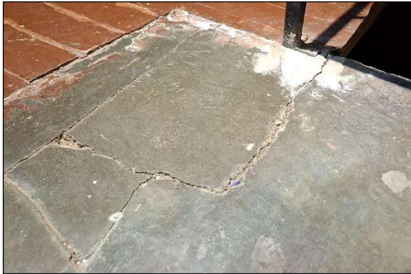
Figura N°7. Erosión Mecánica en la losa (Ficha N°27)
