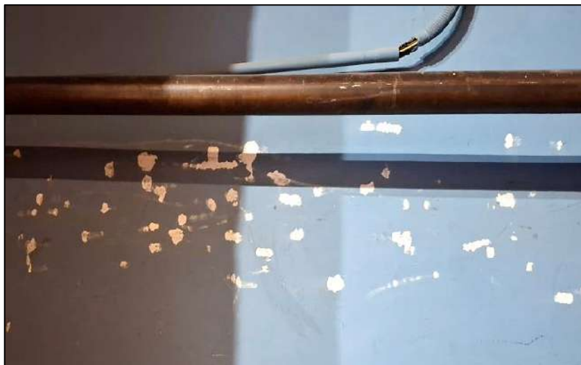
Figura N° 3: Descascaramiento del acabado del muro (Ficha N°23)
