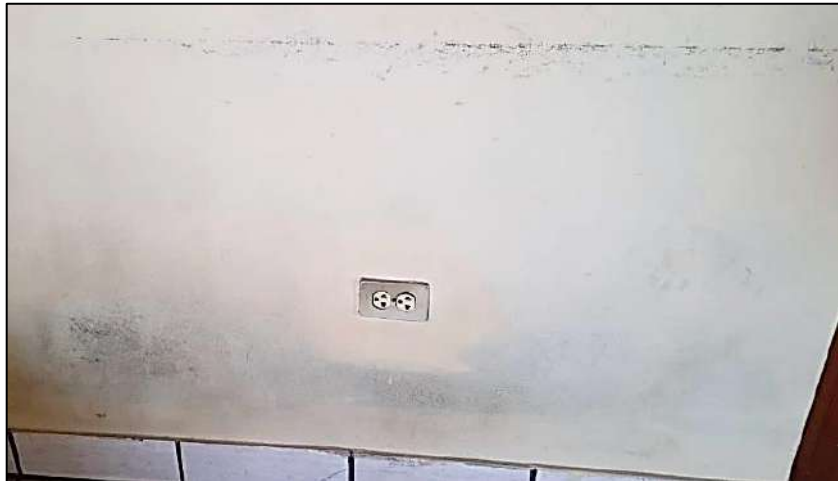
Figura N°2. Presencia de humedad en el muro
