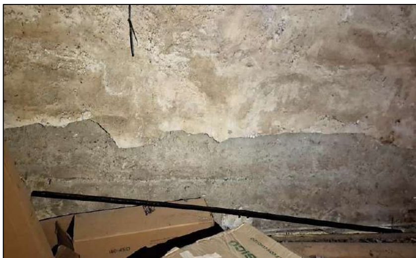
Figura N° 8: Desprendimiento del acabado del muro debido a la presencia de humedad (Ficha N°20)
