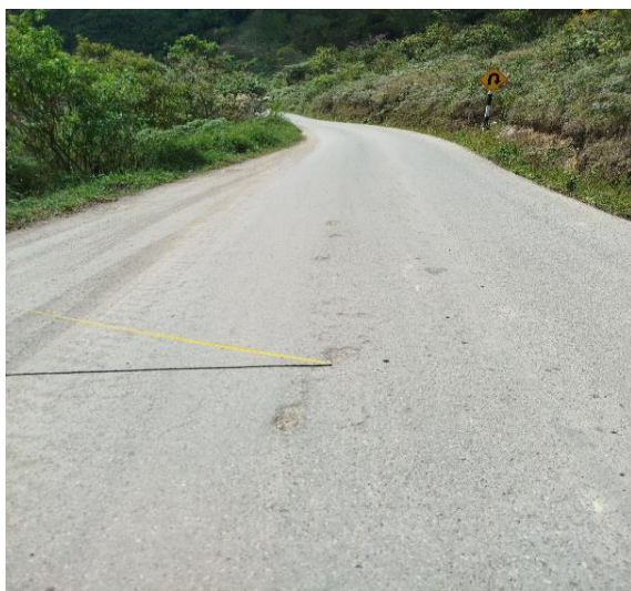
Fotografía N° 11. Se evidencia huecos (falla 13).
