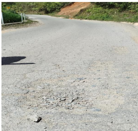
Fotografía N° 12. Se evidencia huecos (falla 13).
