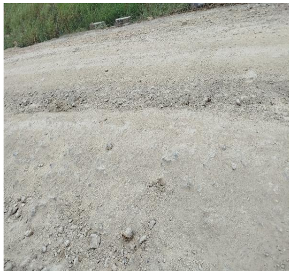
Fotografía N°8 Se evidencia ahuellamiento (falla 15).
