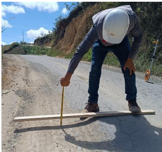
Fotografía N° 23. Se evidencia depresión (falla 6).
