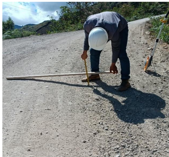
Fotografía N° 24. Se evidencia depresión (falla 6).
