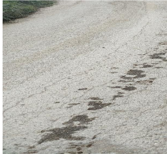
Fotografía N° 16. Se evidencia grietas longitudinales (falla 10).
