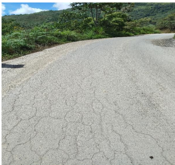
Fotografía N° 31. Se evidencia agrietamiento en bloque (falla 3).
