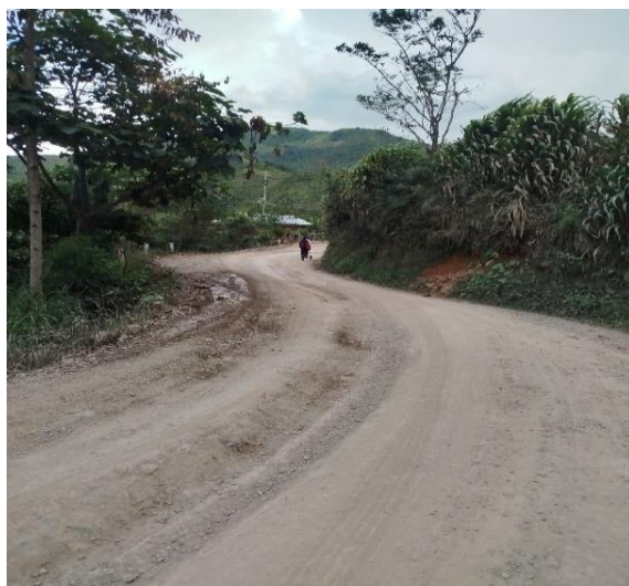
Fotografía N° 7. Se evidencia ahuellamiento (falla 15).
