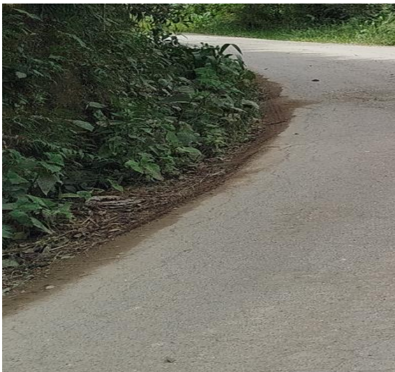
Fotografía N° 19. Se evidencia grietas de borde (falla 7).
