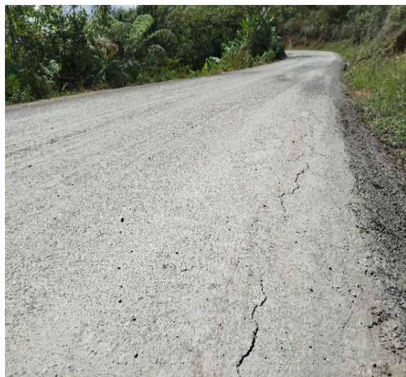
Fotografía N° 20. Se evidencia grietas de borde (falla 7).
