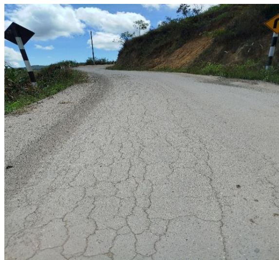
Fotografía N° 32. Se evidencia agrietamiento en bloque (falla 3).
