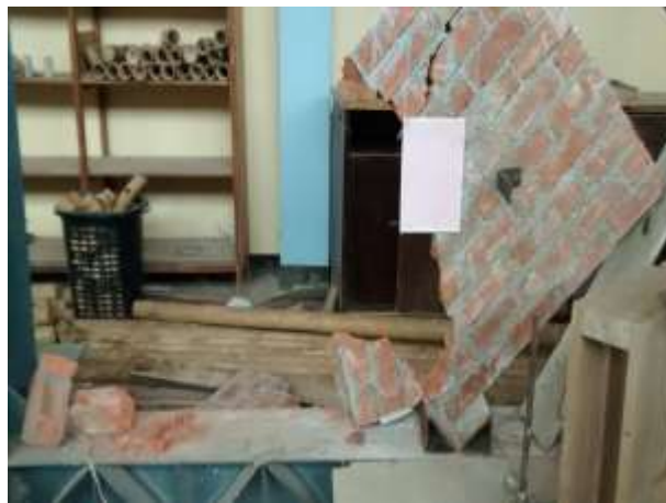
Foto. 11 Falla típica de los muretes de ladrillo de arcilla
