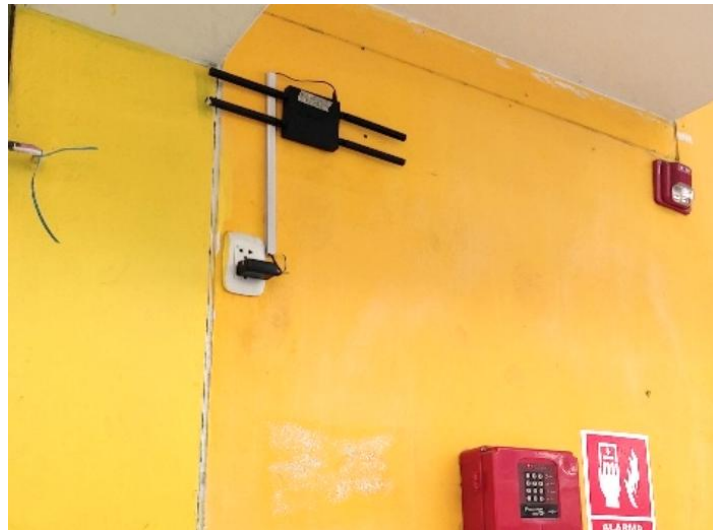
Fig. 9. Punto de Acceso conectado sólo a alimentación eléctrica
