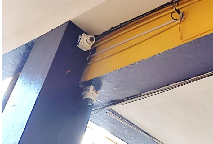
Fig. 6. Tipos de cámaras de vigilancia instaladas en el plantel
