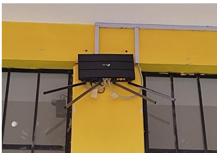
Fig. 4. Punto de acceso para la conexión Wifi en la institución
