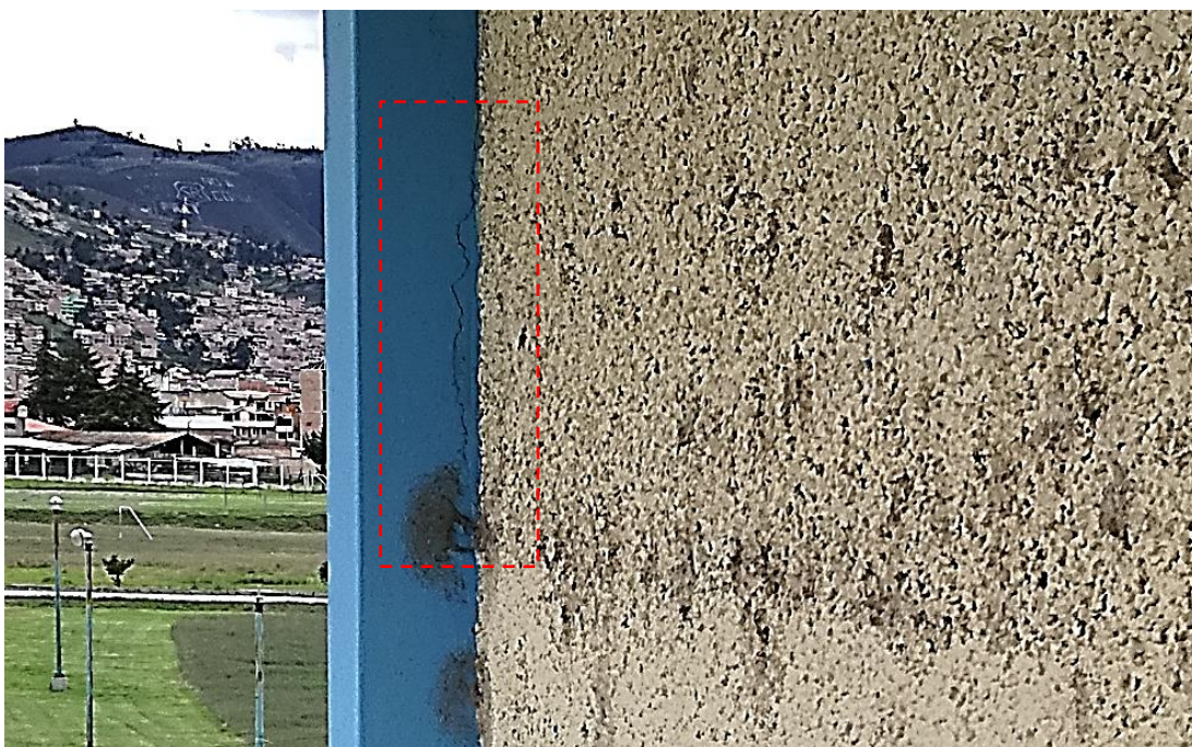
Figura 4.8. Fisura en la columna del eje 1-F – Tercer nivel.
