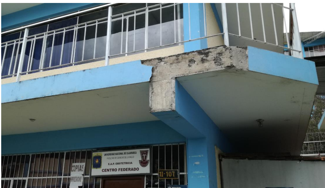
Figura 4.9. Falta de tarrajeo en losa aligerada de primer nivel.
