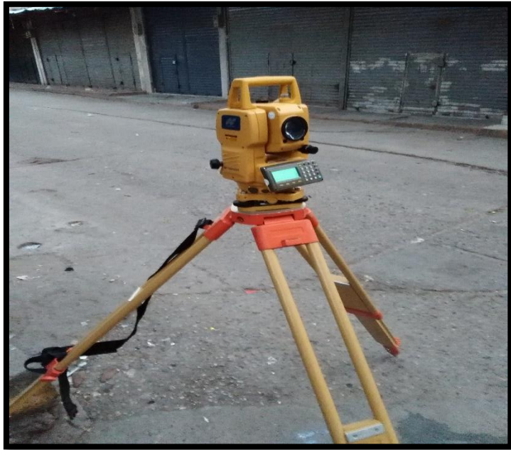
Fotografía N° 1: Se observa la instalación del equipo ubicado en el del Jirón Chanchamayo C-4- Km 0 +000
