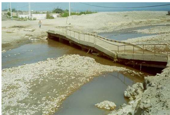
Figura 3. Colapso de un puente debido a la socavación local en sus pilares (Bianco 1998).
