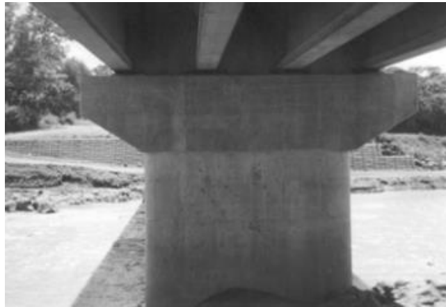
Figura 2. Pilar tipo pared construido en zona marítima. 1
