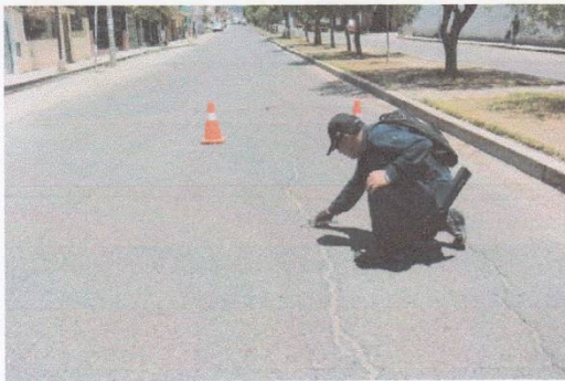
Imagen 5.2 Medición fisura longitudinal
