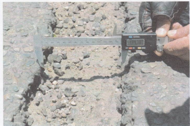
Imagen 5.5 Medición ancho fisura longitudinal con con calibrador digital
