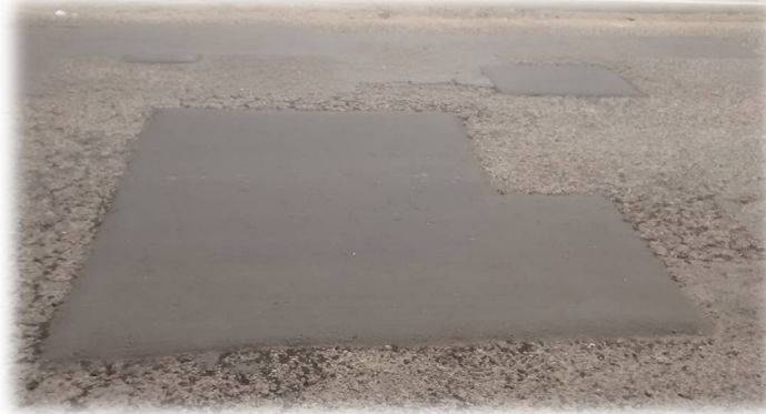
Figura 11. Parcheo y acometidas de servicio público severidad media-(Elaboración propia)
