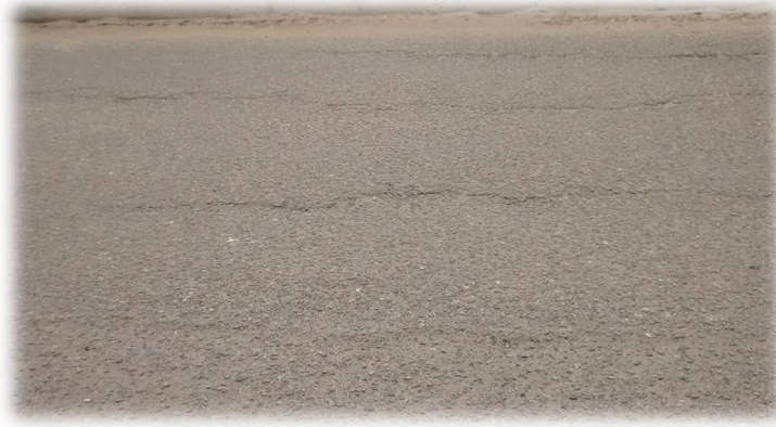
Figura 10 Grietas longitudinales y transversales (Elaboración propia)
