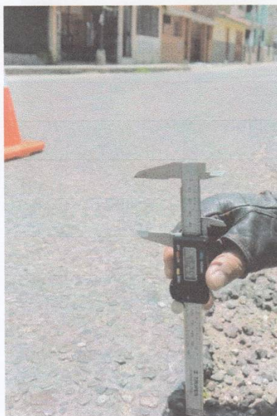
Imagen 5.4 Medición profundidad fisura longitudinal.
