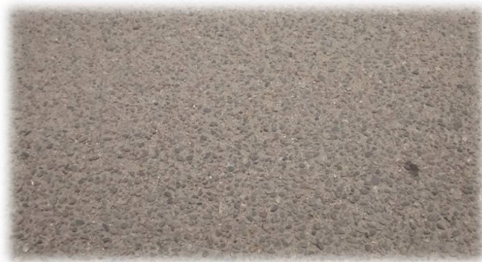
Figura 19. Meteorización/desprendimiento de agregados- (Elaboración propia)
