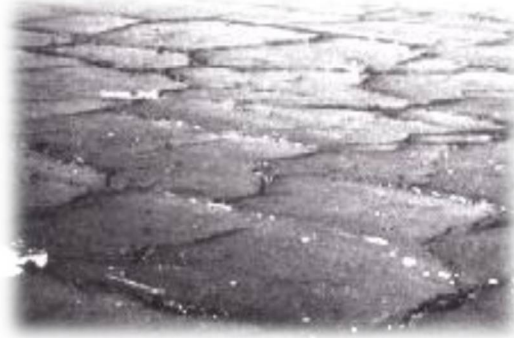
Figura 3. Agrietamiento en bloque-(Elaboración propia)
