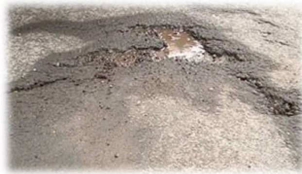
Figura 17. Grietas parabólicas-(Elaboración propia)
