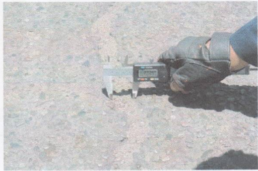
Imagen 5.3 Medición ancho fisura longitudinal
