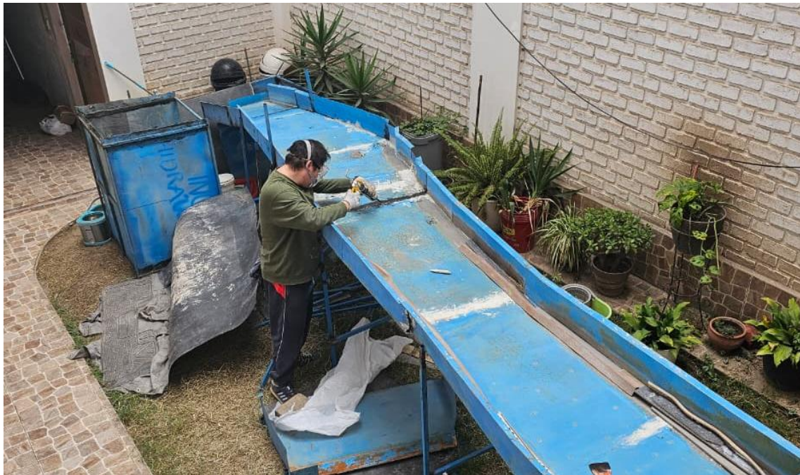
Figura 68: Aplicación de sellador en huecos y fisuras de la estructura metálica del modelo hidráulico.
