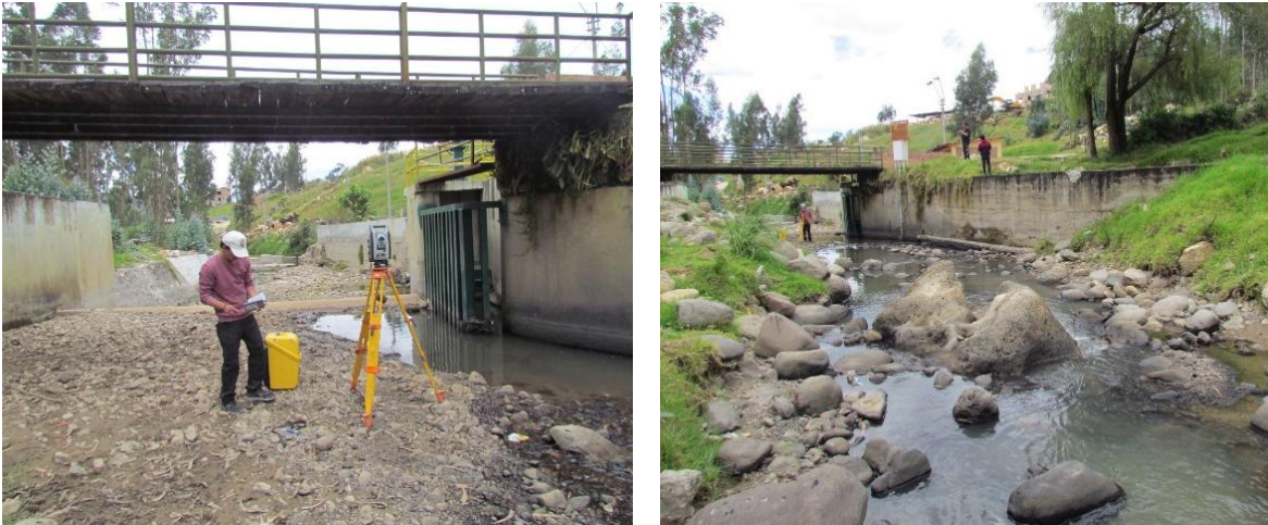
Figura 17: Colmatación aguas arriba del barrage de la captación derivadora.
