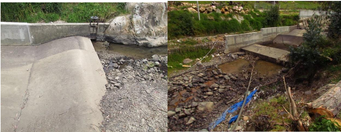
Figura 20: Colmatación y socavación aguas abajo del barrage de la segunda captación.
