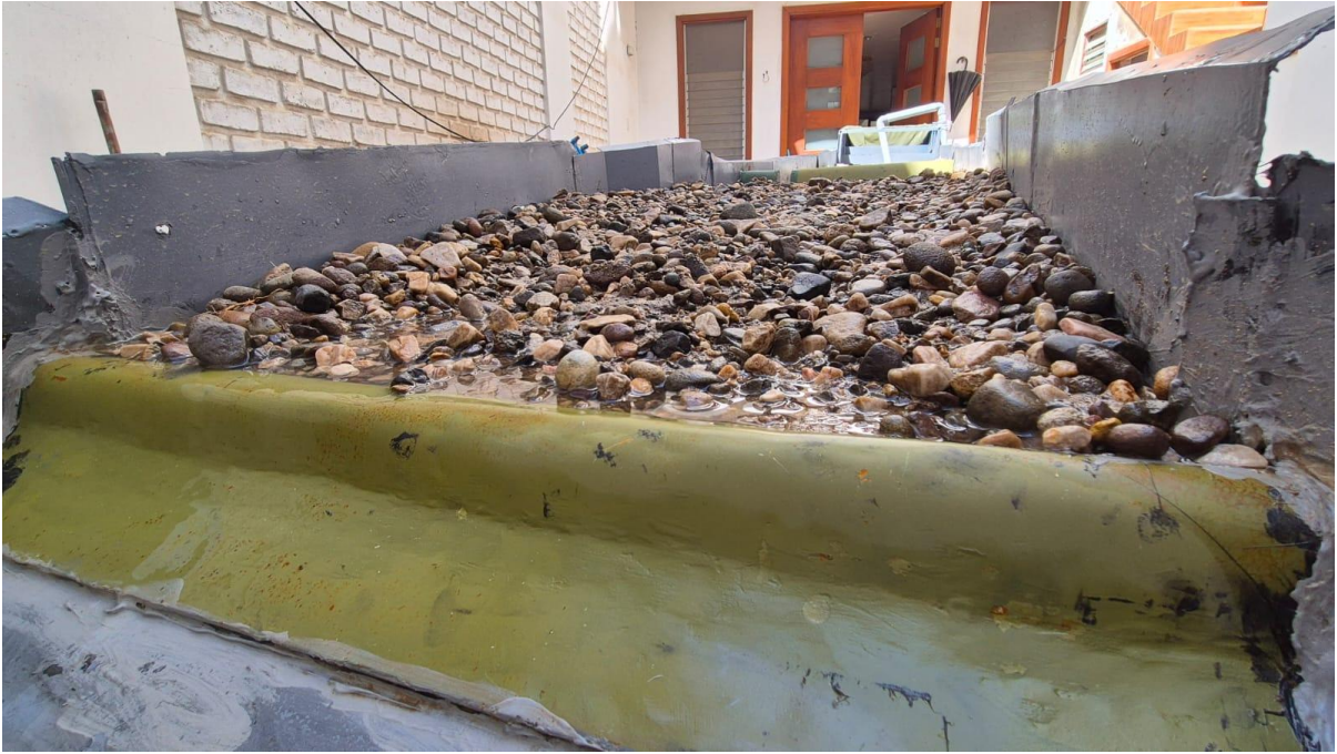
Figura 82: Vista de la captación para riego completamente obstruida por sedimentos arrastrados desde el barrage descolmatado.
