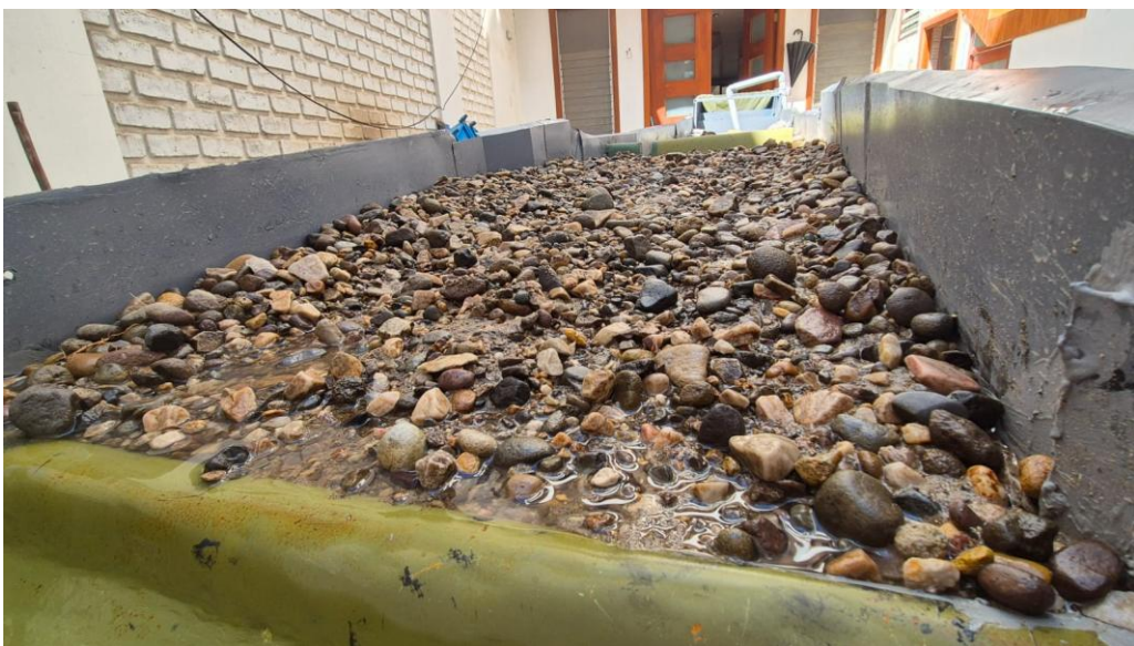
Figura 43: Colmatación total aguas arriba del barrage de la segunda captación tras la descolmatación inducida en la captación superior.
