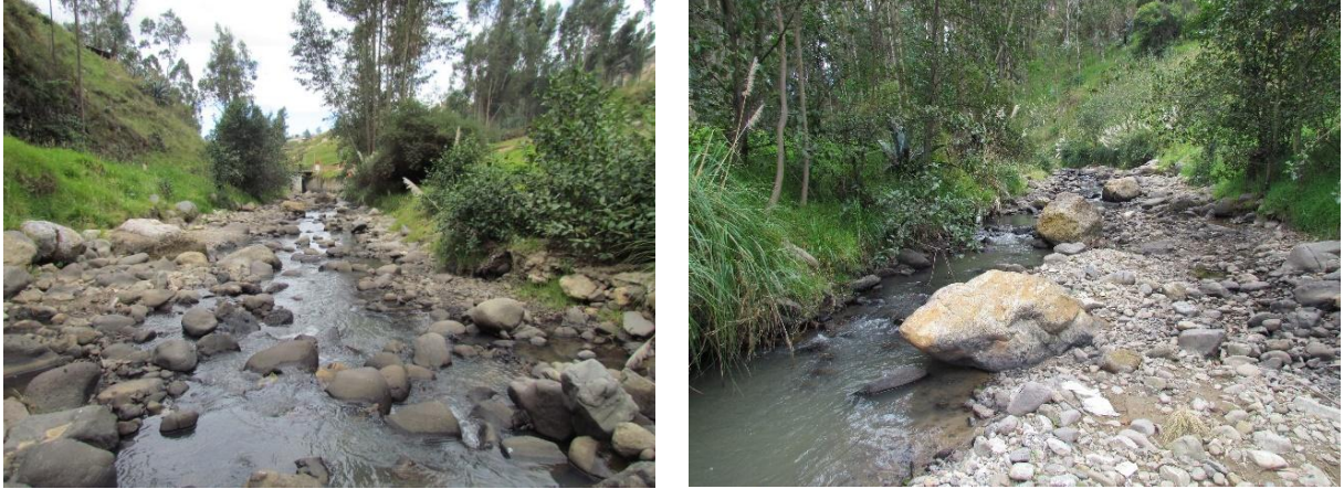
Figura 19: Colmatación aguas arriba del barrage de la captación derivadora.
