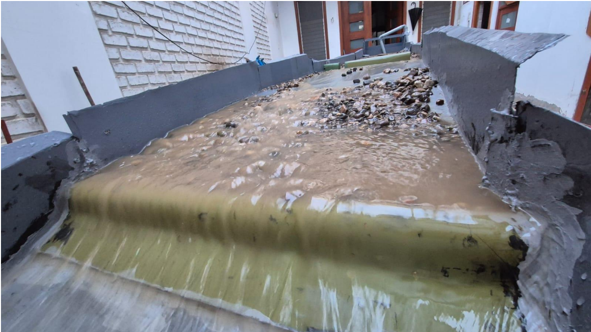
Figura 78: Efectos negativos en la segunda captación durante la descolmatación inducida.
