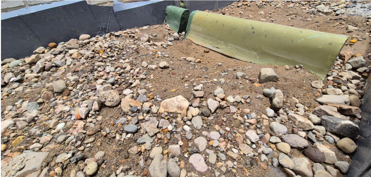
Figura 42: Acumulación de sedimentos en la poza disipadora posterior a la remoción inducida en la captación.
