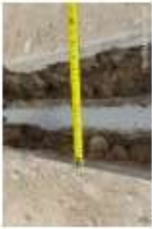
AFECTACIÓN POR LLUVIA
