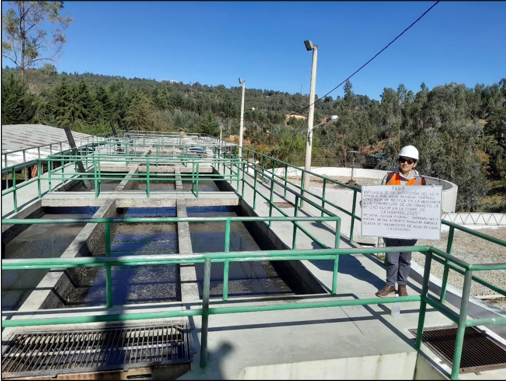
Planta de Tratamiento de Agua Residuales Parubamba en Cajabamba
