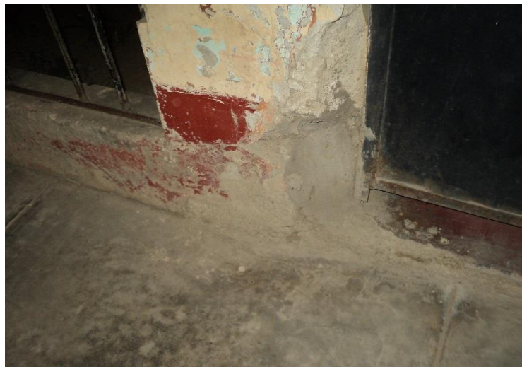
Figura N°14. Debilitamiento de elementos Estructurales
