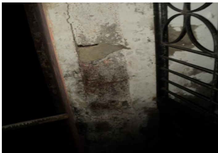
Fotografía 6. Vivienda con elementos estructurales (columnas) deterioradas.
