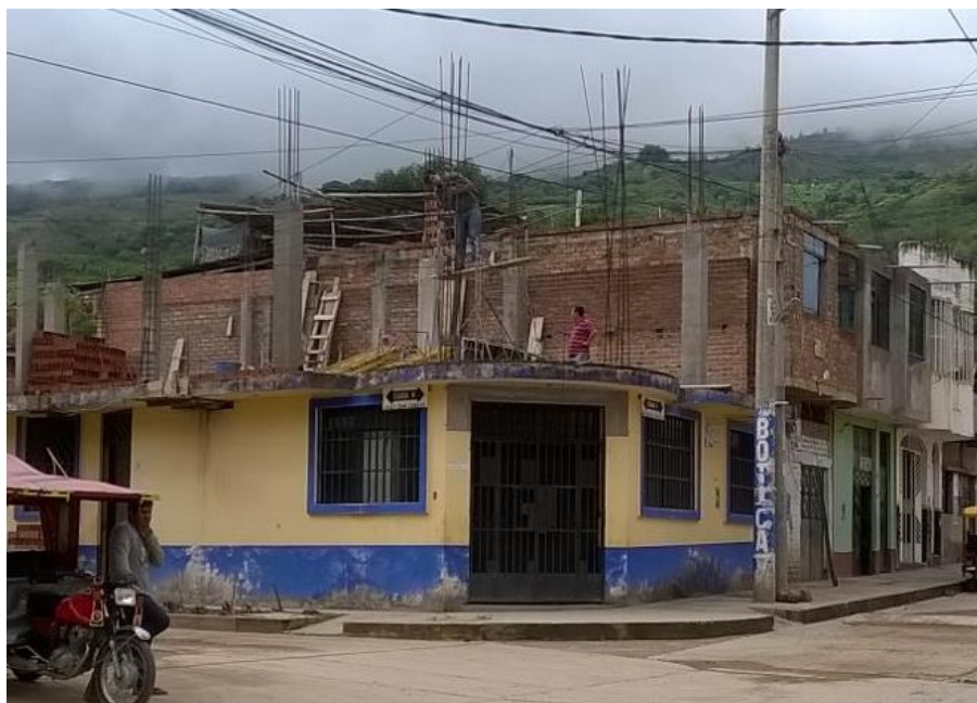
Figura N° 13. Armaduras expuestas y corroídas
