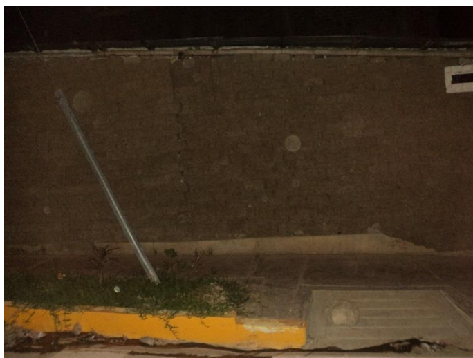
Fotografía 3. Vivienda de adobe, con rajaduras en las paredes.
