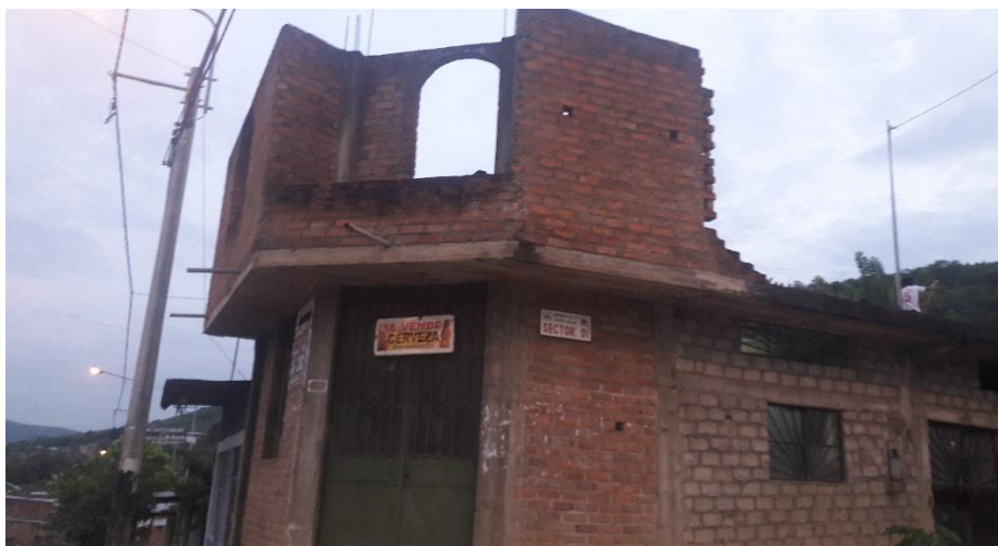
Figura N°10. Viviendas con Tabiquería no Arriostrada
