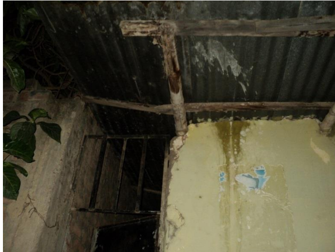
Fotografía 7. Vivienda de adobe, con vigas de madera y techos de calamina en mal estado, deteriorados por su antigüedad y por las lluvias.
