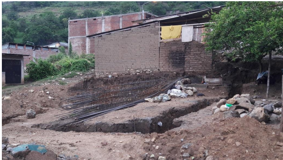
Figura N° 11. Mano de obra sin orientación técnica
