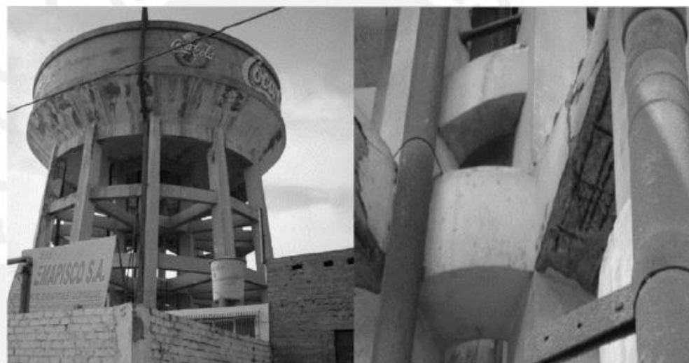
Fig. N° 05: Desprendimiento del recubrimiento de acero (Kuroiwa, 2012)
