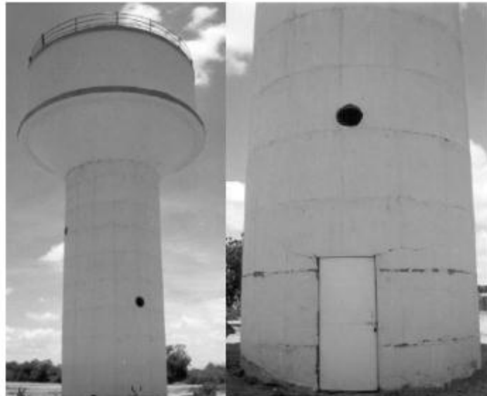
Fig. N° 04: Fisuras circunferenciales en la parte inferior del fuste (Rai, 2003)
