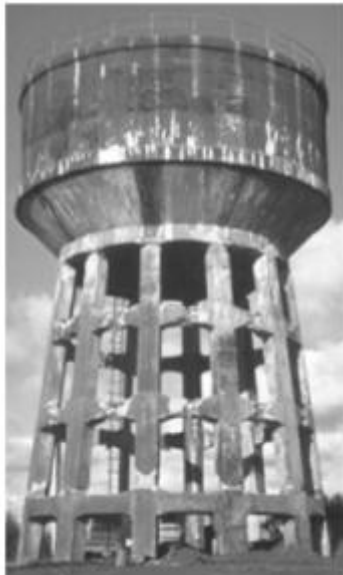
Fig. N° 03: Falla por corte en las vigas (Masoudi et al., 2012)
