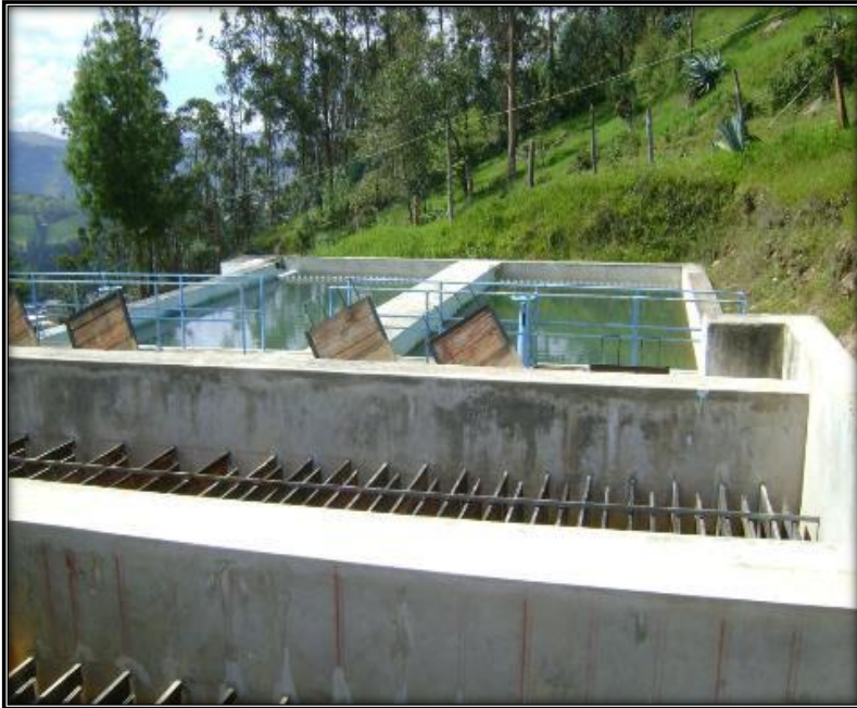
Figura 131: Mejoramiento de la Planta de Tratamiento de Agua Potable (PTAP) San Miguel. Concluido
