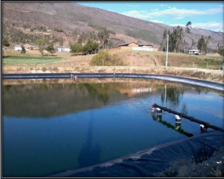
Figura 129: Laguna de PTAR Celendín. Concluido
