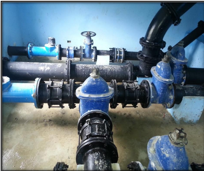
Figura 146: Caseta de válvulas en reservorio en la PTAP– Chota
