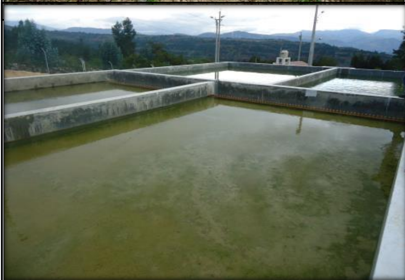
Figura 128: Planta de Tratamiento de Agua Potable (PTAP) de Cajabamba. Concluido y en operación.
