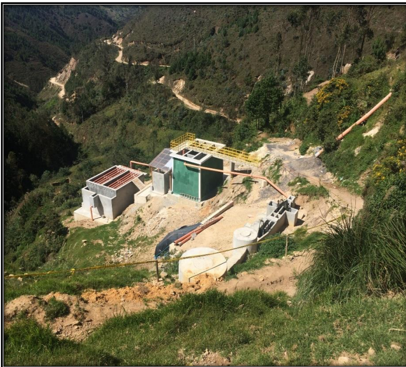
Figura 148: Tanque Imhof de la PTAR 2. Cutervo. Concluido.
