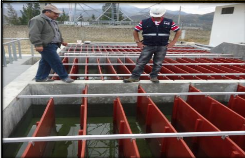
Figura 135: Floculadores horizontales de la Planta de Tratamiento de Agua Potable San Marcos.
