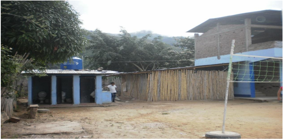
SS. HH., y aulas, anterior a las acciones de mantenimiento en la I. E. N° 16015 Rosario de Chingama “Red Educativa Forjadores del Nuevo Milenio de Chingama” Bellavista-Jaén, año 2010.
