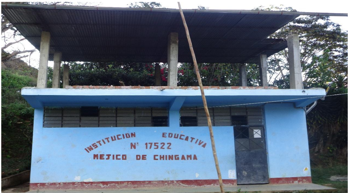
I.E. N° 17522 del caserío Méjico de Chingama, anterior a las acciones de mantenimiento año 2010.
