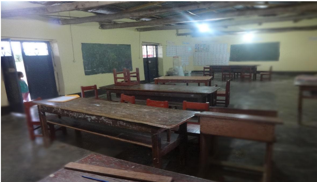
Interior de una aula con alumbrado eléctrico en la I.E. N° 16805 del caserío de Altamisa de Chingama, después de las acciones de mantenimiento, año 2014.
