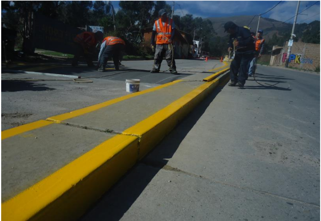
Toma fotográfica N° 11: Verificación de ubicación de dispositivos de control (Marcas en Pavimento)
