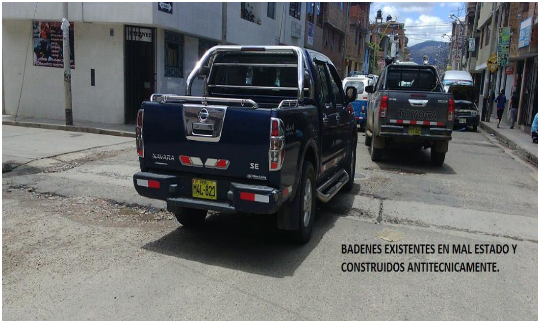
Toma fotográfica N° 10: Se observa que en todo el tramo Av. Mártires de Uchuracay existen 13 Badenes, los que están en mal estado y que dificultan la circulación de este sector.
