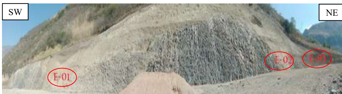
Foto 8. Estaciones de control geodinámicas tomadas en el Deslizamiento el Naranjo.
