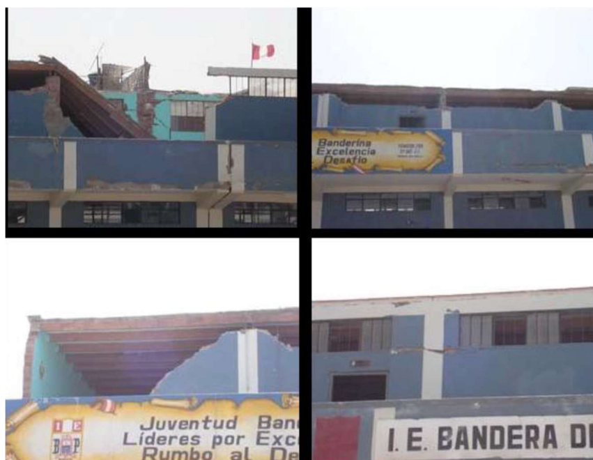
Figura 3.12 Terremoto de Pisco 2007. Institución Educativa con daños severos en la estructura, por falla en las columnas y los muros.
