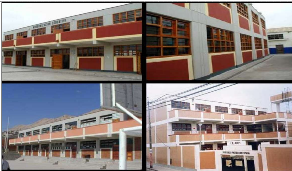
Figura 3.10 Terremoto de Atico, 2001. Colegio Infes sin daños. Tiene columnas rígidas en la dirección del corredor y muros estructurales en la dirección transversal.
