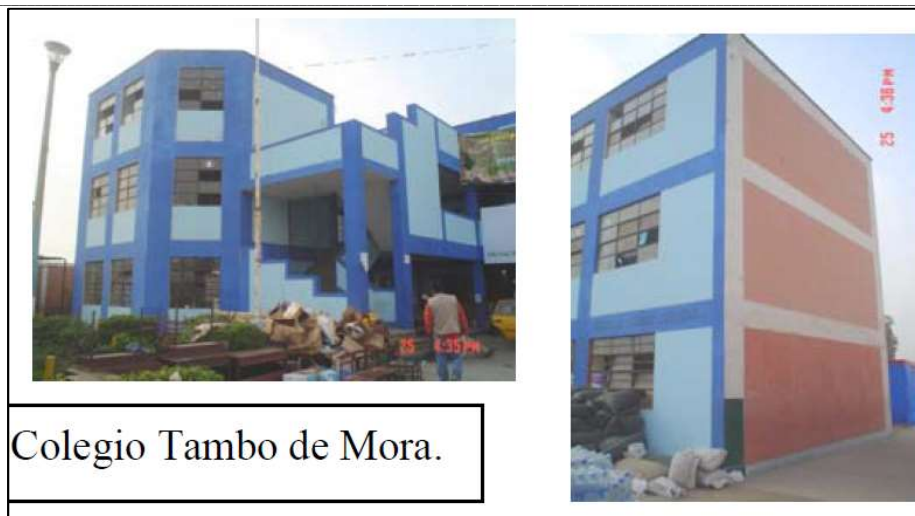
Figura 3.11 Terremoto de Pisco 2007. Colegio Tambo de Mora donde se presentan pequeñas fisuras en los muros de albañilería.
