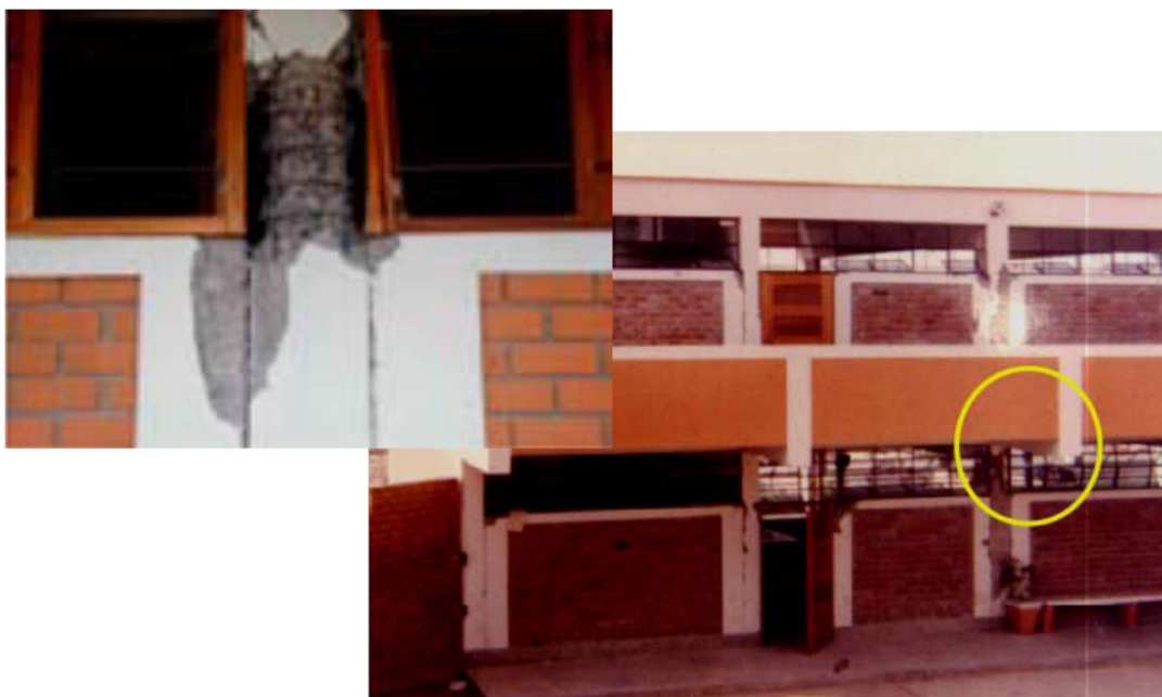
Figura 3.13 izquierda: falla por columna corta (con estribos) 3/8" a 0.10 m, C.E. Camaná – Terremoto 2001. Derecha: falla por columna corta sin estribos, C.E. Fermín del Castillo – Terremoto Nazca 1996.
