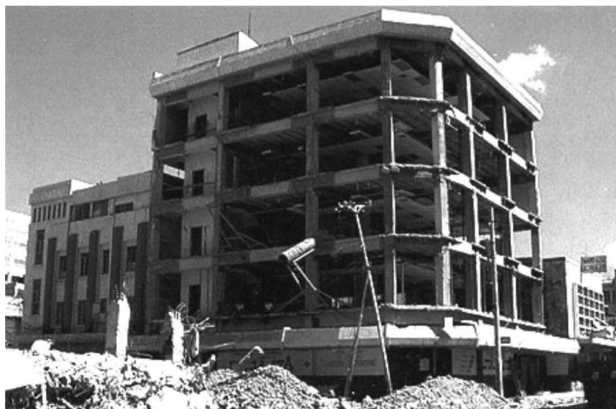
Imagen 3.1 Comportamiento dúctil de un edificio de hormigón reforzado, donde se aprecia la formación de rótulas en las vigas.
