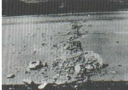
Figura 06. Blowup / Buckling de severidad media.
