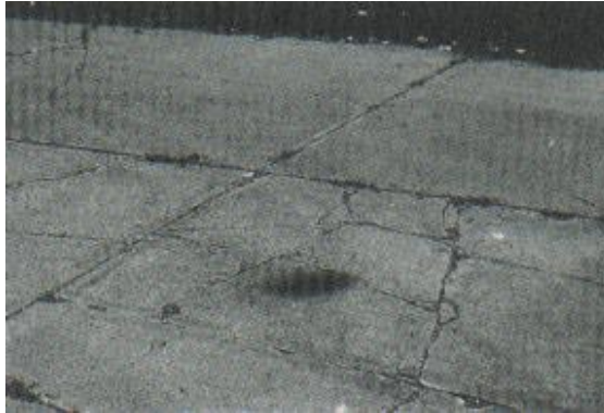
Figura 13. Losa dividida de alta severidad.
