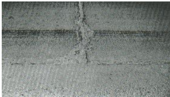
Figura 49. Descascaramiento de esquina de severidad media. Fuente: Traducción del libro de Shahin, M. Y. "Pavement Management for Airports Roads and Parking Lots". 2005
