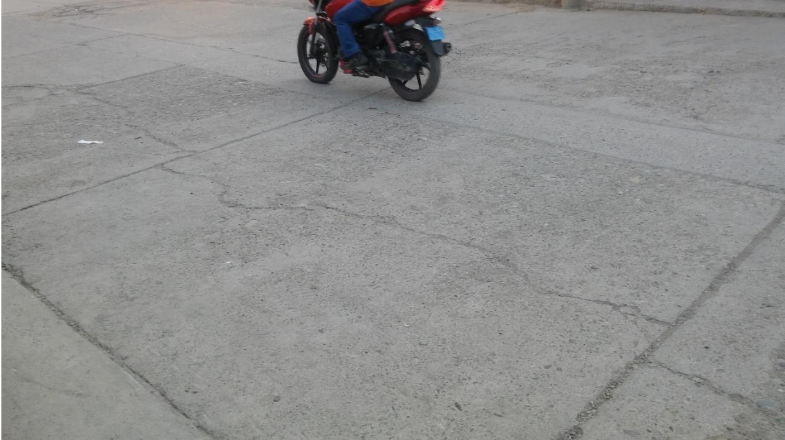
Figura 86. Inspección de una grieta lineal de severidad media.
