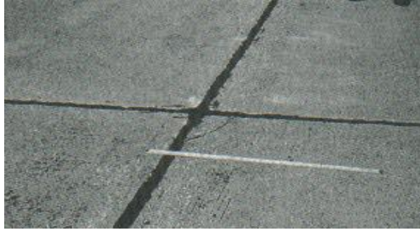
Figura 48. Descascaramiento de esquina de baja severidad. Fuente: Traducción del libro de Shahin, M. Y. "Pavement Management for Airports Roads and Parking Lots". 2005
