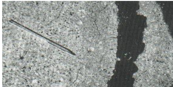
Figura 14. Grieta de durabilidad de baja severidad
