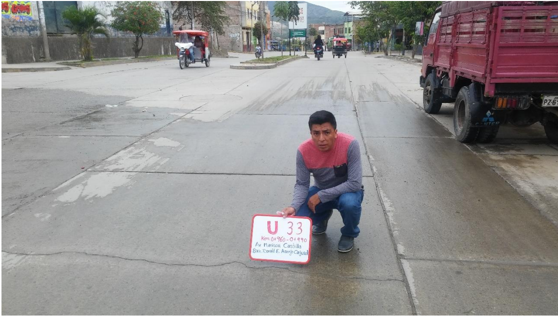
Figura 94. Inspección de la falla grieta longitudinal de severidad media.
