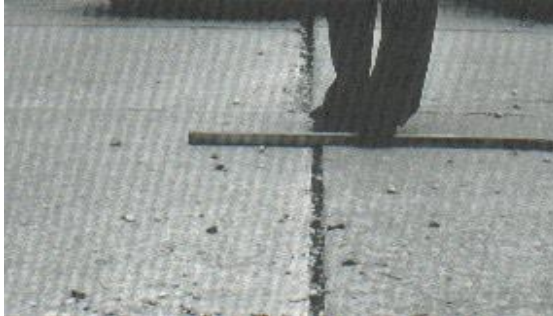
Figura 17. Escala de baja severidad.
