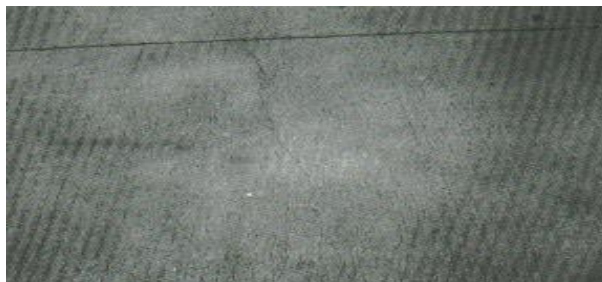
Figura 47. Grietas de contracción.
