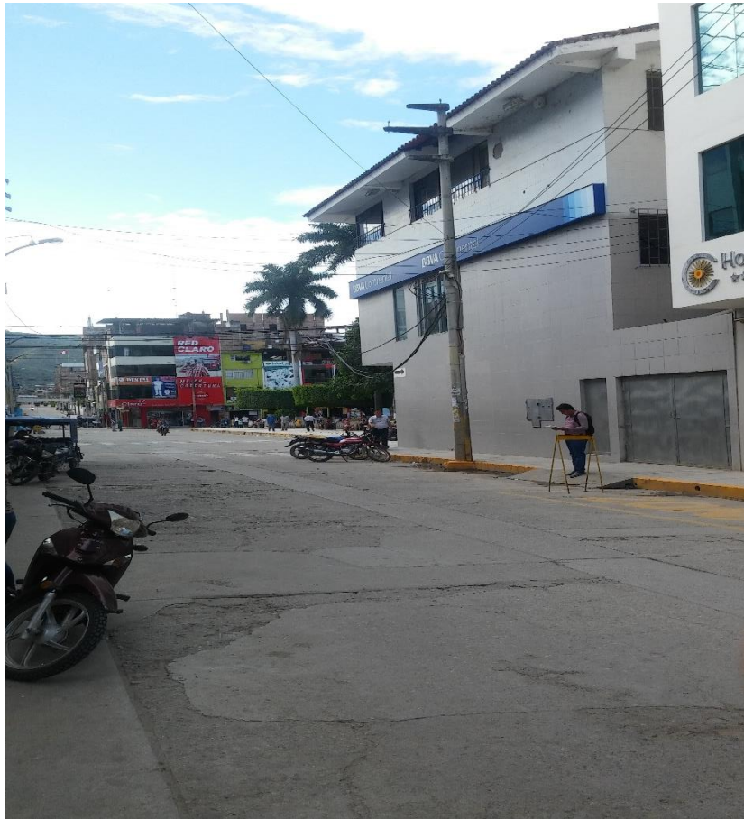
Figura 84. Inspección de las fallas presentes en el pavimento, inicio de la vía Av. Mariscal Castilla.
