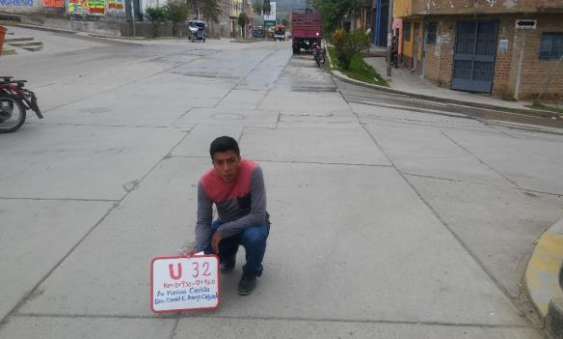
Vista de la unidad 32 entre el km 0+930 - 0+960, visualización de fallas.
