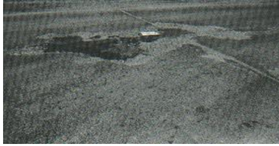
Figura 46. Desconchamiento / Mapa de grietas / Craquelado de alta severidad. Fuente: Traducción del libro de Shahin, M. Y. "Pavement Management for Airports Roads and Parking Lots". 2005
