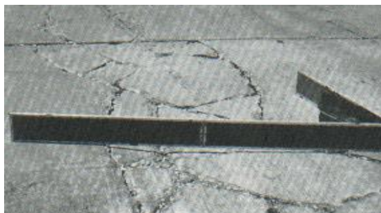
Figura 40. Punzonamiento de alta severidad.
