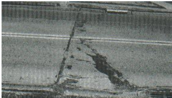
Figura 39. Punzonamiento de severidad media.
