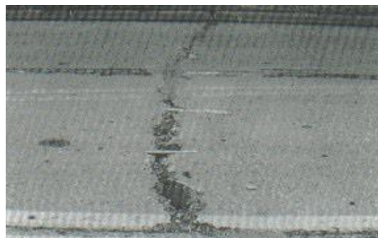
Figura 28. Grietas lineales de alta severidad en losa de concreto simple. Fuente: Traducción del libro de Shahin, M. Y. "Pavement Management for Airports Roads and Parking Lots". 2005
