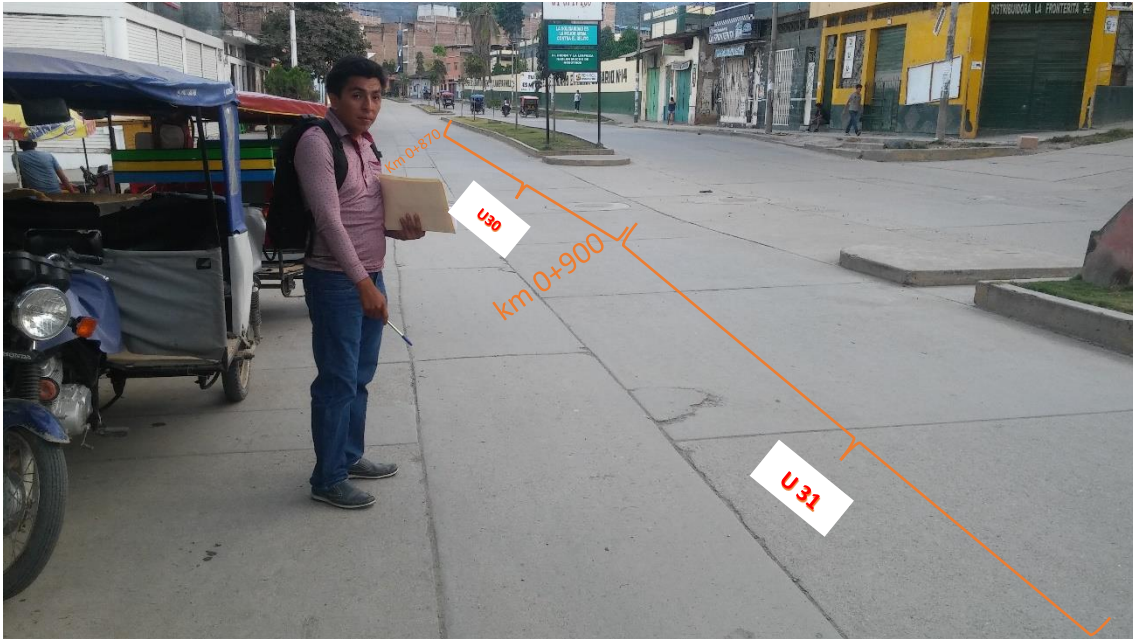
Figura 96. Inspección de las fallas entre la U30 y U31.
