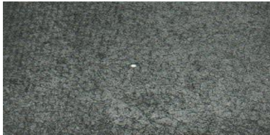
Figura 44. Desconchamiento / Mapa de grietas / Craquelado de baja severidad.
