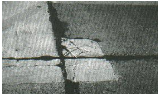
Figura 33. Parche pequeño de severidad media.
