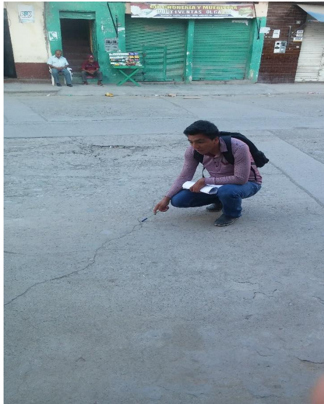
Figura 90. Inspección de la falla grietas longitudinales.
