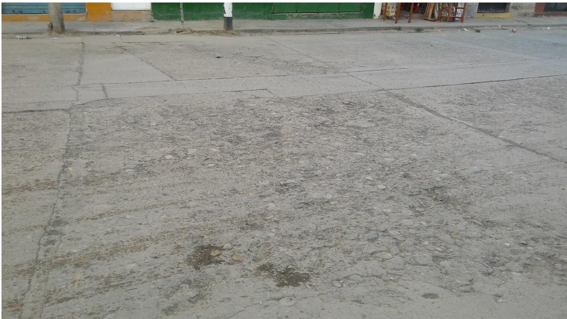
Figura 91. Inspección de la falla desconchamiento, mapa de grietas, craquelado de severidad alta
