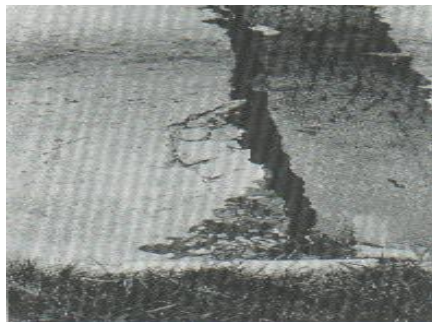
Figura 05. Blowup / Buckling de baja severidad.
