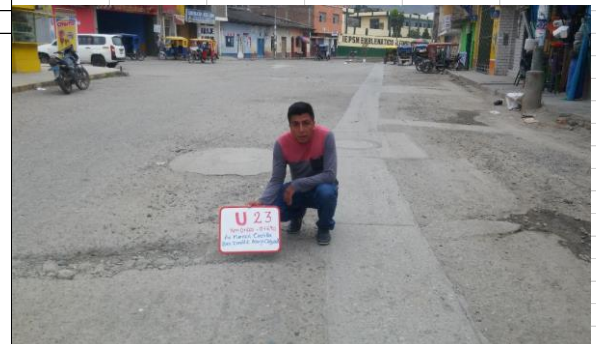
Vista de la unidad 23 entre el km 0+660 - 0+690, visualización de fallas.
