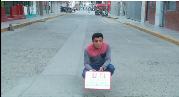
vista de la unidad 01 entre el km 0+000-0+030, visualización de las fallas.
