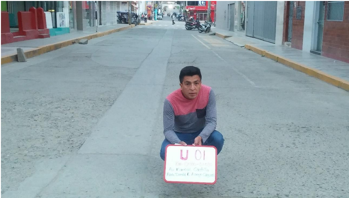
Figura 82. Muestreo del pavimento, inicio de vía (U 01) en el km 0+000 – 0+030, tramo 01 en la avenida Mariscal Castilla.
