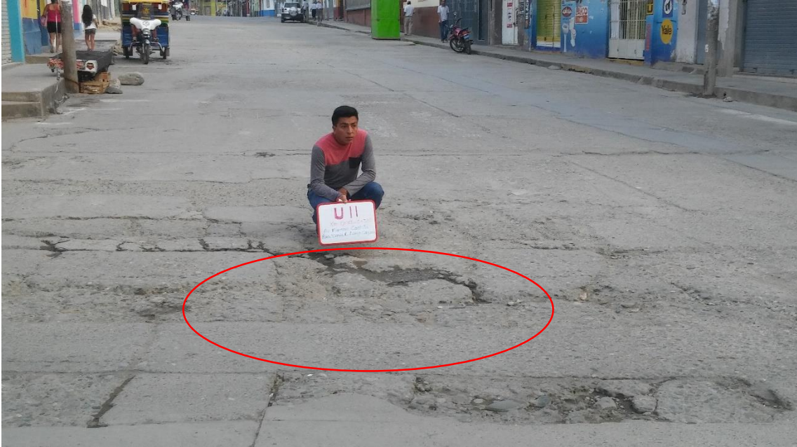
Figura 88. Inspección de la falla Losa Dividida de severidad alta, en la unidad 11 entre el km 0+300-0+330.
