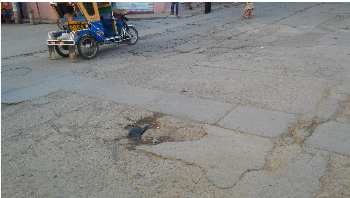
Figura 87. Inspección de la falla Parqueo Grande de severidad alta.
