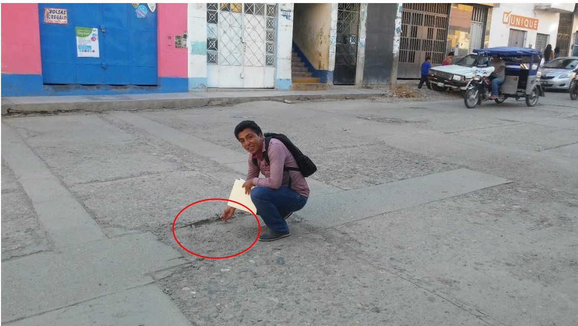
Figura 89. Inspección de la falla Escala de severidad alta.
