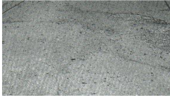
Figura 16. Grieta de durabilidad de alta severidad. Fuente: Traducción del libro de Shahin, M. Y. "Pavement Management for Airports Roads and Parking Lots". 2005.
