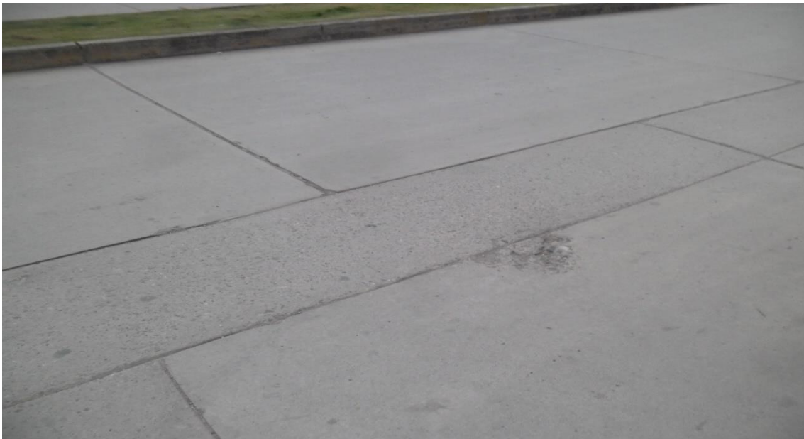
Figura 95. Inspección de la falla más representativa en el tramo 02, desconchamiento y parcheo grande de severidad leve.
