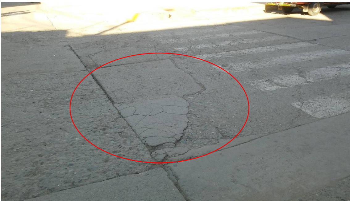
Figura 85. Presencia de la falla Grieta de Esquina en la avenida Mariscal Castilla.
