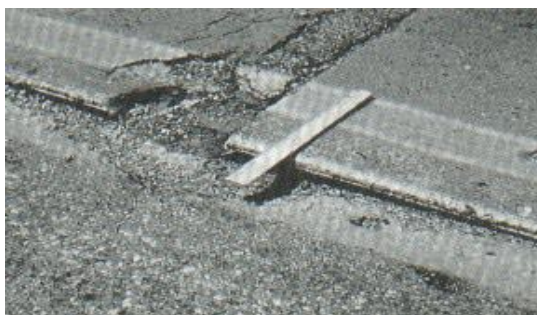
Figura 23. Desnivel carril / berma de baja severidad.
