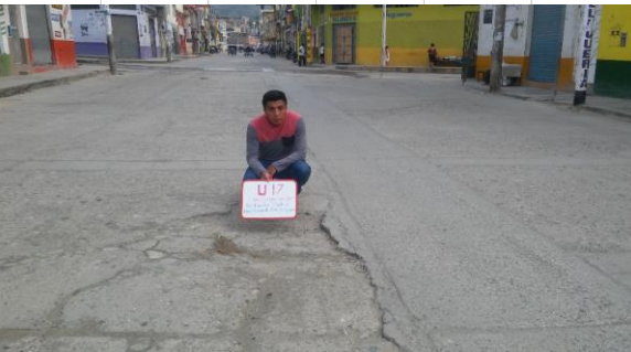
Vista de la unidad 17 entre el km 0+480 - 0+510, visualización de fallas.
