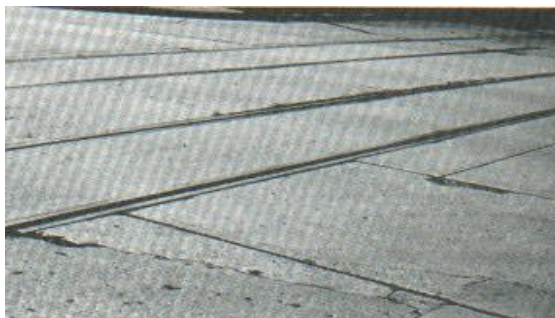
Figura 41. Cruce de vía férrea de baja severidad.
