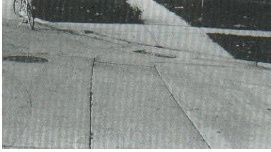
Figura 29. Parche grande y acometidas de servicios públicos de baja severidad. Fuente: Traducción del libro de Shahin, M. Y. "Pavement Management for Airports Roads and Parking Lots". 2005
