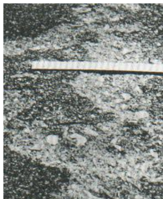
Figura45. Desconchamiento / Mapa de grietas / Craquelado de severidad media.
