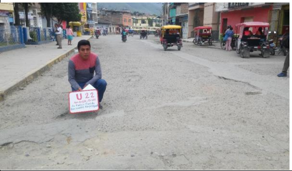
Vista de la unidad 22 entre el km 0+630 - 0+660, visualización de fallas.
