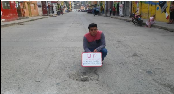
Vista de la unidad 19 entre el km 0+540 - 0+570, visualización de fallas.
