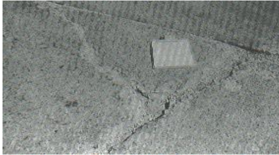
Figura 10. Grieta de esquina de alta severidad.
