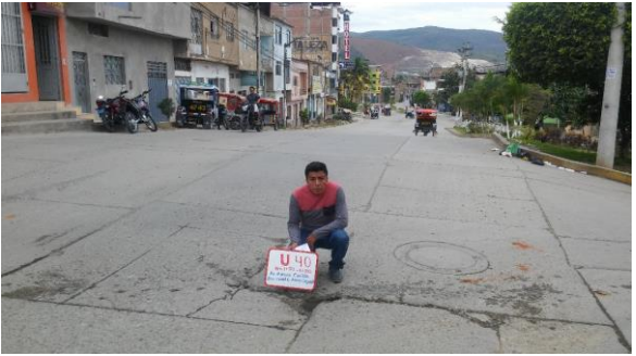
Vista de la unidad 40 entre el km 1+170 - 1+200, visualización de fallas.
