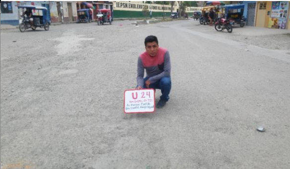
Vista de la unidad 24 entre el km 0+690 - 0+720, visualización de fallas.
