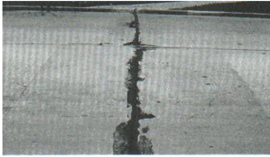
Figura 20. Daño del sello de junta de baja severidad. Fuente: Traducción del libro de Shahin, M. Y. "Pavement Management for Aiports Roads anad Parkink Lots". 2005.
