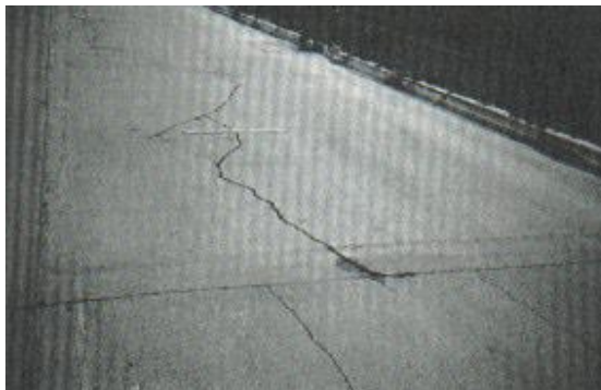
Figura 12. Losa dividida de severidad media.
