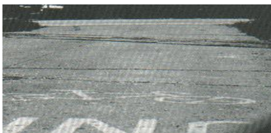
Figura 42. Cruce de vía férrea de severidad media. Fuente: Traducción del libro de Shahin, M. Y. "Pavement Management for Airports Roads and Parking Lots". 2005
