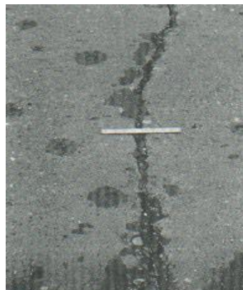
Figura 27. Grietas lineales de severidad media en losa de concreto reforzado. Fuente: Traducción del libro de Shahin, M. Y. "Pavement Management for Airports Roads and Parking Lots". 2005
