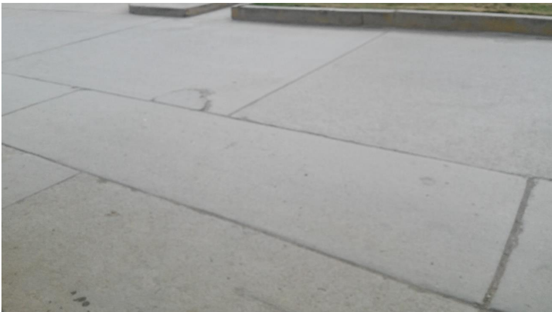
Figura 93. Inspección de la falla parcheo pequeño de severidad leve.
