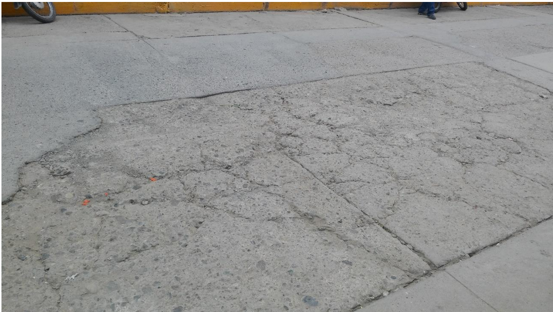
Figura 97. Inspección de falla parcheo grande, desconchamiento, losa dividida.
