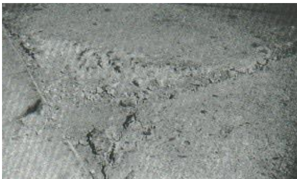
Figura 50. Descascaramiento de esquina de alta severidad Fuente: Traducción del libro de Shahin, M. Y. "Pavement Management for Airports Roads and Parking Lots". 2005
