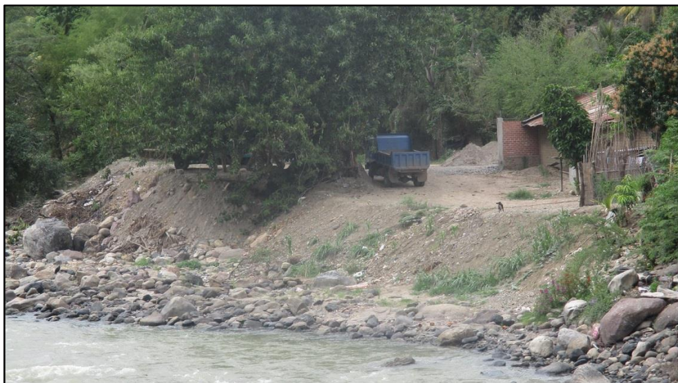
Figura 53: Rellenos indiscriminados en el cauce, donde se cimentan edificaciones e incrementan el riesgo.
