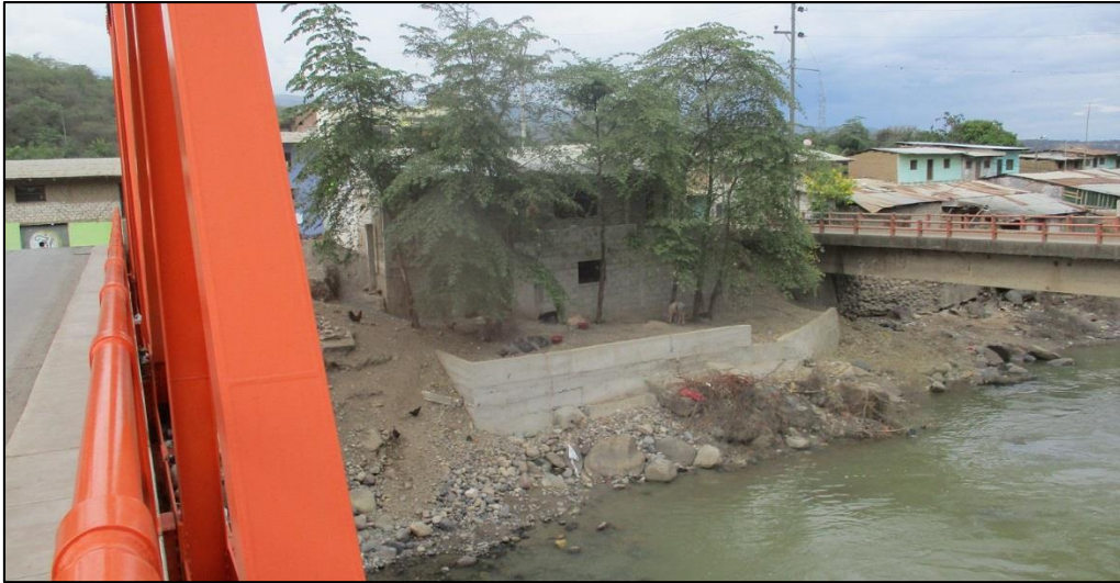
Figura 63: Viviendas margen izquierda en riesgo de inundación y colapso, construcción en rellenos.
