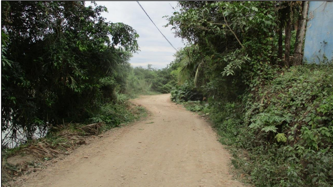
Figura 73: Acceso en la margen derecha afectados por inundaciones aguas abajo.
