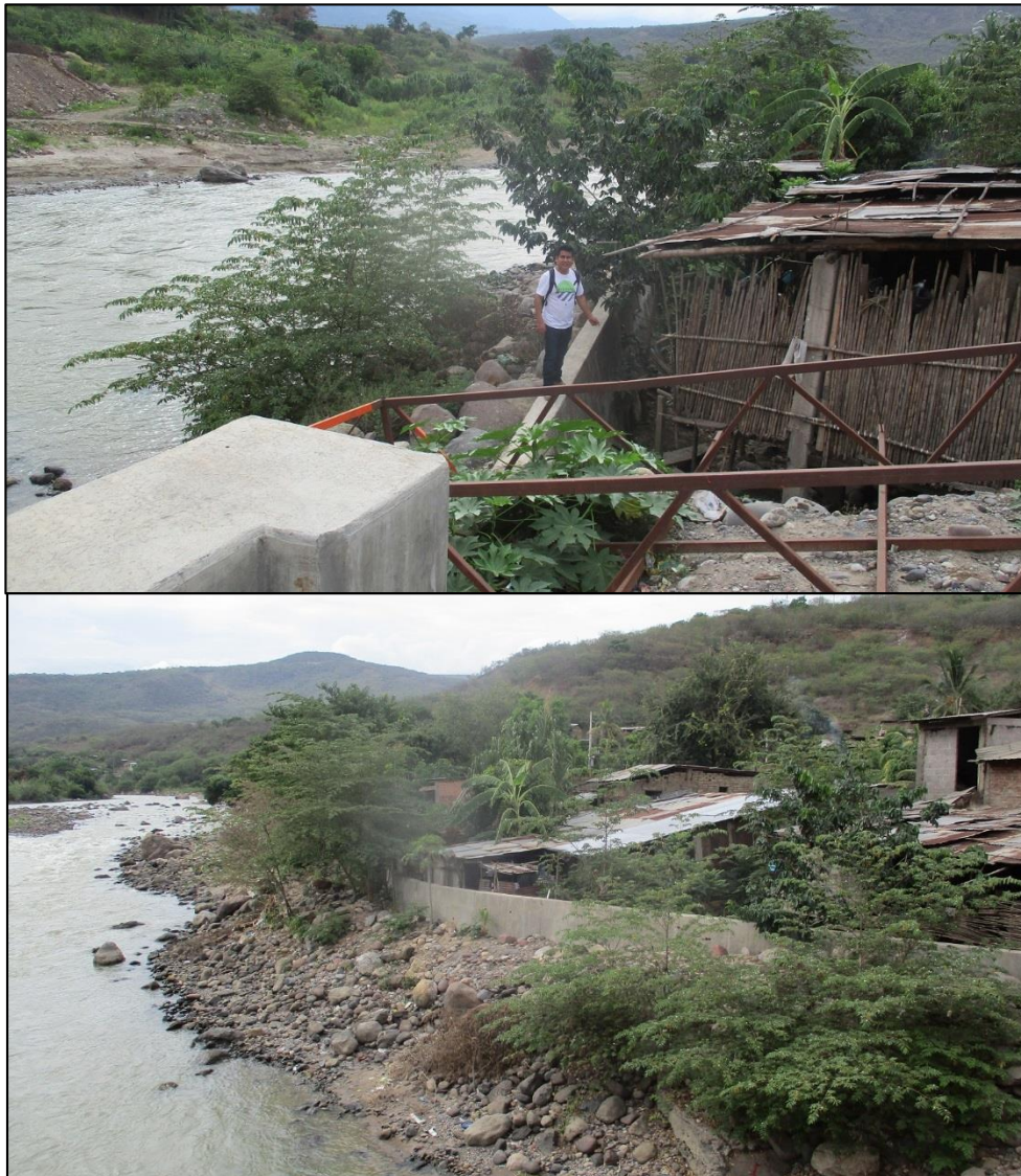
Figura 64: Viviendas margen izquierda vulnerable a inundación, zona para ejecutar encimado de gaviones.
