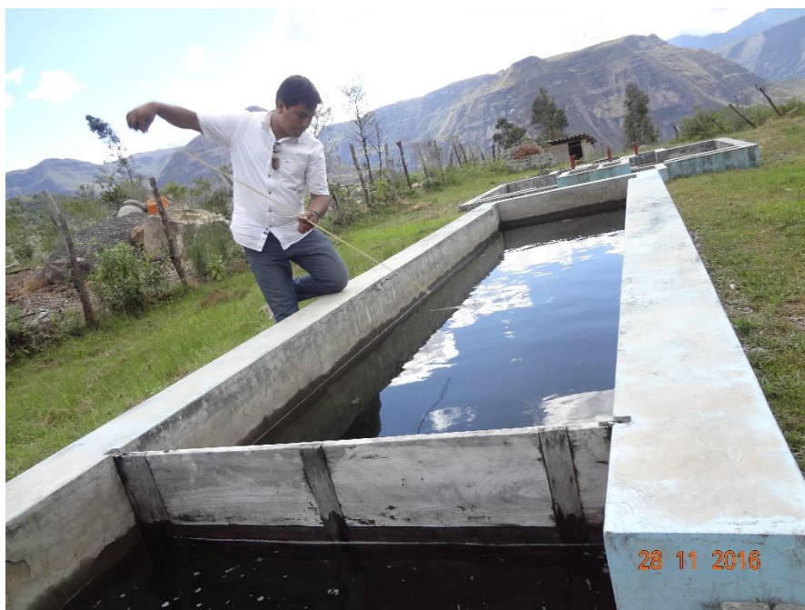
FOTO N° 21: verificando el filtro lento
