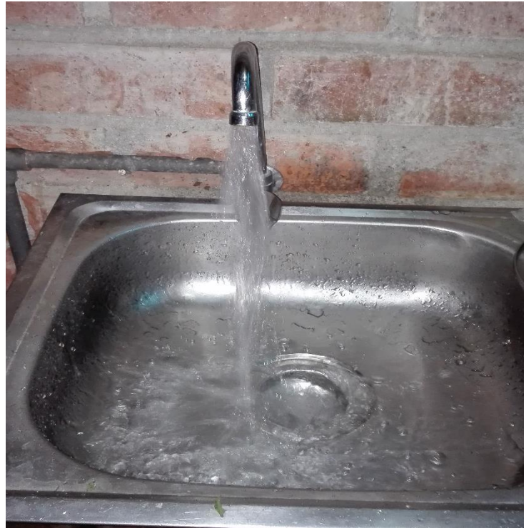
FOTO N° 8: vista de la presión de agua que llega a los grifos domésticos.
