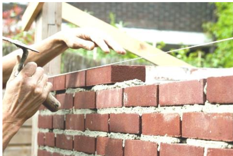
Figura 8: Una de las aplicaciones del aditivo hidrófugo es en el asentado de primeras hileras de ladrillo.
