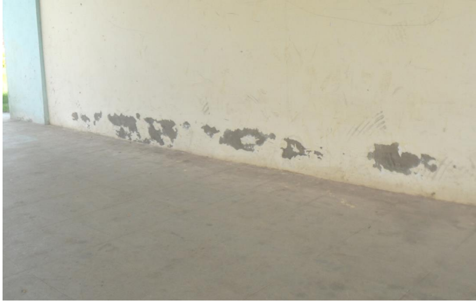
Figura 12: Presencia de humedad por ascensión capilar de las bases del muro. Fuente: Propia
