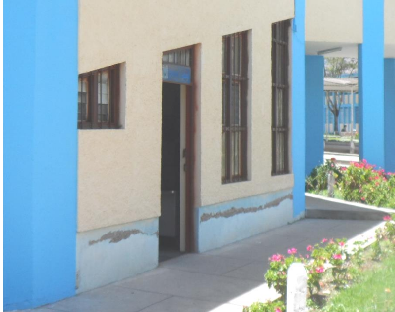
Figura 11: Humedad en edificación pública.
