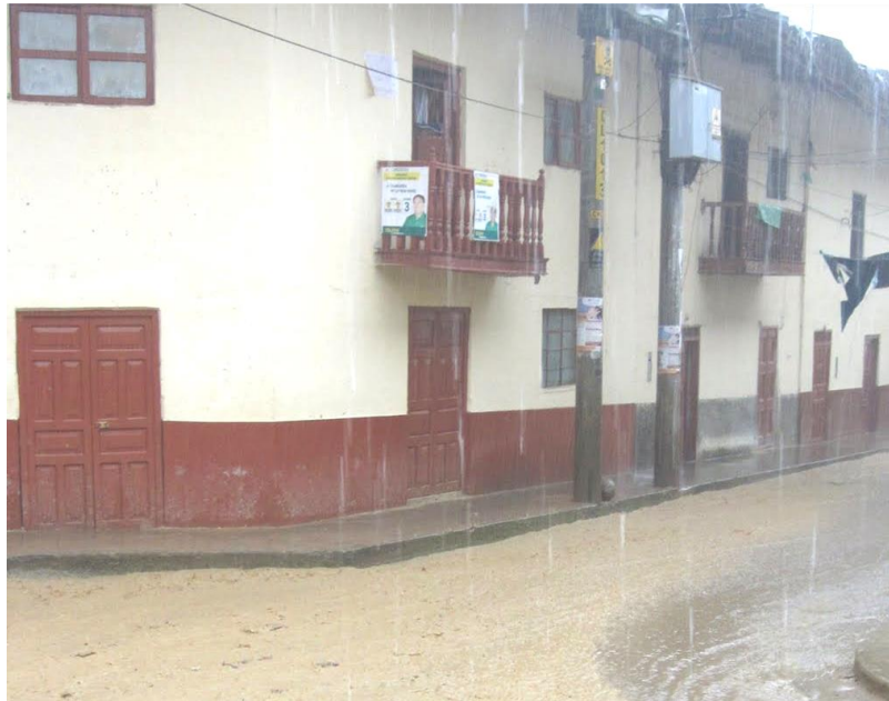
Figura 1: Las precipitaciones pluviales en Cajamarca, son una de las fuentes de humedad en revestimientos.
