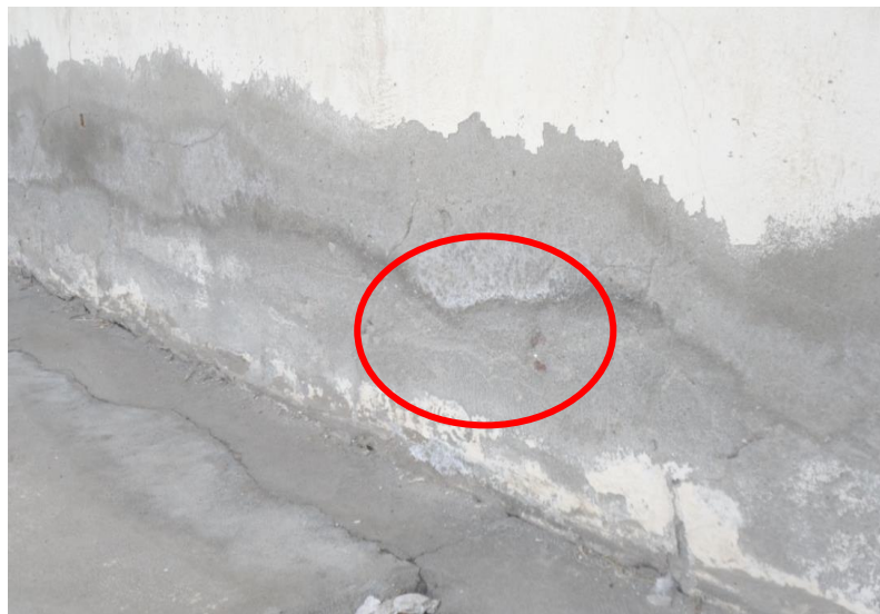
Figura 13: Presencia de eflorescencia en revestimiento cemento / arena, por causa de la humedad.
