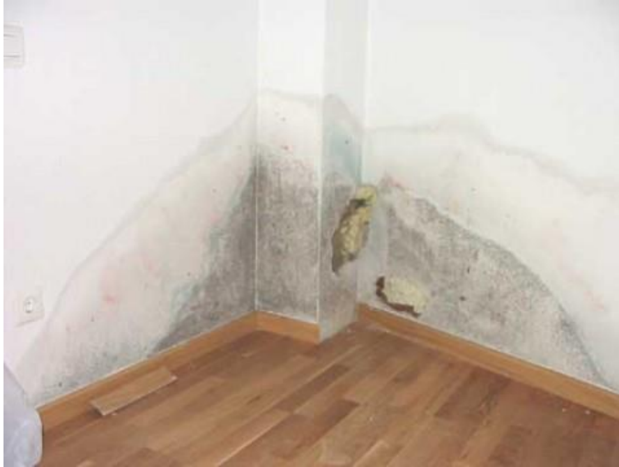
Figura 2: Efecto de la humedad, en muros.
