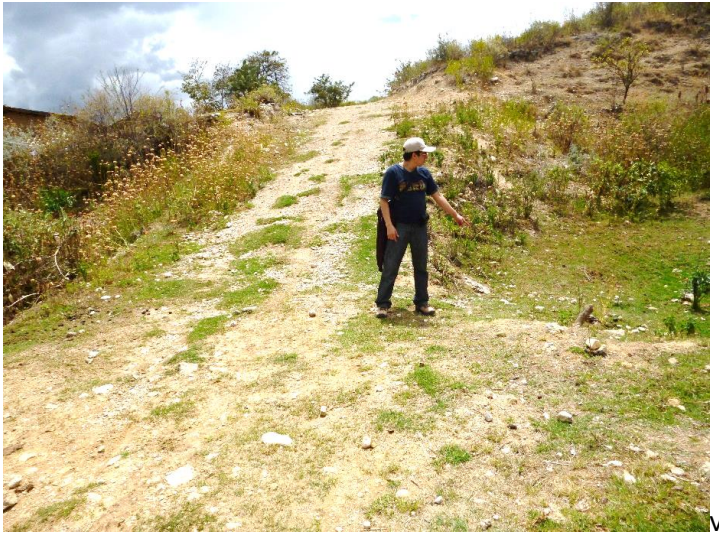
Fotografía N° 09 (izq). Cruce de carretera en una pequeña quebrada. Km 4+129. Nótese la ausencia de alcantarilla para el flujo de agua ocasionando erosión y acumulación de agua en la parte superior.
