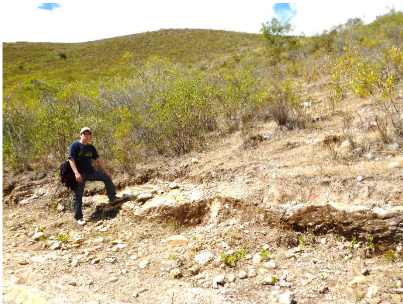
Fotografía N° 08. Erosión en ladera, a un costado de la vía en estudio en el Km 3+886. Se aprecia la erosión causada por el agua el viento a los taludes de la carretera.
