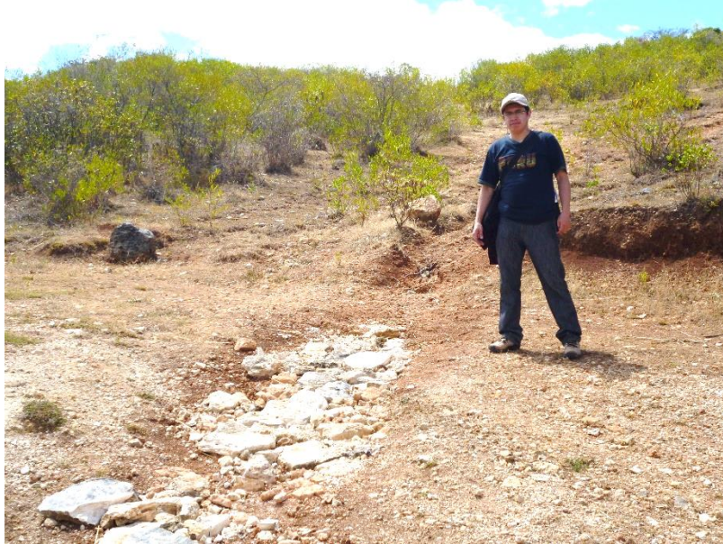
Fotografía N° 07. Dren existente para cruce de aguas en Km 3+335, en el cual se aprecia la ausencia de mantenimiento en este punto.
