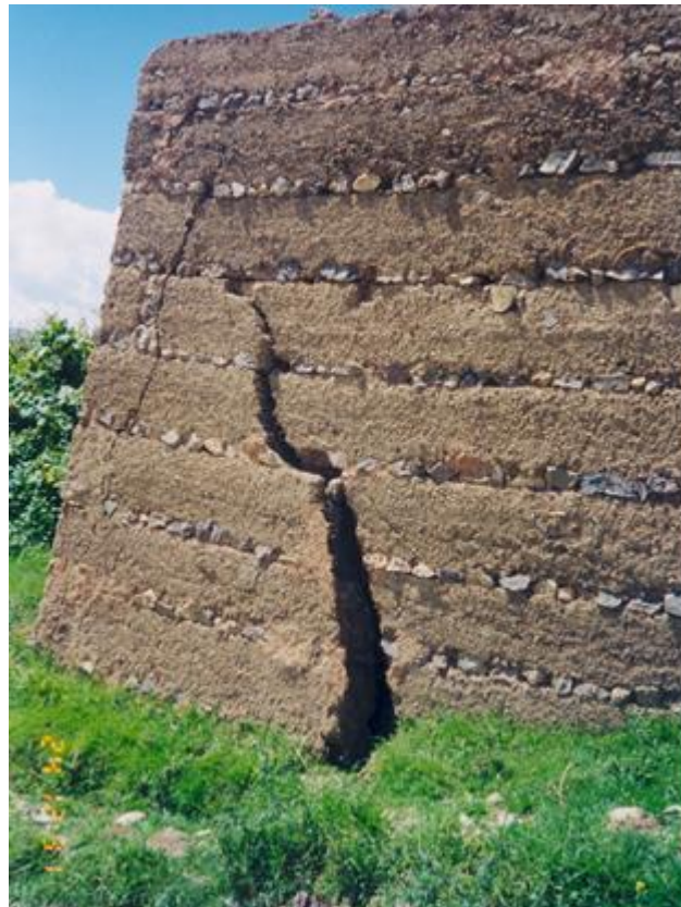
Figura 36. Fallas en viviendas producido por asentamientos
