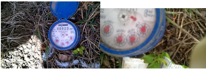
Fotos 2 y 3. Medidor de agua, control de caudal al ingreso de los biorreactores
