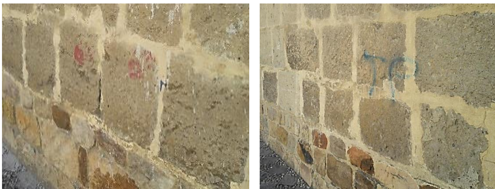
Figura 45: Acciones incívicas (esmalte y grafitis), en las paredes de la iglesia Belén del centro histórico de la ciudad de Cajamarca.
