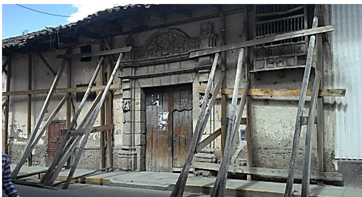
Figura 59: Casona Toribio Casanova, modificada estructuralmente y declarada patrimonio monumental, ubicada en el Jr. José Gálvez, del centro histórico de Cajamarca.
