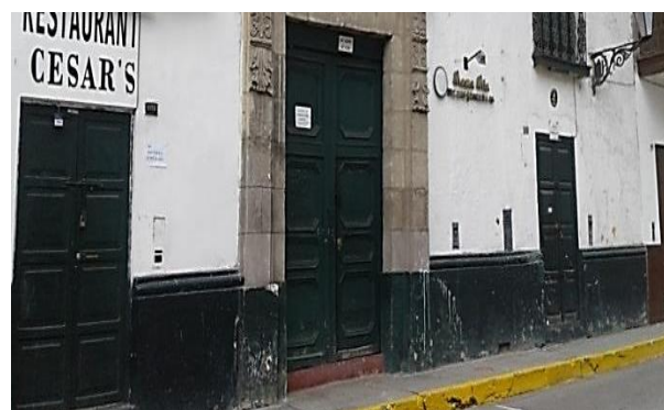
Figura 53: Acciones incívicas, en las paredes de la Casona Montoya, ubicada en el Jr. Junín N°1160 del centro histórico de la ciudad de Cajamarca.
