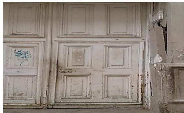
Figura 51: Acciones incívicas, en la puerta de la casona Santolalla, ubicada en el Jr. El Comercio del centro histórico de la ciudad de Cajamarca.
