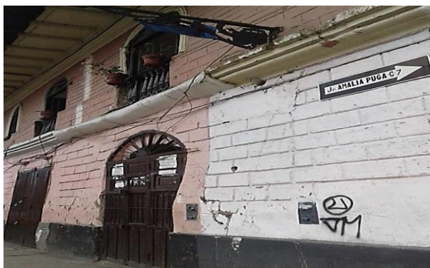
Figura 50: Acciones incívicas, en las paredes de la Casa Rosada, ubicada en el Jr. Amalia Puga del centro histórico de la ciudad de Cajamarca.
