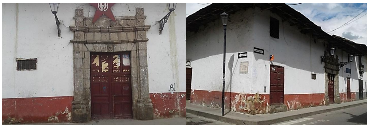
Figura 41: Desechos orgánicos (orina), en la portada de la casa de Santiago Losno, hoy casa del Pueblo, ubicado en las calles Jr. Amalia Puga y Jr. Tarapacá del centro histórico de la ciudad de Cajamarca.
