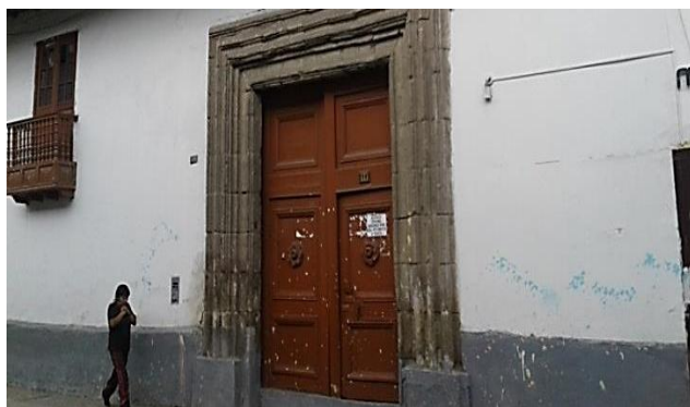
Figura 52: Acciones incívicas, en la fachada de la casona del coronel Miguel Iglesias, del centro histórico de la ciudad de Cajamarca.
