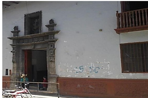
Figura 49: Acciones incívicas (grafitis), en las paredes de la I.E. La Merced, ubicada en Jr. Junín Centro Histórico de la ciudad de Cajamarca
