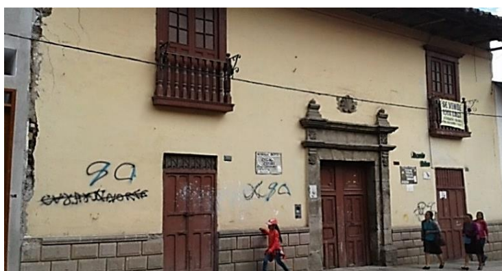
Figura 47: Acciones incívicas (grafitis), en las paredes de la casa Gregorio Zevallos, ubicada en el Jr. José Gálvez N ° 757 – 761, del Centro Histórico de la ciudad de Cajamarca.
