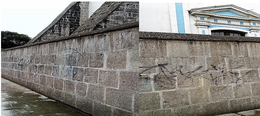
Figura 46: Acciones incívicas (grafitis), en el atril de la iglesia Concepcionista, ubicada entre las calles de Jr. Junín y Jr. Apurímac del centro histórico de la ciudad de Cajamarca.
