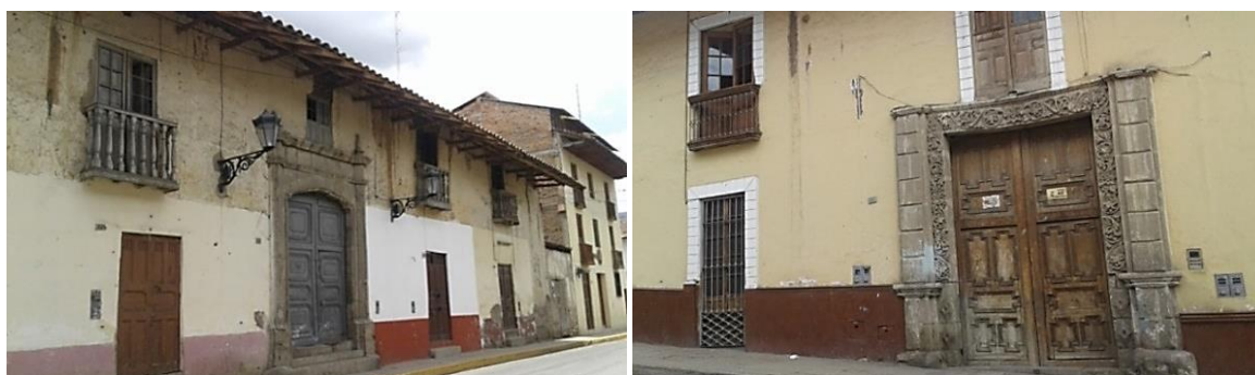
Figura 60: A la derecha Casona Pastor ubicada en el Jr. Junín y a la Izquierda Casona Alva, ubicada en el Jr. Dos de Mayo, portadas modificadas y abandonadas, declaradas Patrimonio Monumental, del centro histórico de Cajamarca.
