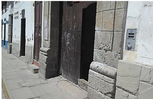
Figura 48: Acciones incívicas, (pintura) en la puerta de la Casa Bolívar, ubicada en el Jr. Apurímac N° 652 Centro de la ciudad de Cajamarca.
