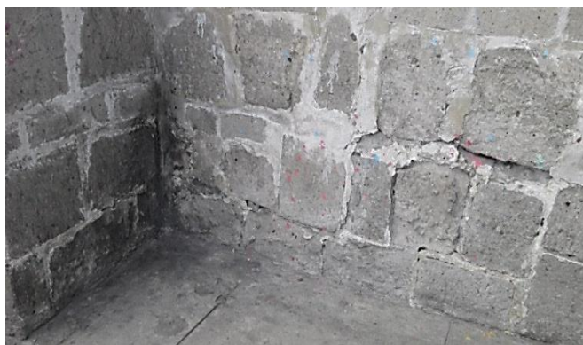
Figura 40: Desechos orgánicos (orina), en las paredes de la iglesia La Recoleta, del centro histórico de la ciudad de Cajamarca.
