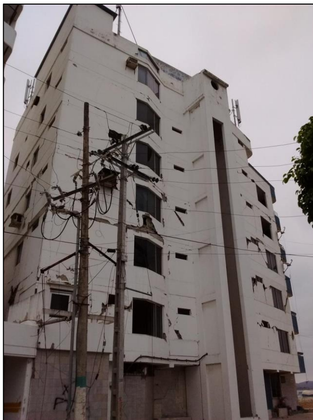
Fig. N. 11 Daños por tracción diagonal en muros de mampostería del edificio Nautilus- Ecuador
