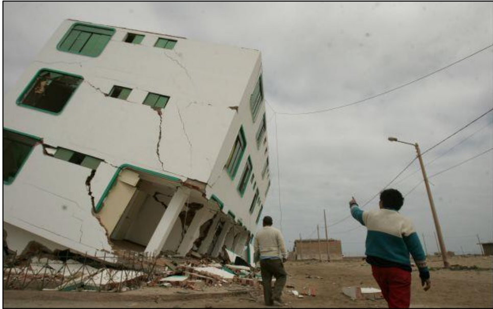
Fig. N° 05: Colapso de una vivienda autoconstruida por el terremoto en pisco del 2007.
