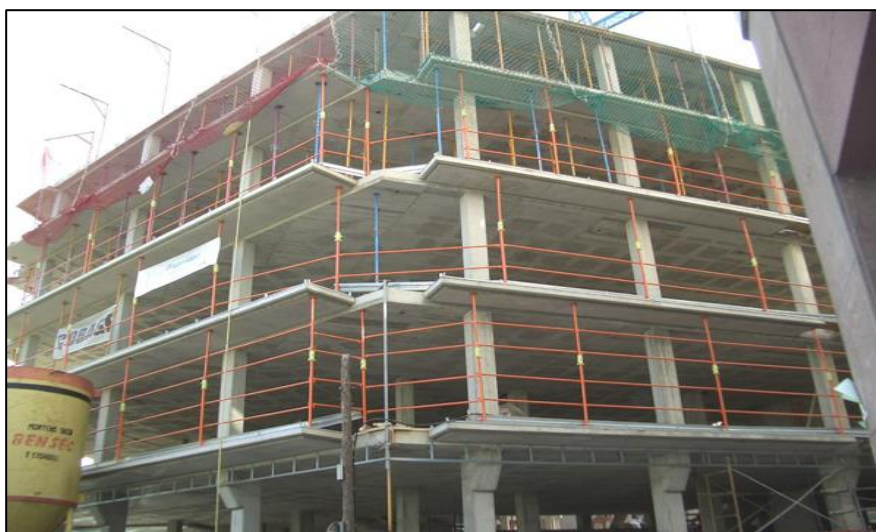
Fig. N° 13: En la imagen se muestra el proceso constructivo de un Edificio de un sistema aporricado.
