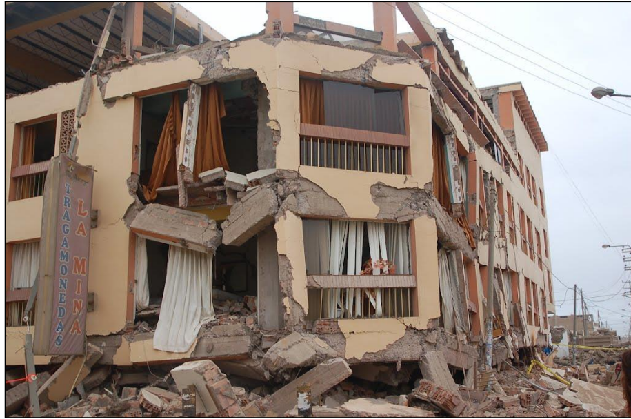
Fig. N° 17: Vivienda colapsada Hotel Abassy por el terremoto en Pisco Perú del año 2007.
