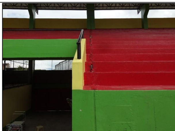
Fotografía N° 03: Se aprecia la junta de dilatación entre columnas de la Tribuna Oriente del estadio “Víctor Montoya Segura”.
