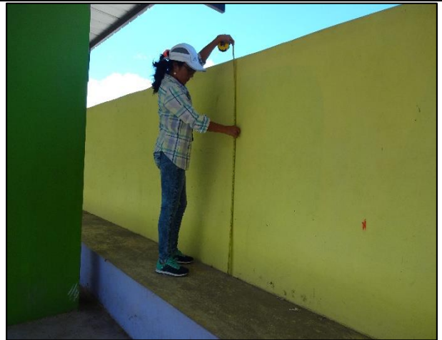
Fotografía N° 10: Toma de medidas de los parapetos de concreto armado de la Tribuna Oriente del estadio "Victor Montoya Segura".
