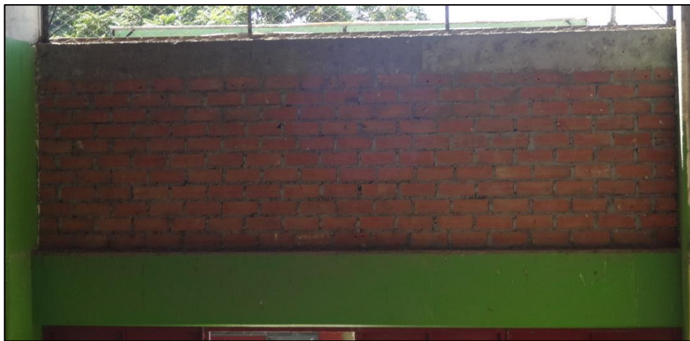
Figura N° 32: Fotografía Parapeto de ladrillo King Kong artesanal.
