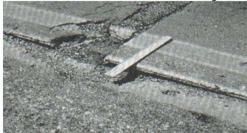
Figura 23. Desnivel carril / berma de baja severidad.
