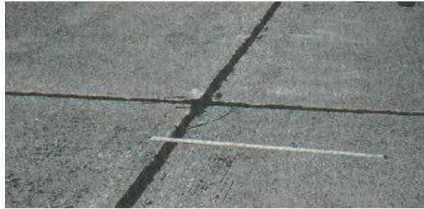
Figura 48. Descascaramiento de esquina de baja severidad.
