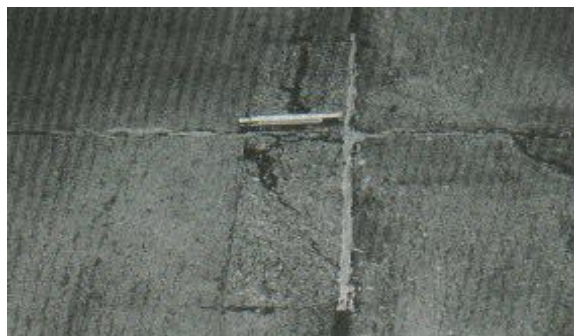
Figura 34. Parche pequeño de alta severidad.
