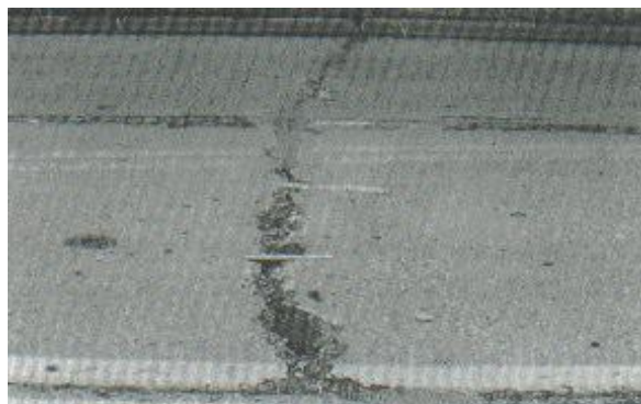
Figura 28. Grietas lineales de alta severidad en losa de concreto simple.
