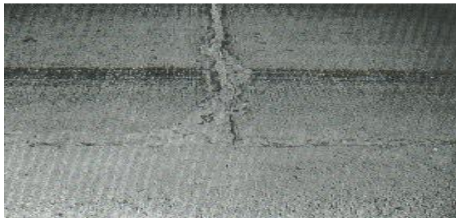
Figura 49. Descascaramiento de esquina de severidad media.
