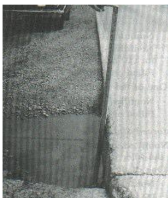
Figura 25. Desnivel carril / berma de alta severidad.
