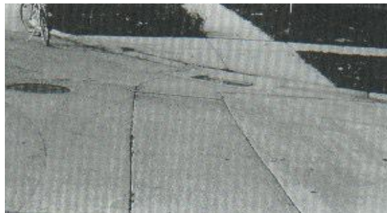
Figura 29. Parche grande y acometidas de servicios públicos de baja severidad.
