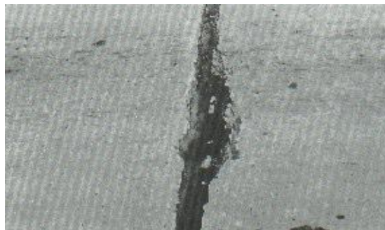
Figura 21. Daño del sello de junta de severidad media.
