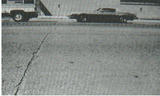
Figura 51. Descascaramiento de junta de baja severidad.
