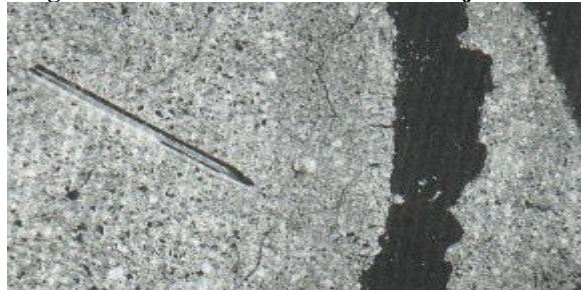
Figura 14. Grieta de durabilidad de baja severidad.
