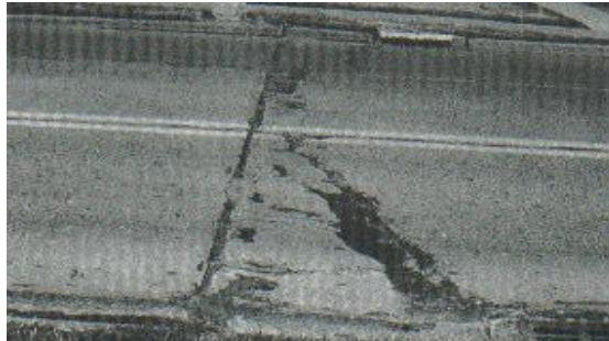
Figura 39. Punzonamiento de severidad media
