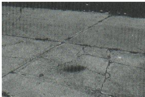
Figura 13. Losa dividida de alta severidad.
