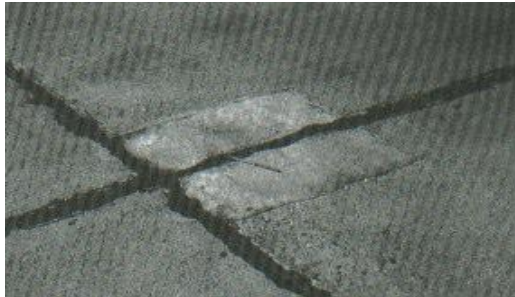
Figura 32. Parche pequeño de baja severidad.
