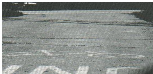
Figura 42. Cruce de vía férrea de severidad media.
