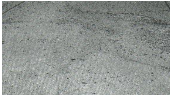
Figura 16. Grieta de durabilidad de alta severidad.
