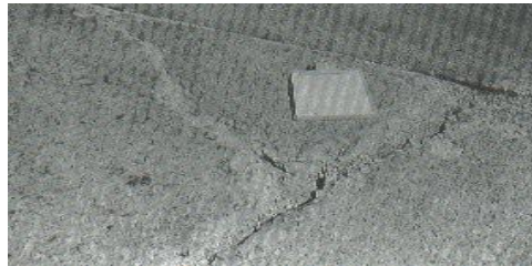
Figura 10. Grieta de esquina de alta severidad.
