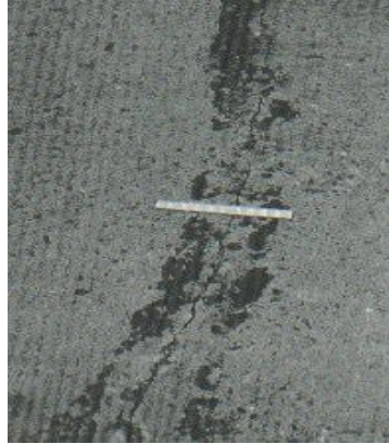
Figura 26. Grietas lineales de baja severidad en losa de concreto simple.
