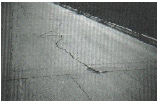
Figura 12. Losa dividida de severidad media.
