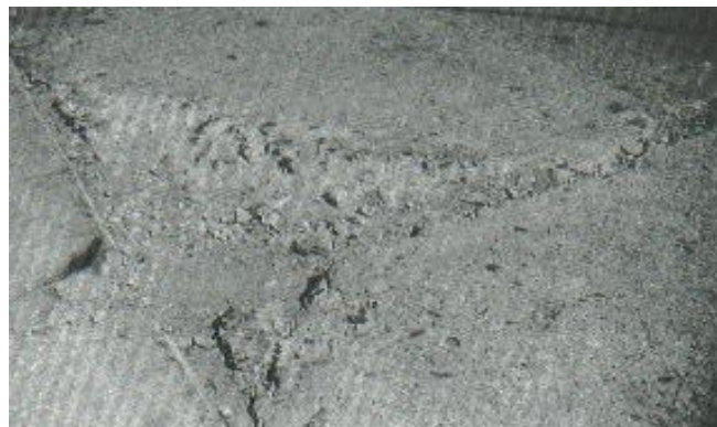
Figura 50. Descascaramiento de esquina de alta severidad
