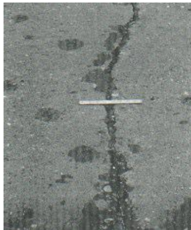
Figura 27. Grietas lineales de severidad media en losa de concreto reforzado.
