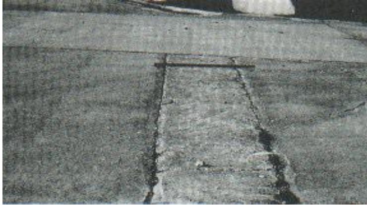
Figura 30. Parche grande y acometida de servicios públicos de severidad media.
