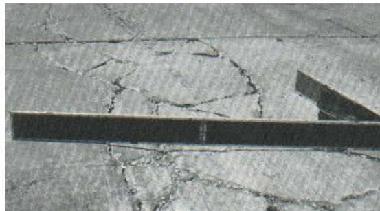
Figura 40. Punzonamiento de alta severidad
