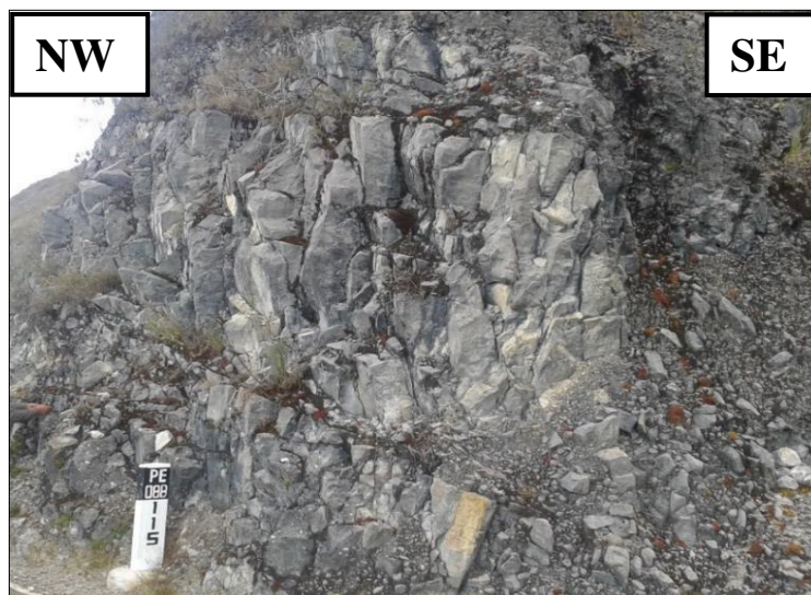
Foto 4.10 Talud con presencia de diaclasas del km 114+900 – km115+100
