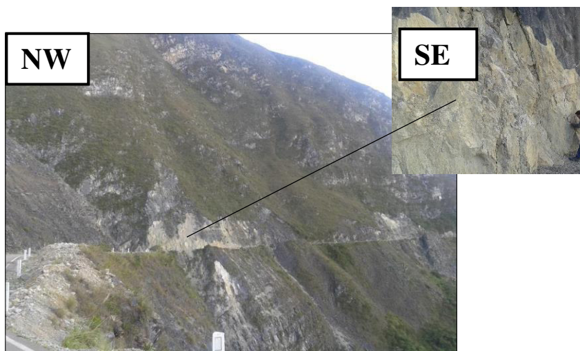
Foto 4.11 Taludes con características inestables del km 120+200 – km 120+500
